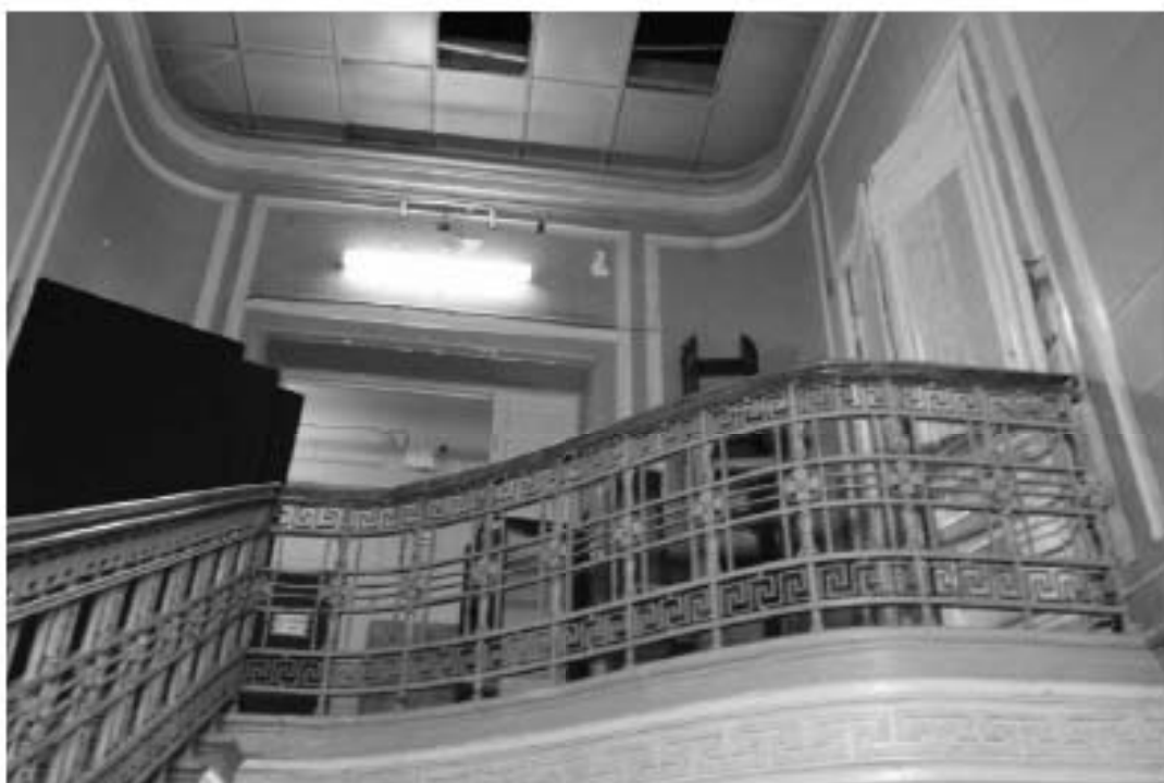
б. «Особняк Безобразовой». Санкт-Петербург, Моховая ул., 34, литера А (Моховая ул., 34). Лицевой корпус. Северная трехмаршевая лестница. Фото: 26.10.2021.
