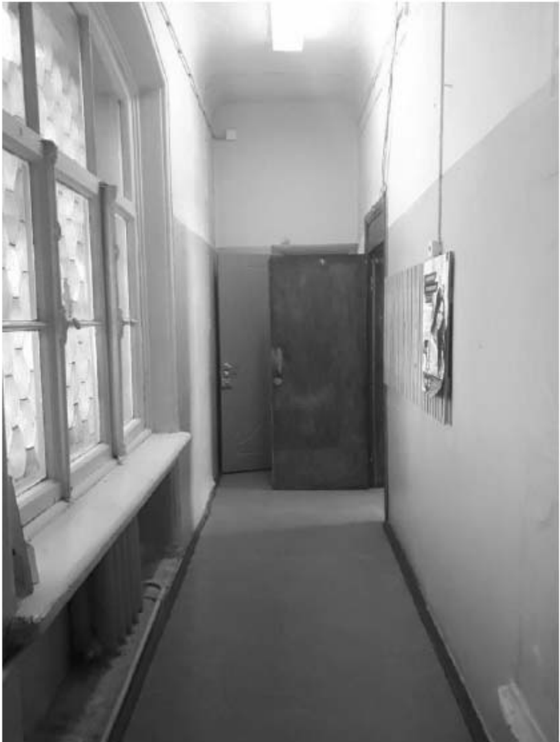
102. «Особняк Безобразовой». Санкт-Петербург, Моховая ул., 34, литера А (Моховая ул., 34). Дворовый корпус. 3-й этаж. Фрагмент помещения 20-Н(7). Фото: 26.10.2021.
