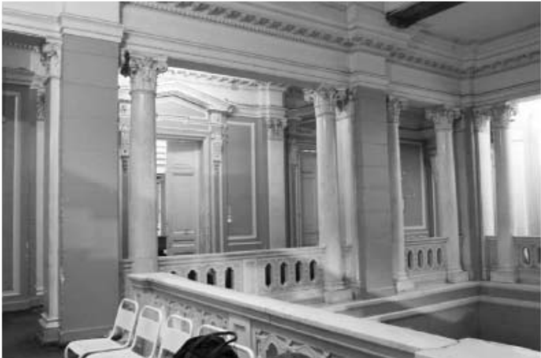
56. «Особняк Безобразовой». Санкт-Петербург, Моховая ул., 34, литера А (Моховая ул., 34). Лицевой корпус. 2-й этаж. Пространство парадной лестницы. Фото: 26.10.2021.
