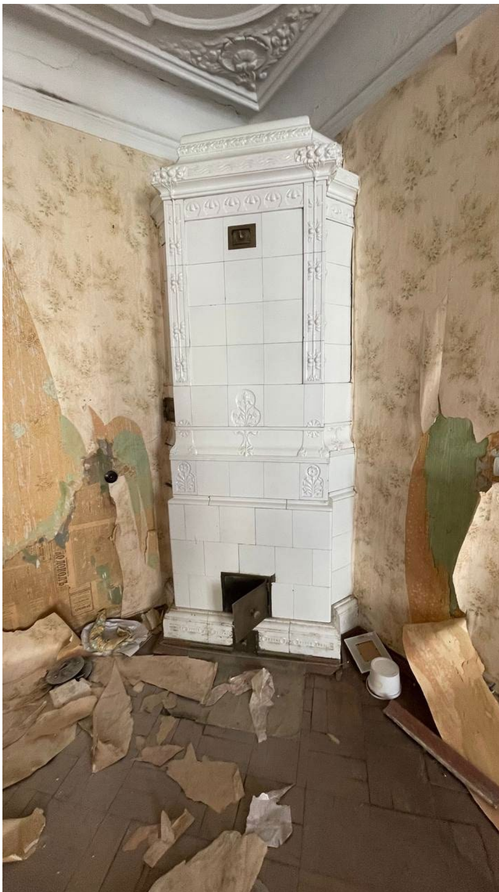
49. Вид на печь (помещение №11);
