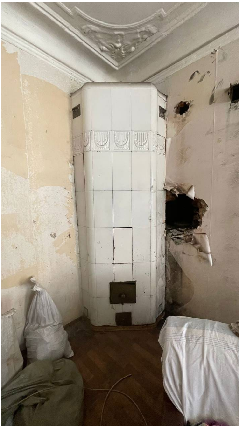
32. Вид на печь (помещение №9);
