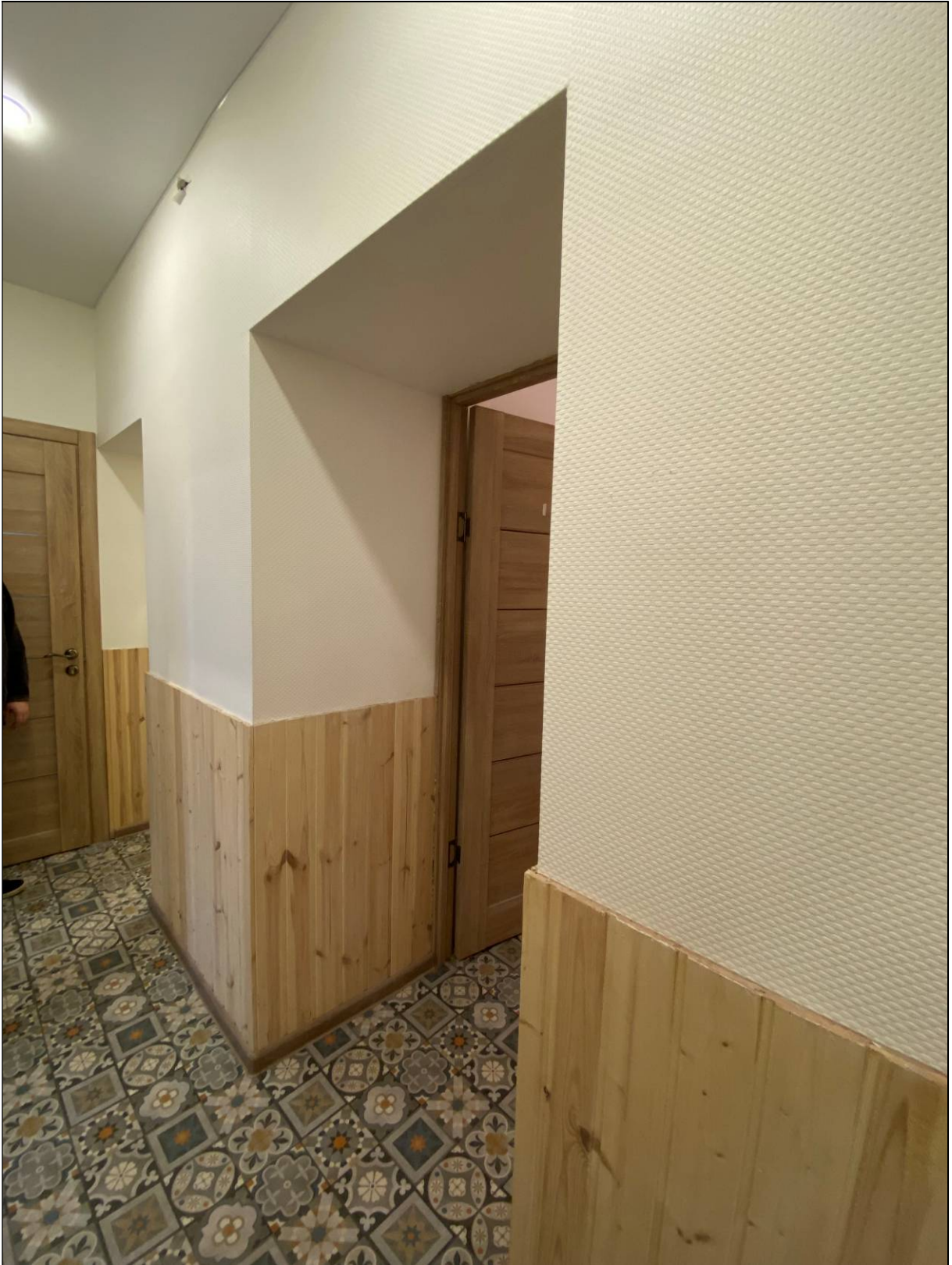
19. Выявленный объект культурного наследия «Жилой дом при заводе Ф.К. Сан-Галли». Квартира № 1. Коридор. Вход в помещение № 4. 02.11.2021 г.
