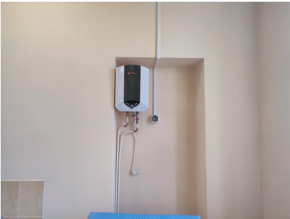
16. Фрагмент пом. 1-Н (62-65) в уровне 2-го этажа. В существующей нише установлен электрический водонагреватель.
