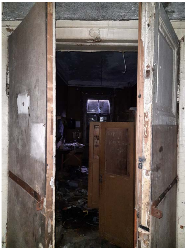
Фото 14. Интерьер здания объекта культурного наследия регионального значения «Удельное сельскохозяйственное училище (комплекс с территорией парком)».
