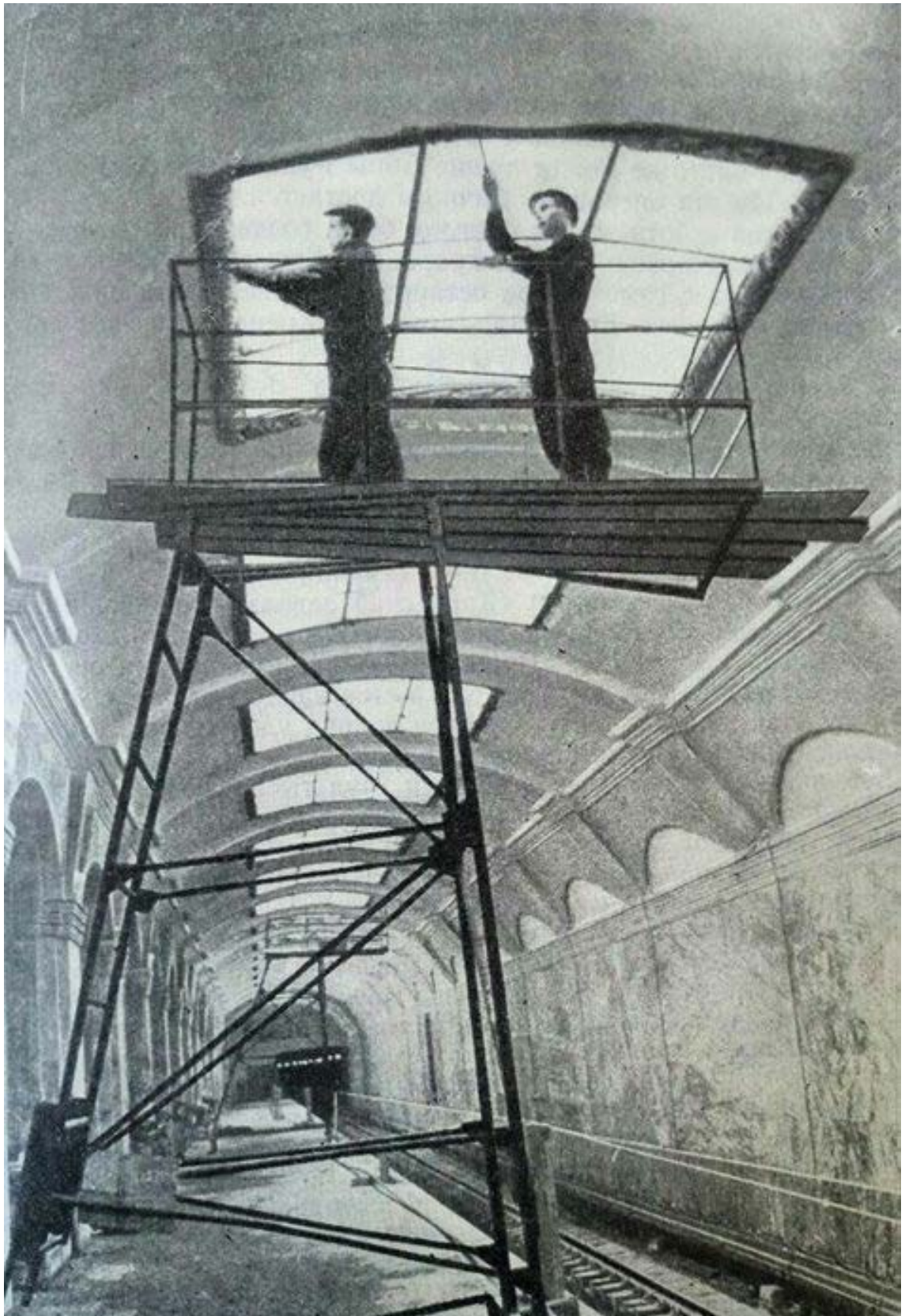
16. Монтаж светильников на станции метро Кировский завод. 1955 г. — «PastVu» – ретро-фотографии стран и городов [Электронный ресурс]. URL: https://pastvu.com/p/842924 .
