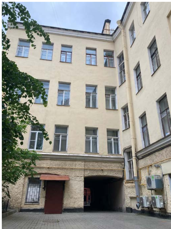
Фото 7. Фрагмент дворового фасада выявленного объекта культурного наследия «Дом А.Ф. Девриена», воротный проезд
