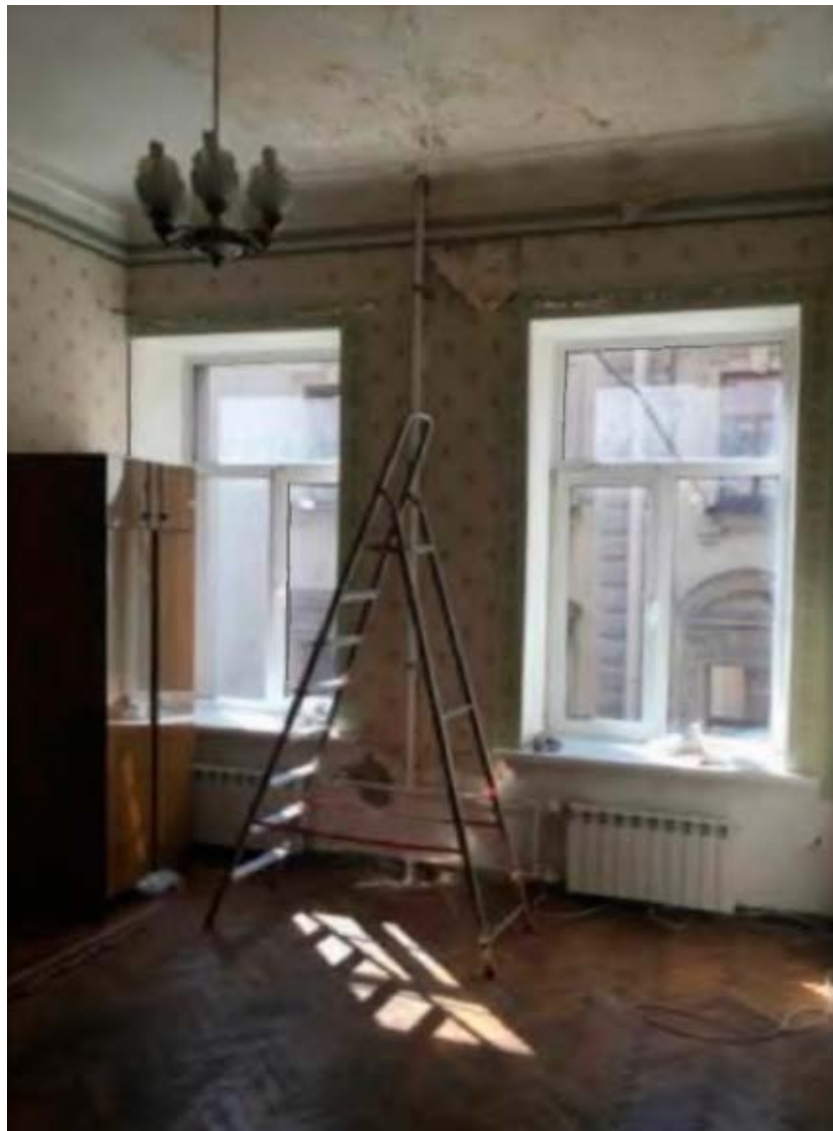
7. Помещение №4 квартиры №25 в уровне 5-го этажа выявленного объекта культурного наследия «Дом С.Д. Шереметева», расположенного по адресу: г. Санкт-Петербург, Литейный проспект, дом 51, литера А. 22.12.2021.
