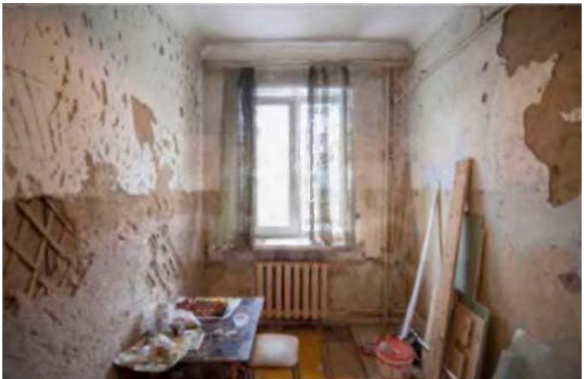
6. Помещение №3 квартиры №25 в уровне 5-го этажа выявленного объекта культурного наследия «Дом С.Д. Шереметева», расположенного по адресу: г. Санкт-Петербург, Литейный проспект, дом 51, литера А. 22.12.2021.
