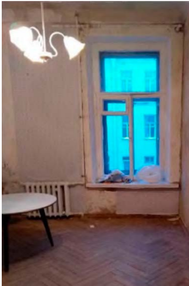
3. Помещение №3 квартиры №81 в уровне 1-го этажа выявленного объекта культурного наследия «Дом С.Д. Шереметева», расположенного по адресу: г. Санкт-Петербург, Литейный проспект, дом 51, литера А. 22.12.2021.
