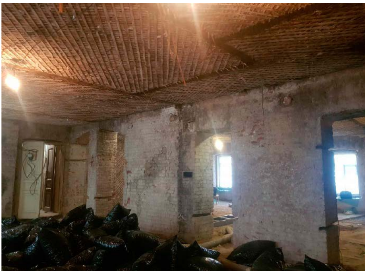
8. Помещение №5 квартиры №21 в уровне 3-го этажа выявленного объекта культурного наследия «Дом И.И. Антонова», расположенного по адресу: г. Санкт-Петербург, Литейный пр., д. 61, лит. А. 20.12.2020.
