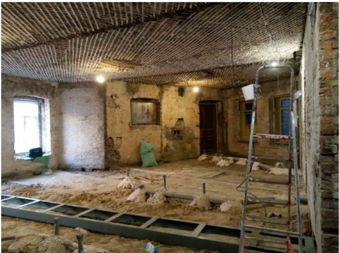
4. Помещение №10 квартиры №21 в уровне 3-го этажа выявленного объекта культурного наследия «Дом И.И. Антонова», расположенного по адресу: г. Санкт-Петербург, Литейный пр., д. 61, лит. А. 20.12.2020.
