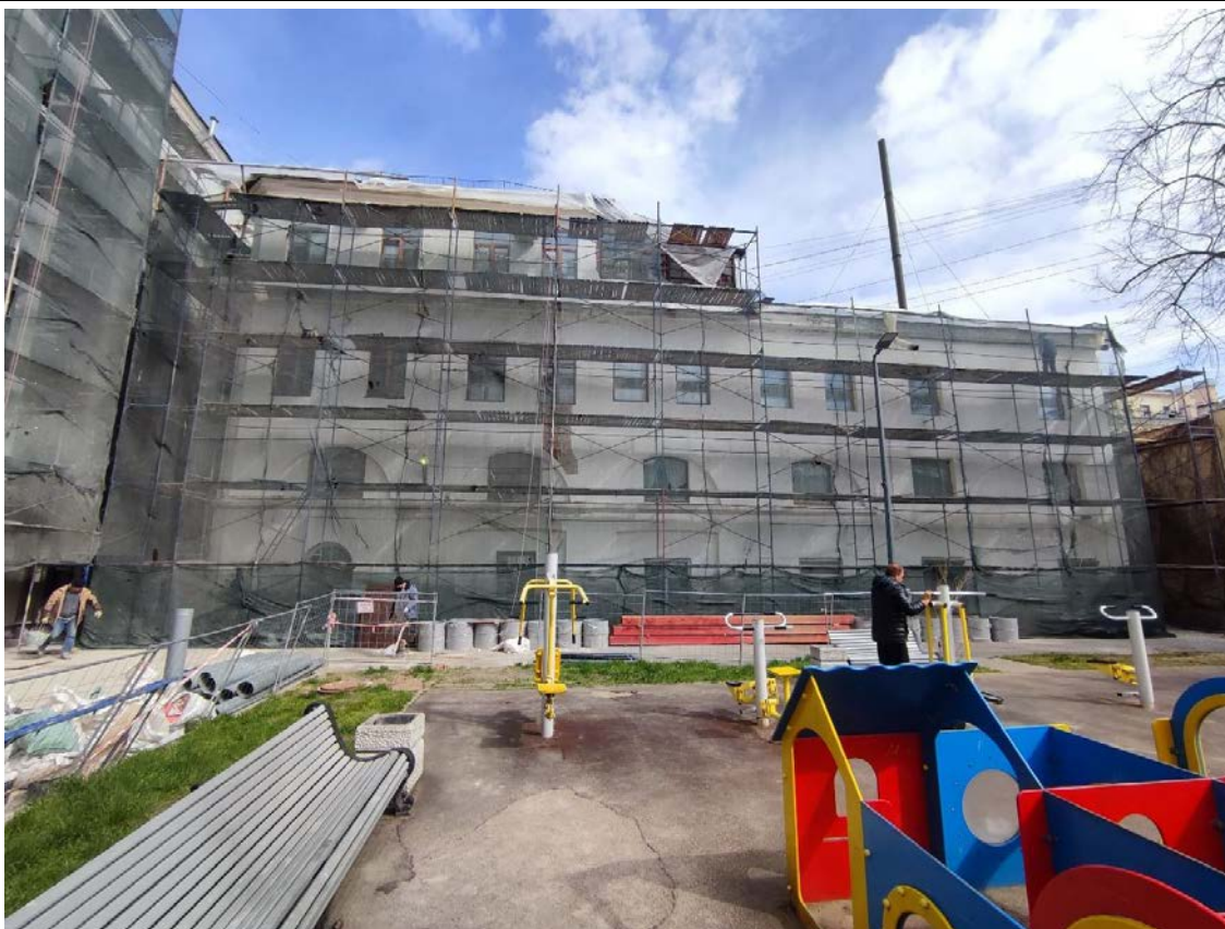
7. Общий вид западного фасада восточного дворового флигеля объекта культурного наследия «Особняк с примыкающими дворовыми флигелями».
