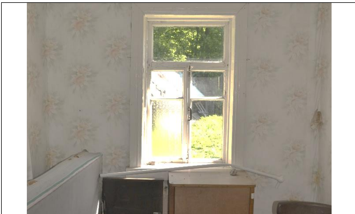
24. ОКН «Парк с озерами: Большое (Осинорощинское), Глухое, Малое и Среднее (Дворцовое)», входящего в состав объекта культурного наследия регионального значения «Усадьба Лопухиной Е.И. (Левашовых, Вяземских) «Осиновая Роща». Помещение 5. Общий вид. Дата съёмки: 20.09.2021 г.
