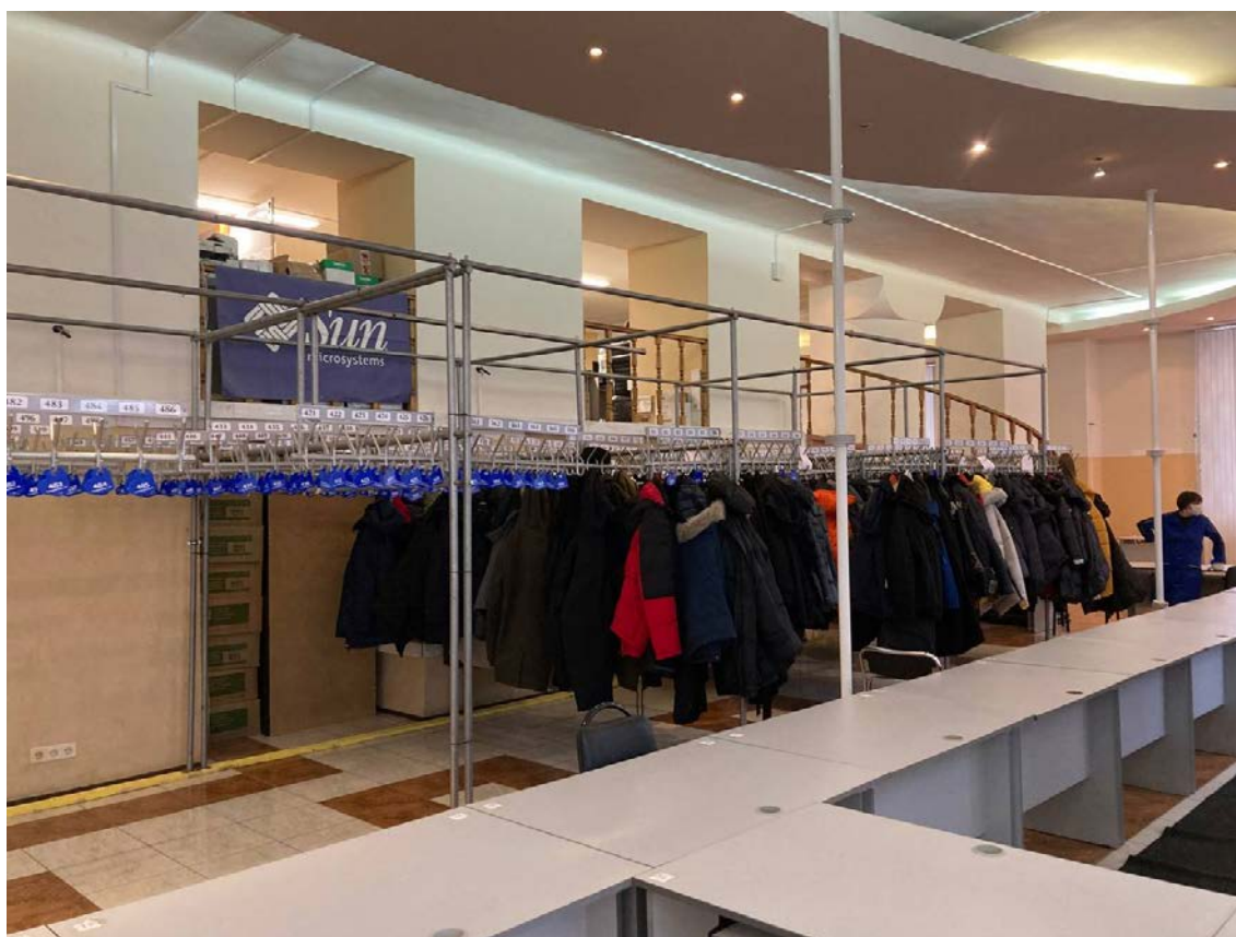
Фото №48. Основное помещение. Проемы в стене по центру рассматриваемого помещения. Конструкции подвесного потолка из ГКЛ, существующий потолок. Грязь, трещины.
