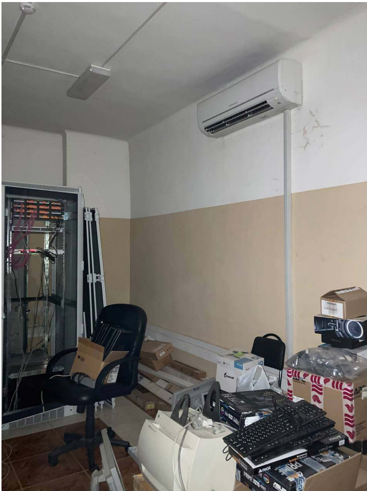
Фото №12. Серверная. Физический износ, грязь, трещины, отслоения краски.
