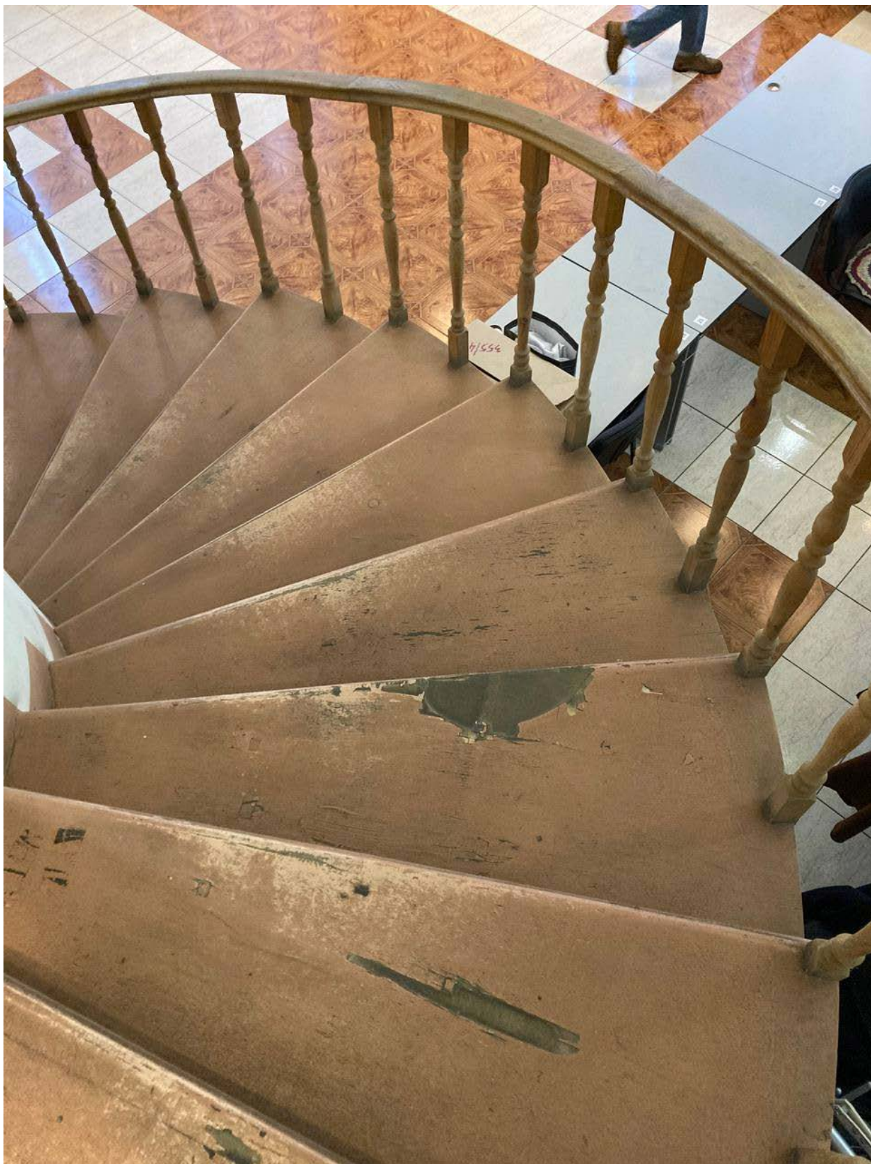
Фото №20. Ступени винтовой лестницы, ведущей на конструкции встроенной антресоли. Сколы, фрагментарное отсутствие покрытия, трещины, потертости, грязь.
