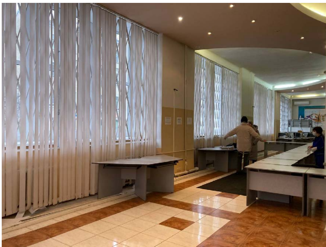
Фото №31. Основное помещение. Конструкции подвесного потолка из ГКЛ, существующий потолок, оконные проемы ОК-2. Грязь, трещины.
