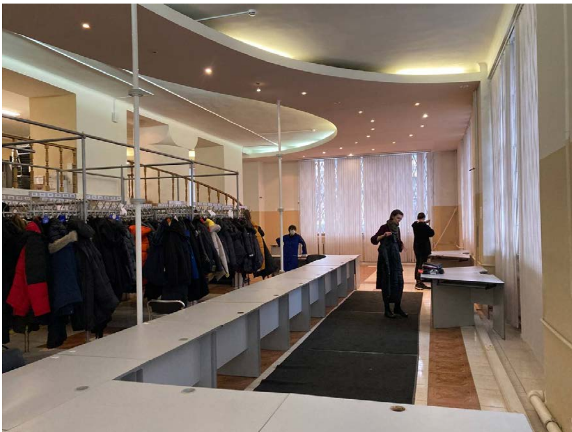
Фото №34. Основное помещение. Конструкции подвесного потолка из ГКЛ, существующий потолок, оконные проемы ОК-2. Грязь, трещины.
