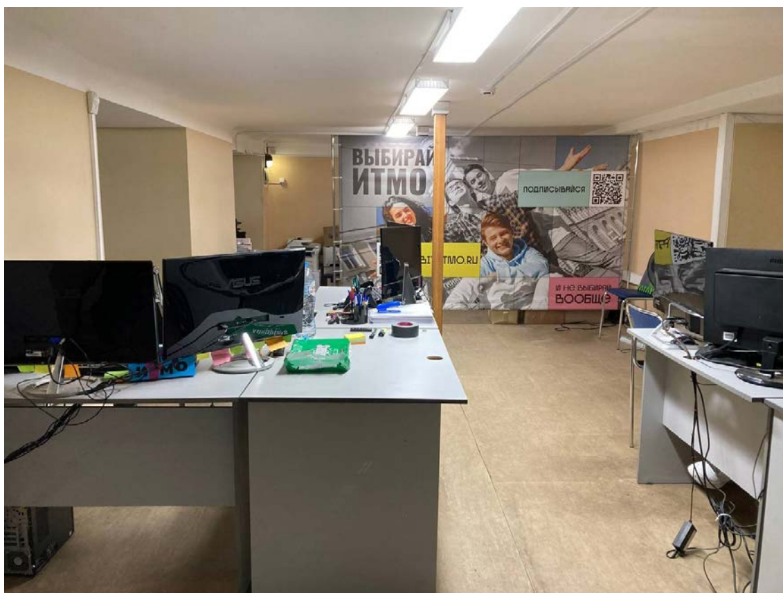
Фото №25. Конструкции встроенной антресоли. Физический износ, грязь.
