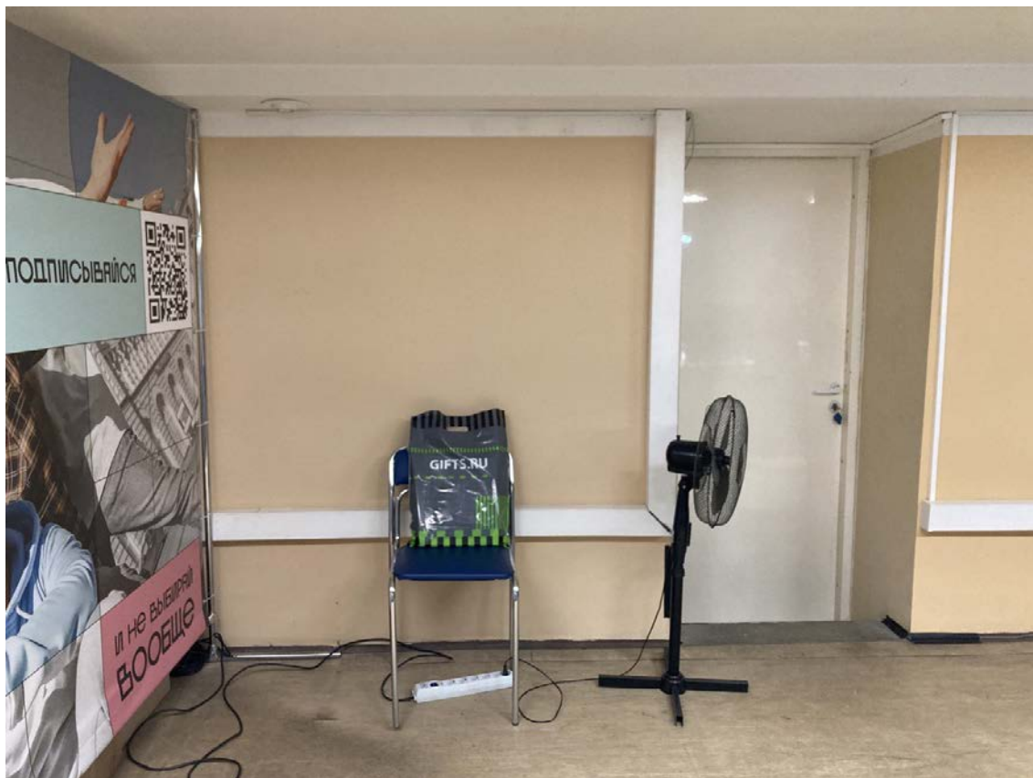
Фото №24. Конструкции встроенной антресоли. Дверной проем с выходом на лестничную площадку. Грязь, потертости, общий физический износ.
