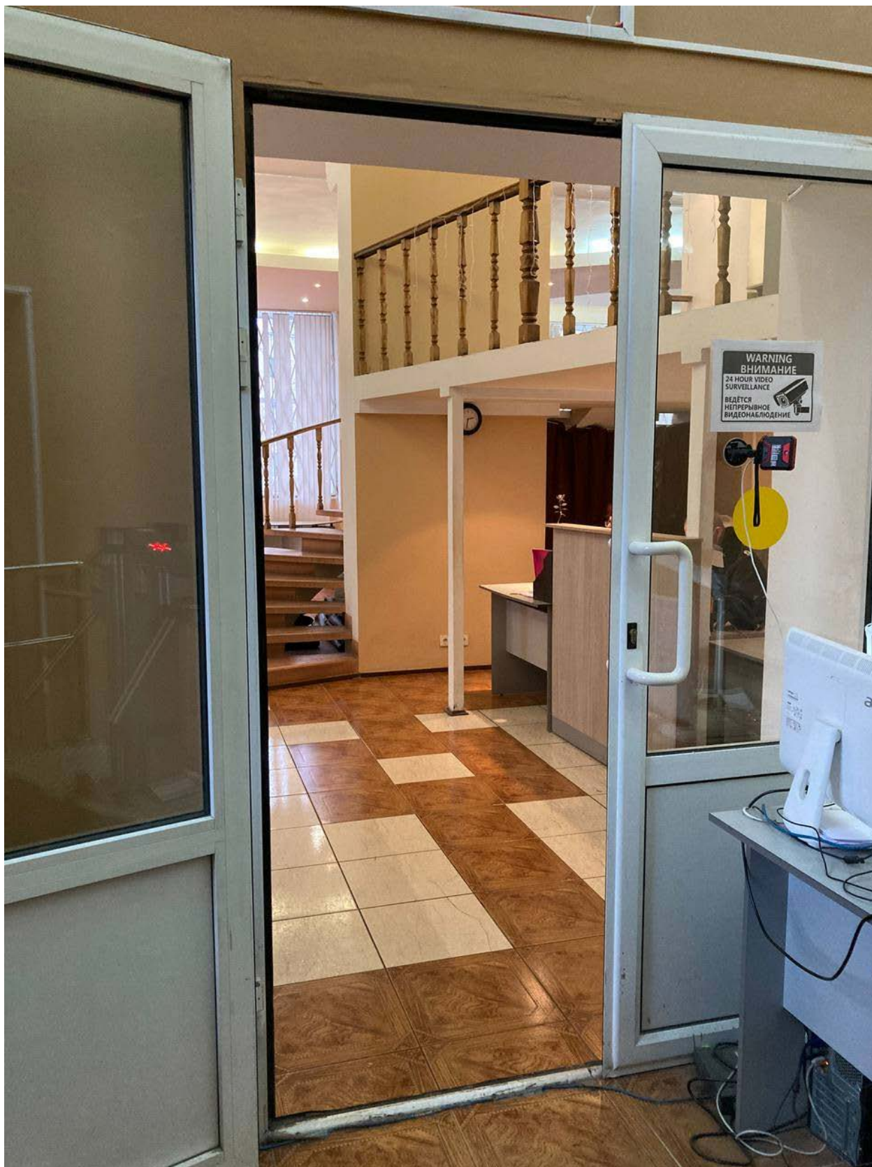
Фото №1. Входной портал и современное металлопластиковое дверное заполнение со стороны главного входа со стороны Кронверкского проспекта. Присутствует физический износ, загрязнения. Современная плитка – физический износ, загрязнения, сколы, трещины.
