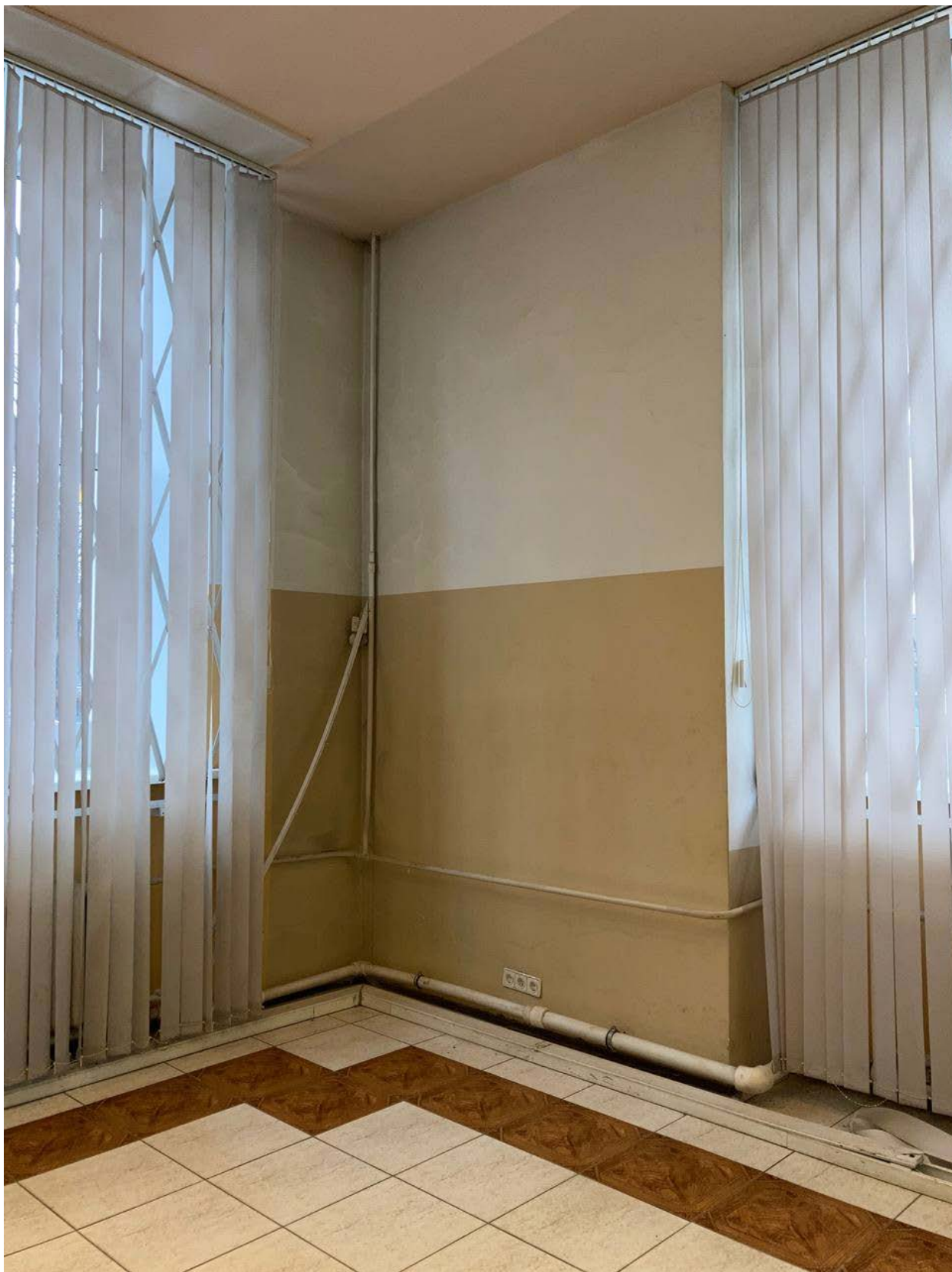
Фото №36. Основное помещение. Угол между стенами фасадов по Кронверкскому проспекту и Саблинской улицей. Фрагменты оконных проемов ОК-2. Физический износ, грязь, трещины, отслоения краски.
