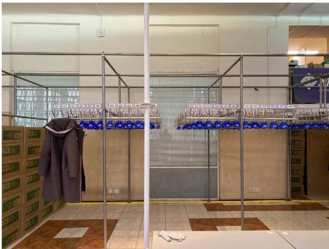
Фото №47. Основное помещение. Заполнения проемов стеклянными перегородками в помещении серверной. Грязь, трещины.
