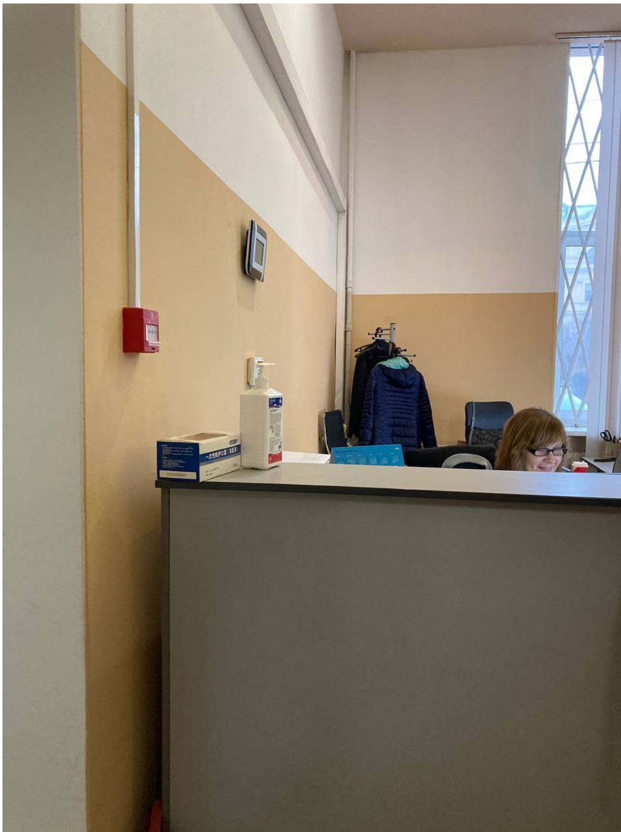
Фото №8. Стена слева от главного входа в обследуемое помещение, часть стены по главному фасаду по Кронверкскому проспекту, оконный проем ОК-1. Физический износ, грязь, трещины.
