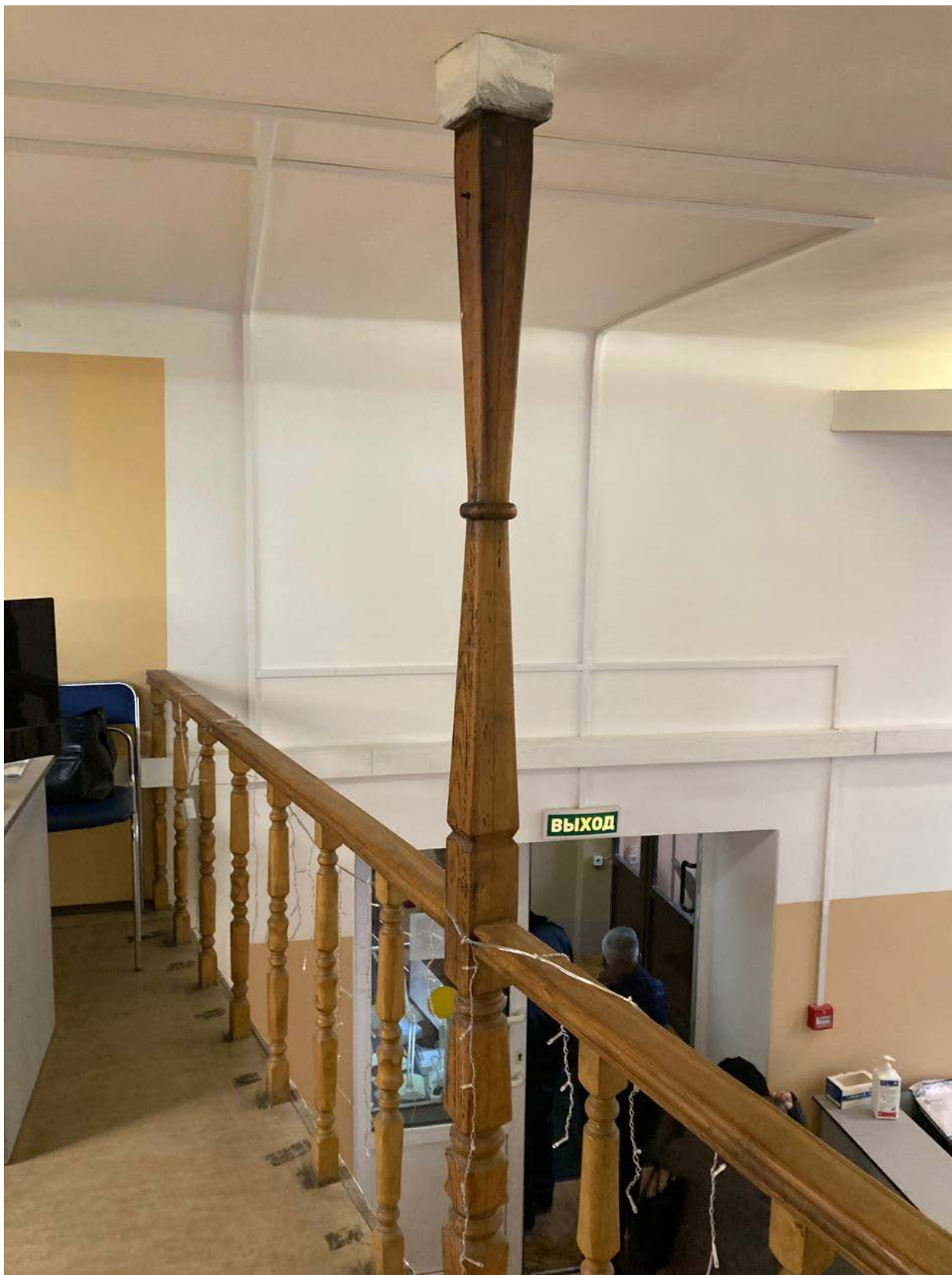
Фото №23. Ограждение конструкций встроенной антресоли из деревянных балясин. Стена главного входа в обследуемое помещение. Грязь, потеки, физический износ.
