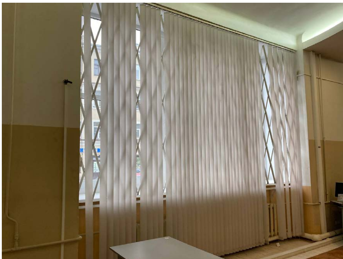
Фото №41. Основное помещение. Стена фасада по Саблинской улице. Оконный проем ОК-2. Грязь, трещины.
