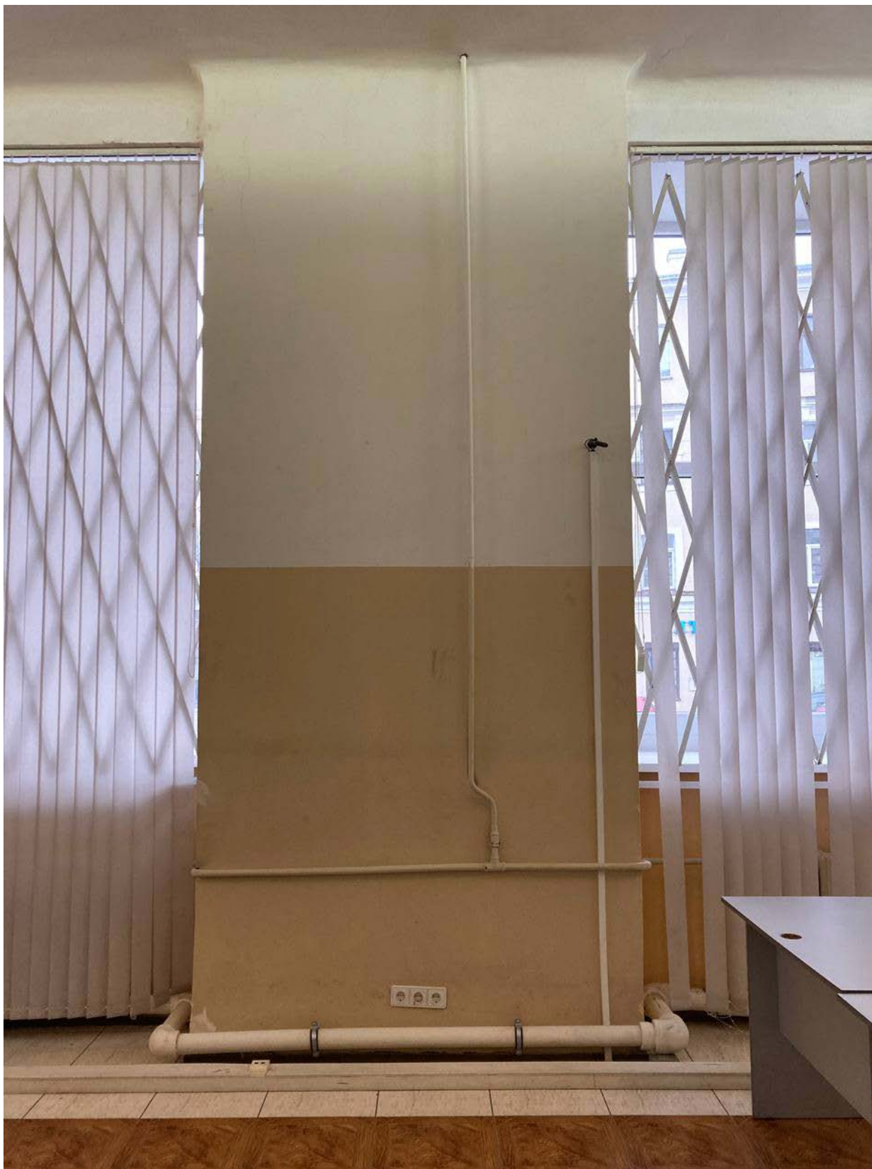
Фото №40. Основное помещение. Стена фасада по Саблинской улице. Фрагменты оконных проемов ОК-2. Грязь, трещины, отслоения краски, физический износ.
