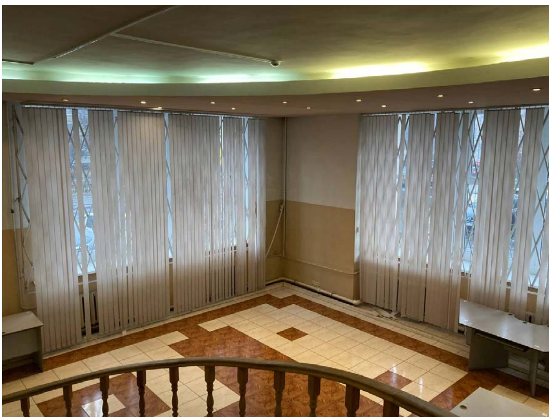
Фото №22. Вид с конструкций встроенной антресоли. Фрагмент стены по главному фасаду со стороны Кронверкского проспекта, фрагмент стены по Саблинской улице, оконные проемы ОК-2. Грязь, трещины.
