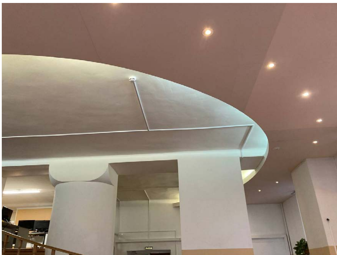
Фото №38.. Основное помещение. Конструкции подвесного потолка из ГКЛ, существующий потолок. Трещины, отслоения краски.
