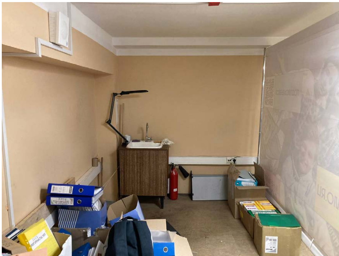
Фото №30. Конструкции встроенной антресоли. Грязь, физический износ.
