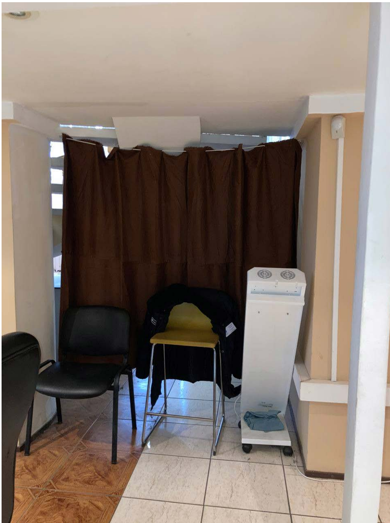
Фото №15. Проем в стене, фрагмент низа косяка лестницы, низ конструкций встроенной антресоли. Потертости, грязь, трещины.
