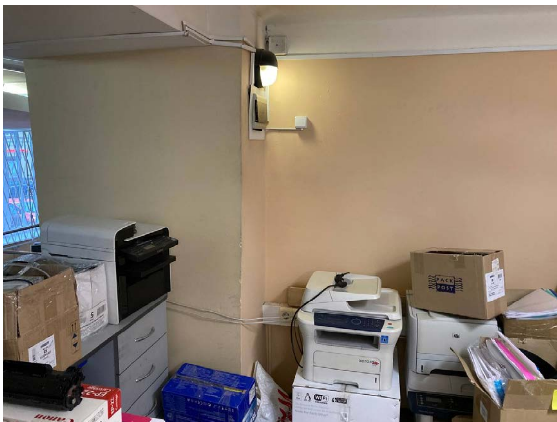
Фото №29. Конструкции встроенной антресоли. Грязь, физический износ.
