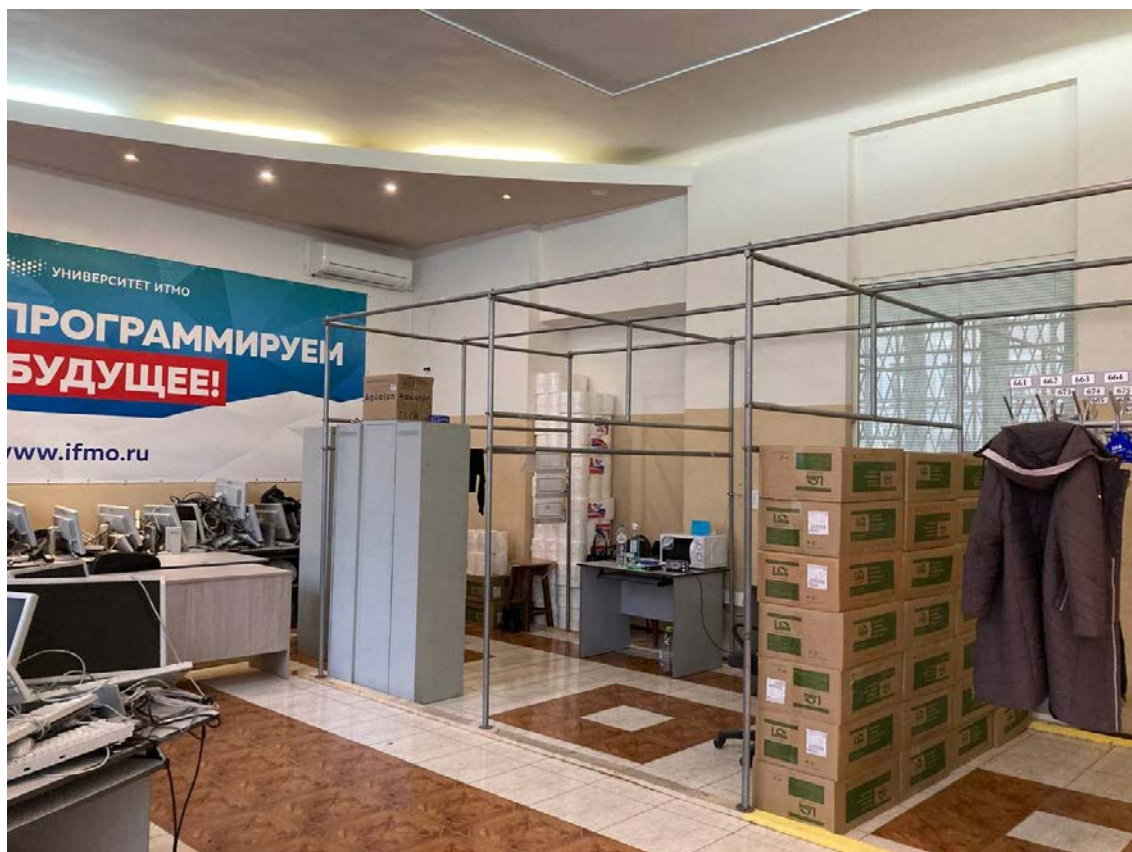
Фото №46. Основное помещение. Общий вид. Конструкции подвесного потолка из ГКЛ, существующий потолок. Трещины, отслоения краски.
