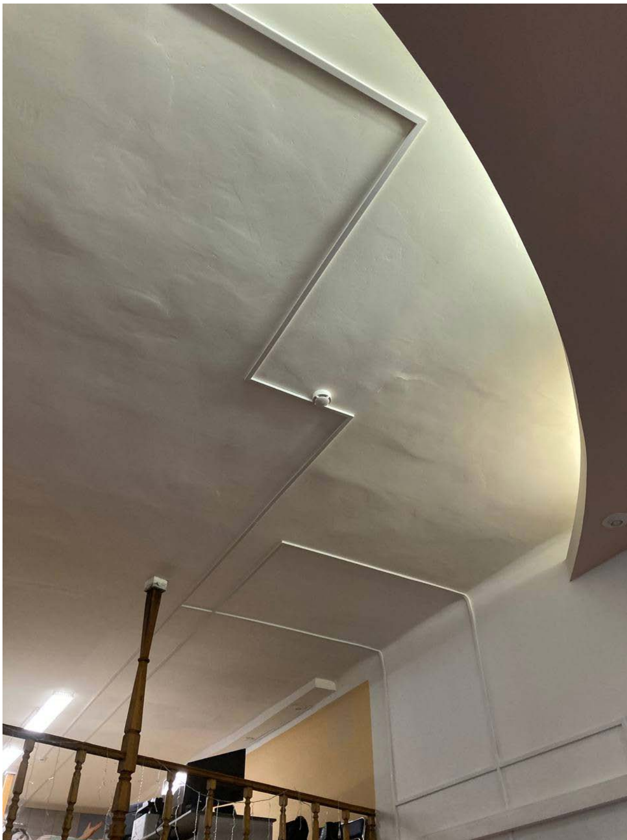
Фото №16. Потолок входной зоны обследуемого помещения, конструкции подвесного потолка из ГКЛ. Отслоения краски, трещины, грязь, потеки.
