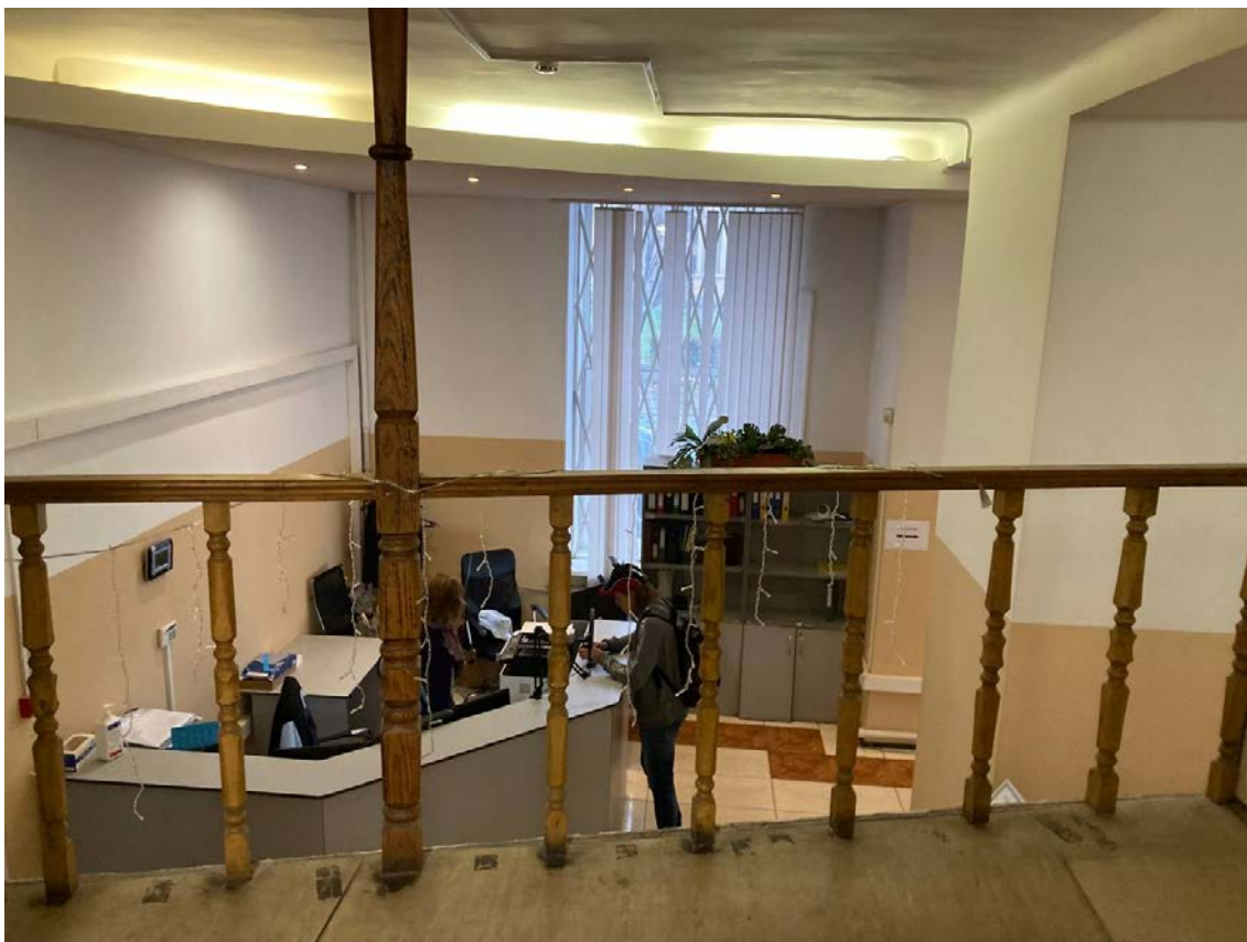
Фото №21. Ограждение конструкций встроенной антресоли, покрытие. Конструкции подвесного потолка из ГКЛ. Грязь, физический износ.
