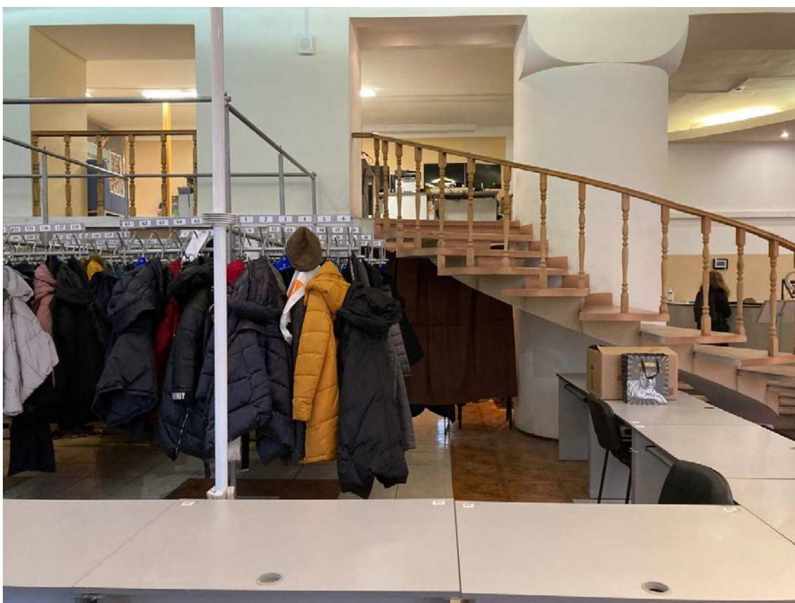
Фото №35. Основное помещение. Конструкции встроенной антресоли, винтовая лестница. Ограждение из деревянных балясин, фрагмент центральной стены с проемами. Грязь, трещины.
