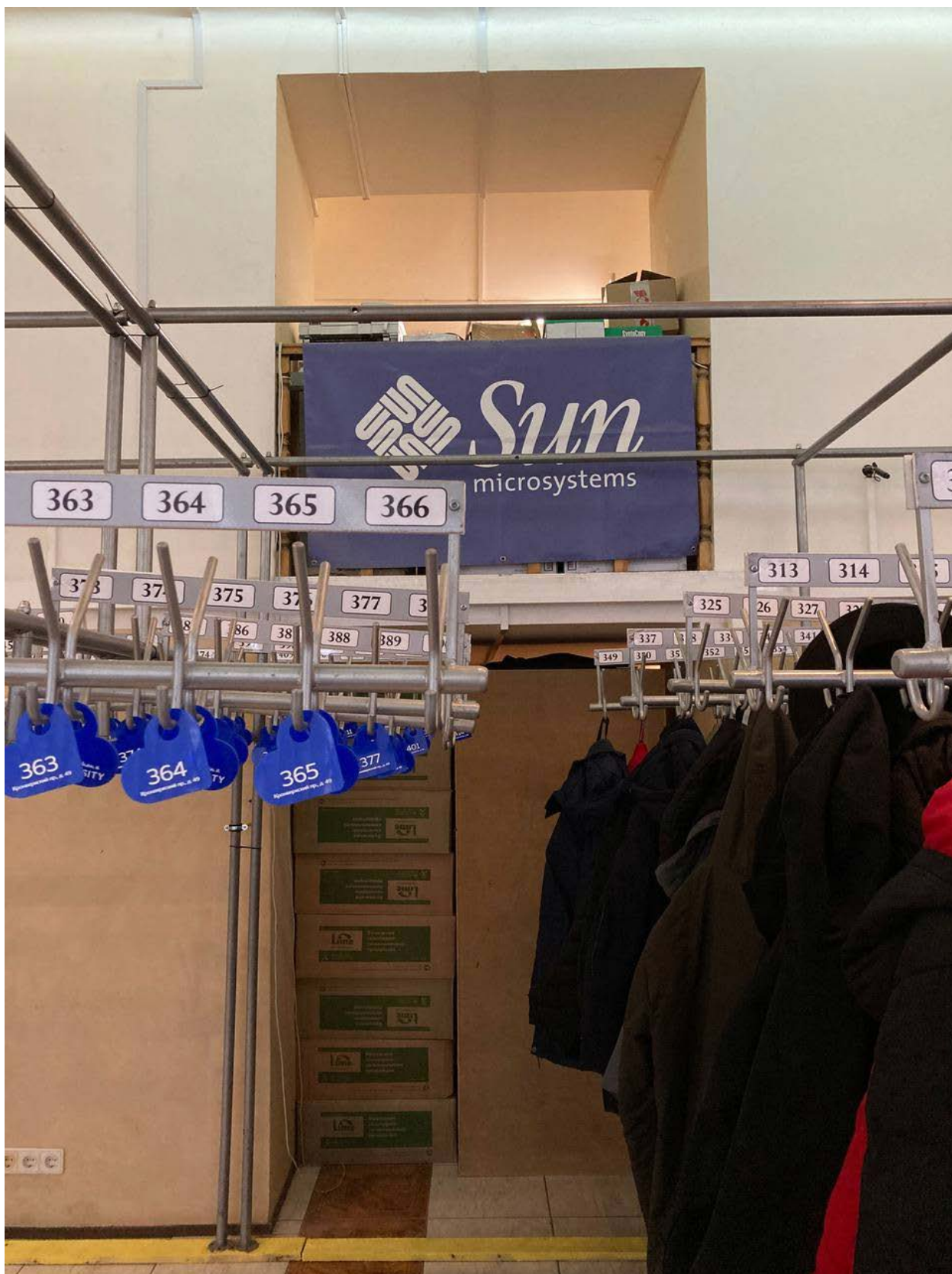
Фото №32. Конструкции встроенной антресоли, проем. Грязь, физический износ, трещины.
