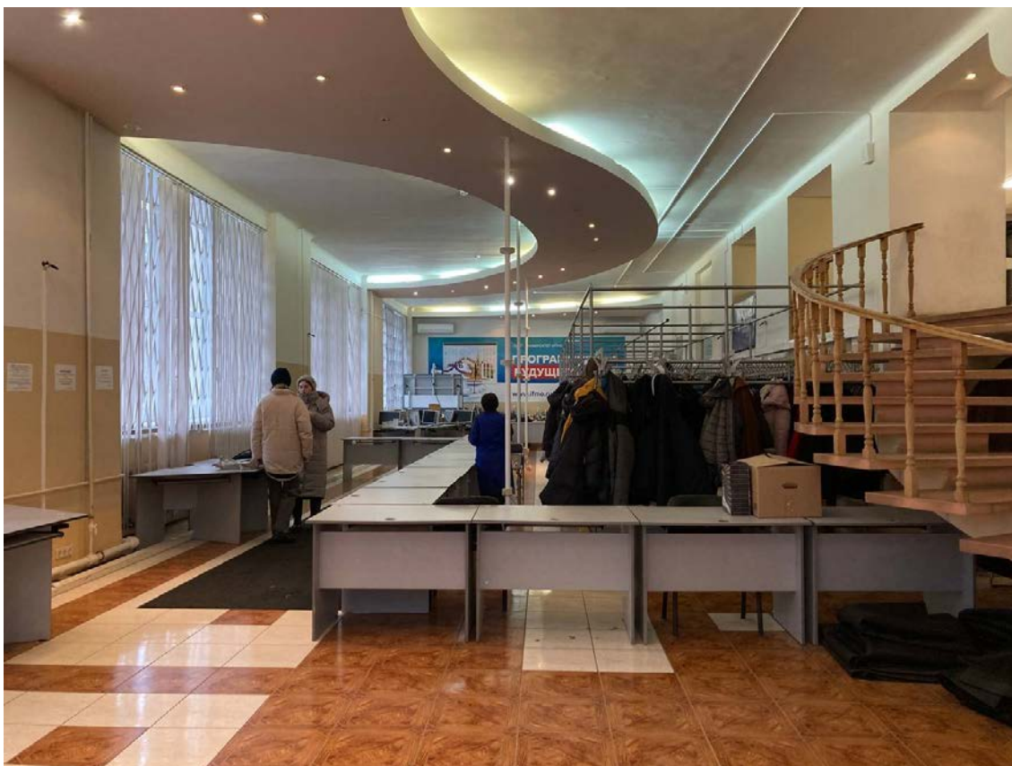
Фото №18. Общий ракурс главного зала обследуемого помещения. Конструкции подвесного потолка из ГКЛ, существующий потолок. Грязь, трещины.
