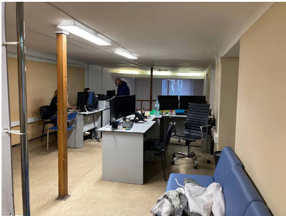
Фото №28. Конструкции встроенной антресоли. Грязь, физический износ.
