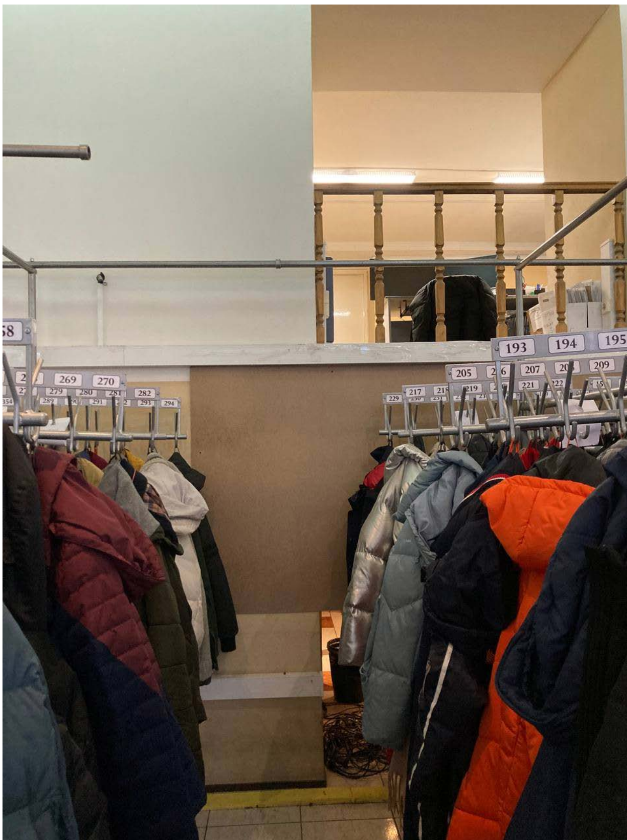
Фото №33. Конструкции встроенной антресоли, проем. Ограждение из деревянных балясин. Грязь, физический износ.
