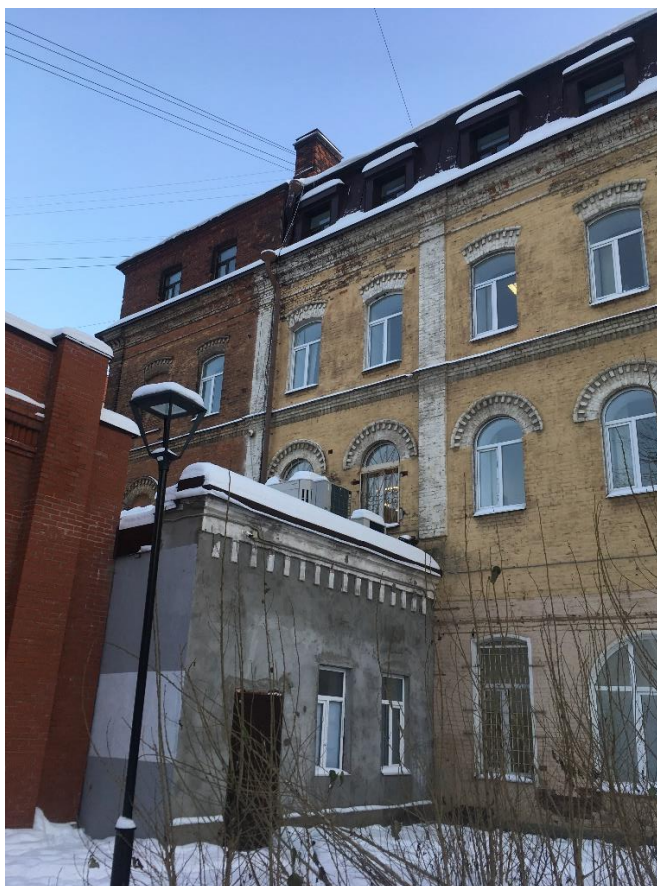
Фото 9. Фрагмент дворового фасада по оси «Е» в осях «8-7». Окраска кирпичной кладки. Деструкция окрасочного слоя.
