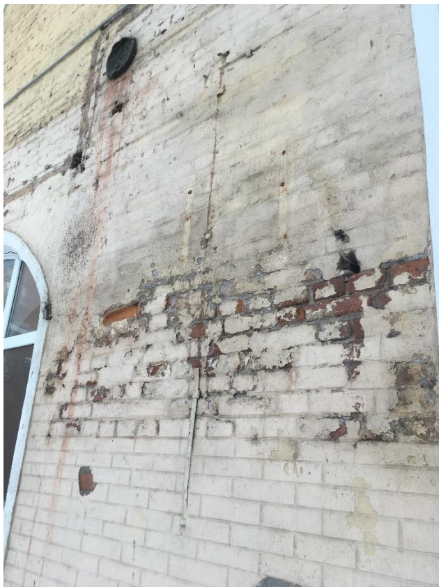
Фото 15. Фрагмент стены м/о «5-4» в уровне 1-го этажа по оси «Е». Деструкция позднего окрасочного слоя кладки. Биопоражения кладки. Следы крепления инженерных сетей.
