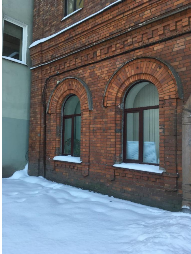
Фото 3. Фрагмент лицевого фасада по Московскому проспекту по оси «А» в осях «1-2». Локальные докомпоновки кладки. Загрязнение цокольной части.
