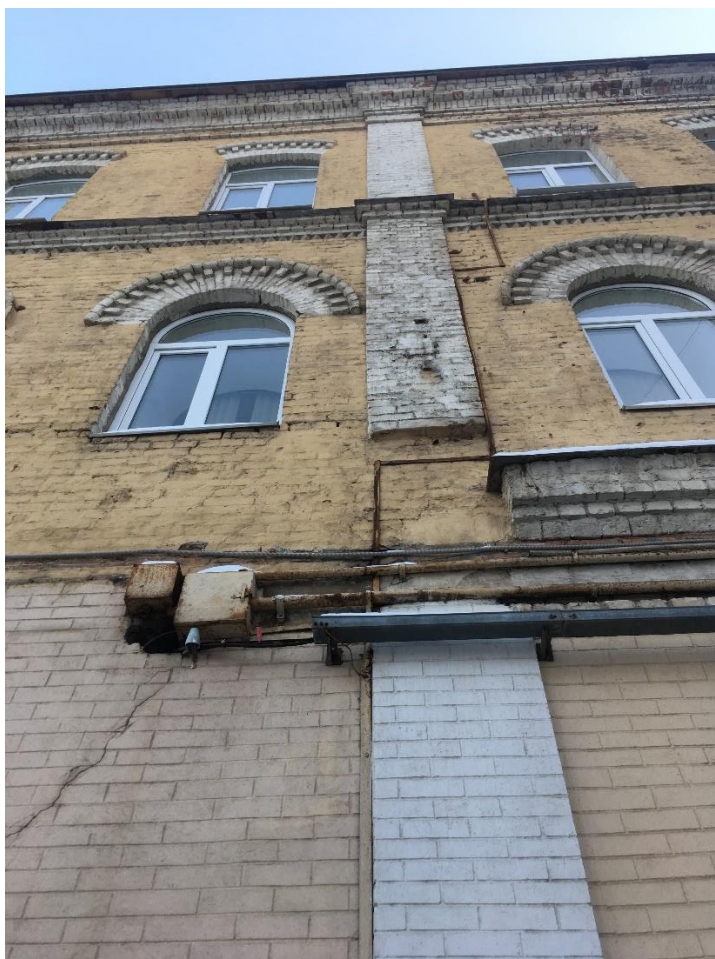
Фото 17. Фрагмент стены по оси «З» в уровне 1-го этажа по оси «Е». Утраты межэтажного пояса и лопатки. Деструкция позднего окрасочного слоя.
