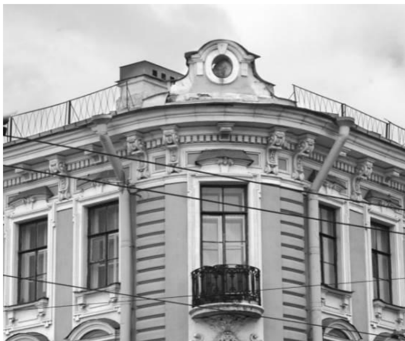
7. Дом, в котором жили: Попов Александр Степанович в 1901-1902 гг., Козлов Петр Кузьмич в 1903-1905 гг., Дубовский Николай Никонорович в 1894-1896 гг. и Введенский Николай Евгеньевич в 1915-1917 гг. Фрагмент лицевого фасада. Фото 2008 г. (14).
