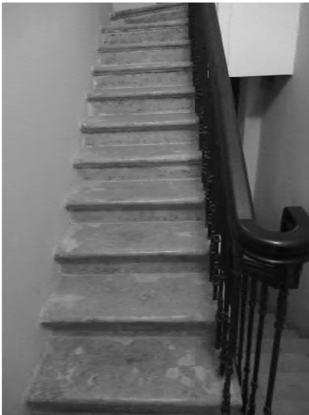
24. ОКН "Усадьба Военного министра", расположенный по адресу: г. Санкт-Петербург, ул. Садовая, д. 4, лит. А. Особняк. Историческая служебная лестница Л-2. Дата фотофиксации: 17.11.2021
