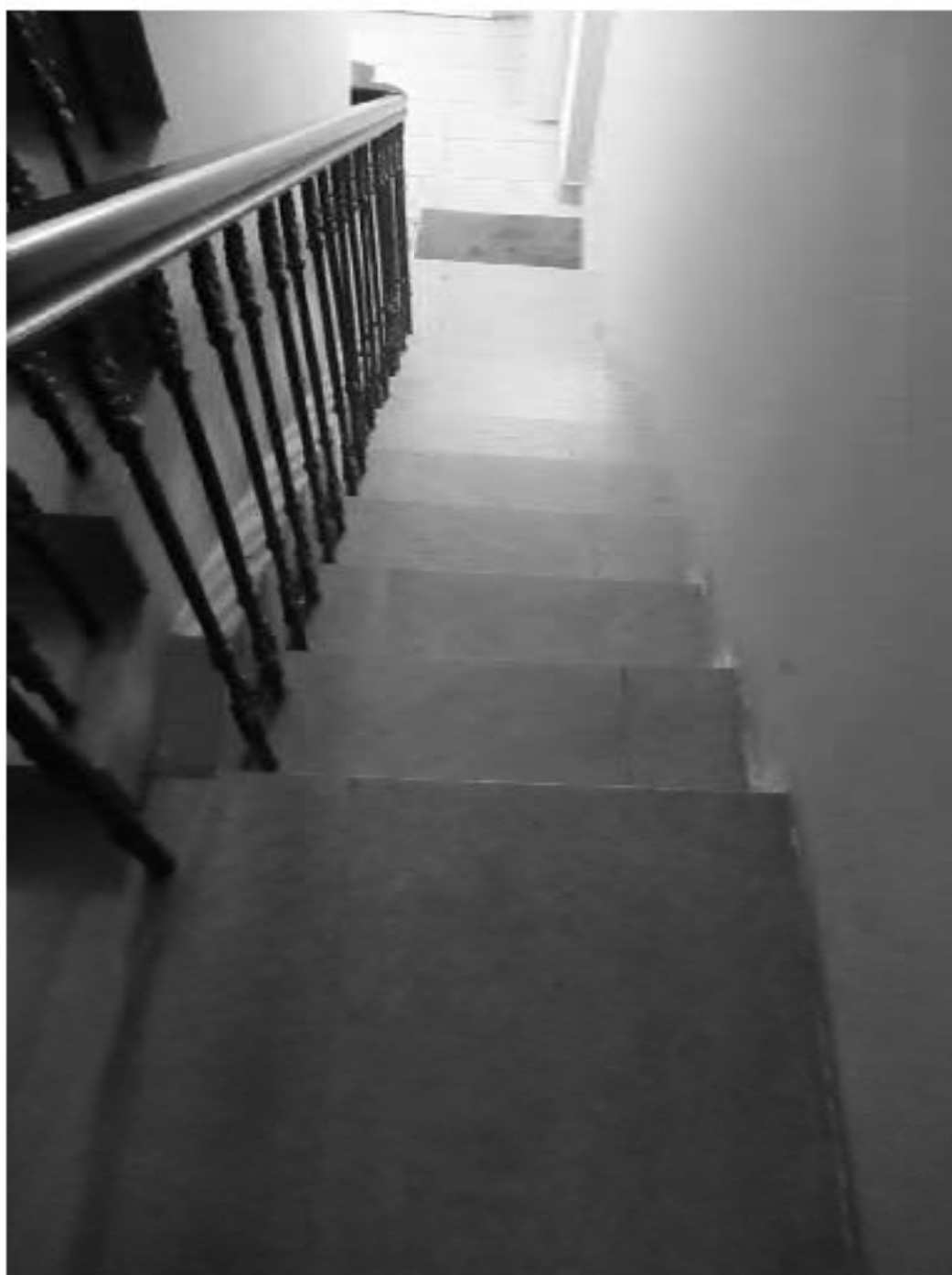
29. ОКН "Усадьба Военного министра", расположенный по адресу: г. Санкт-Петербург, ул. Садовая, д. 4, лит. А. Особняк. Историческая служебная лестница Л-2. Дата фотофиксации: 17.11.2021
