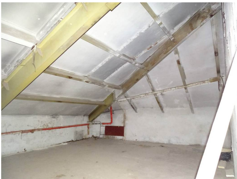
Илл. 30. Технический этаж. Съемка 22.04.21 г. Трушковский В.Э.
