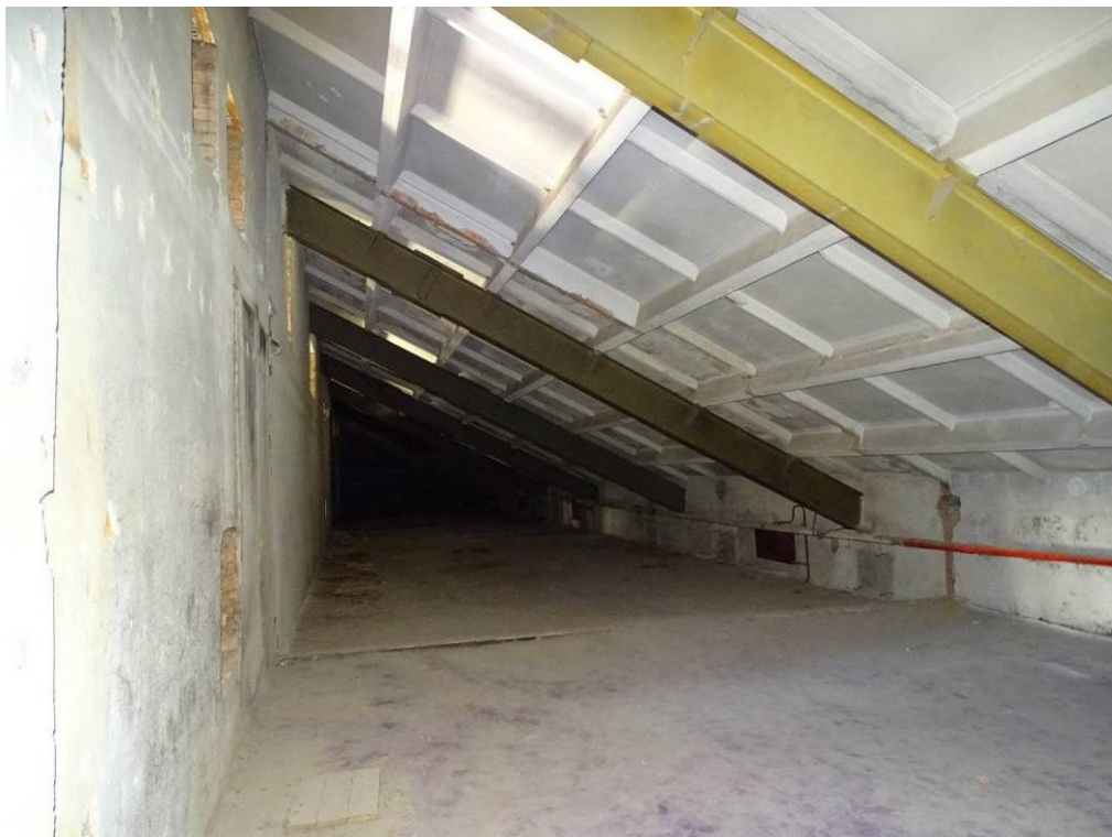
Илл. 31. Технический этаж. Съемка 22.04.21 г. Трушковский В.Э.
