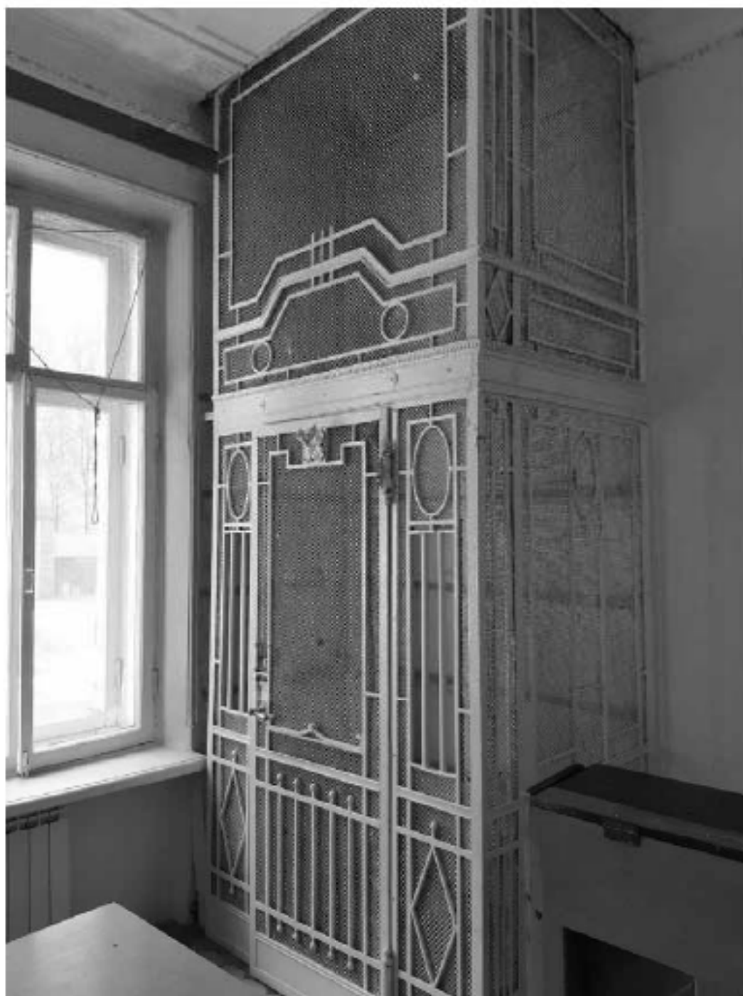
Фото 3. ОКН «Лечебница А.Л. Эбермана». Главное здание по адресу: СПб, г. Пушкин, Московское шоссе, д. 7. Помещение 1.1. Металлическое орнаментированное в характере модерна ограждение лифтовой шахты. Дата съёмки: 10.05.2022.
