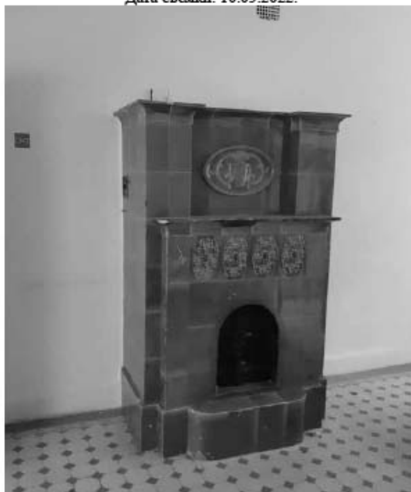
Фото 2. ОКН «Лечебница А.Л. Эбермана». Главное здание по адресу: СПб, г. Пушкин, Московское шоссе, д. 7. Помещение 1.1. Печь. Дата съёмки: 10.05.2022.
