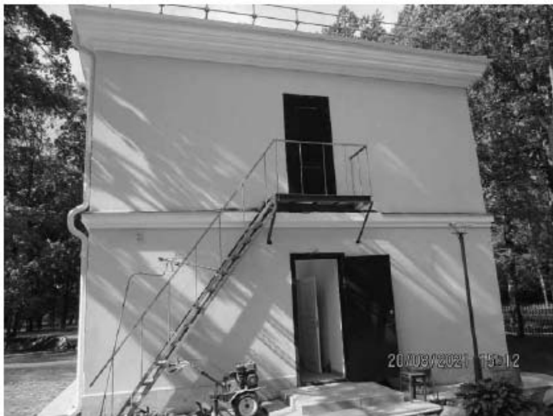
14. ОКН «Лечебница А.Л. Эбермана». Служебный флигель по адресу: СПб, г. Пушкин, Московское шоссе, д.9. Юго-восточный фасад. Общий вид. Дата съёмки: 10.05.2022.
