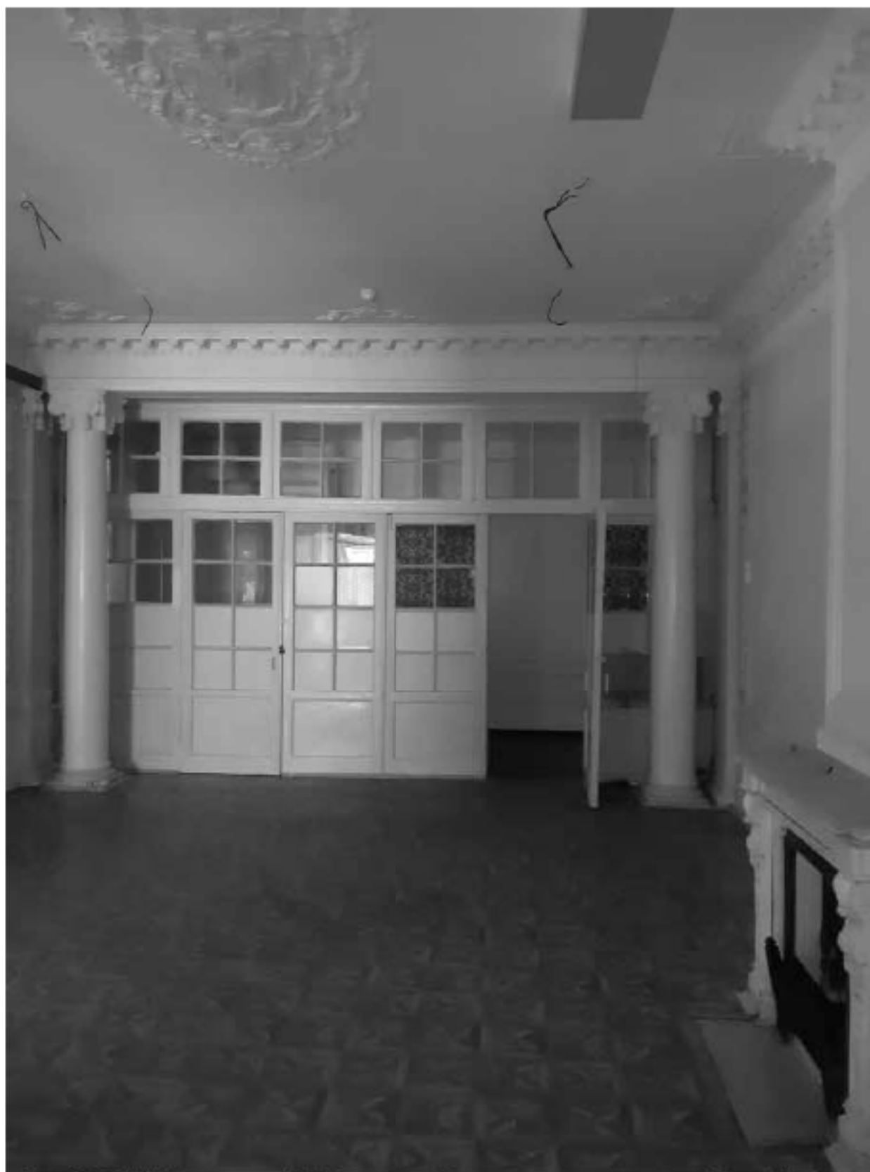
Фото 12. ОКН «Лечебница А.Л. Эбермана». Главное здание по адресу: СПб, г. Пушкин, Московское шоссе, д. 7. Помещение 1.12. Общий вид. Дата съёмки: 10.05.2022.
