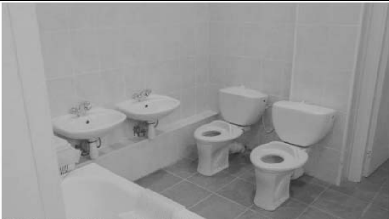
7. ОКН «Лечебница А.Л. Эбермана». Служебный флигель по адресу: СПб, г. Пушкин, Московское шоссе, д. 9, литера А. Помещение 2.4. Дата съёмки: 10.05.2022.
