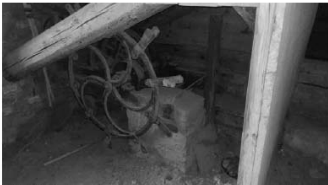
Фото 38. ОКН «Лечебница А.Л. Эбермана». Главное здание по адресу: СПб, г. Пушкин, Московское шоссе, д. 7. Помещение мансарды. Лифтовой механизм. Дата съёмки: 10.05.2022.
