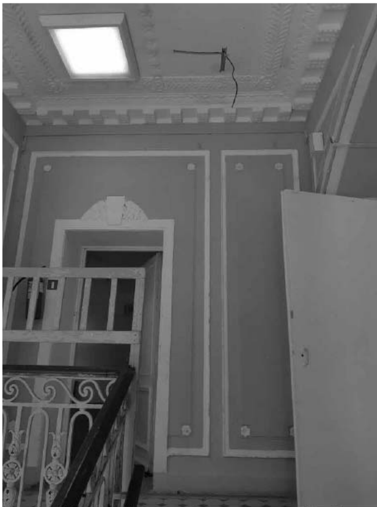
Фото 24. ОКН «Лечебница А.Л. Эбермана». Главное здание по адресу: СПб, г. Пушкин, Московское шоссе, д. 7. Помещение Л-1. Парадная лестница. Дата съёмки: 10.05.2022.
