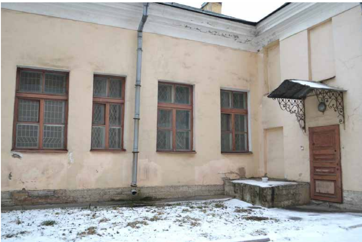
Фото 2.9. Духовная академия. Больничный флигель (наб. Обводного канала, 7, литер А). Восточный фасад. Фрагмент. Съёмка 01.12.2021 г.
