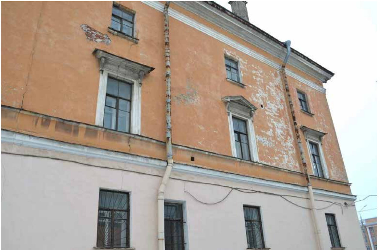
Фото 1.25. Духовная академия. Главное здание (наб. Обводного канала, 7, литер Г). Западный дворовый фасад. Оконные проёмы в уровне первого, второго и третьего этажей. Фрагмент. Съёмка 01.12.2021 г.
