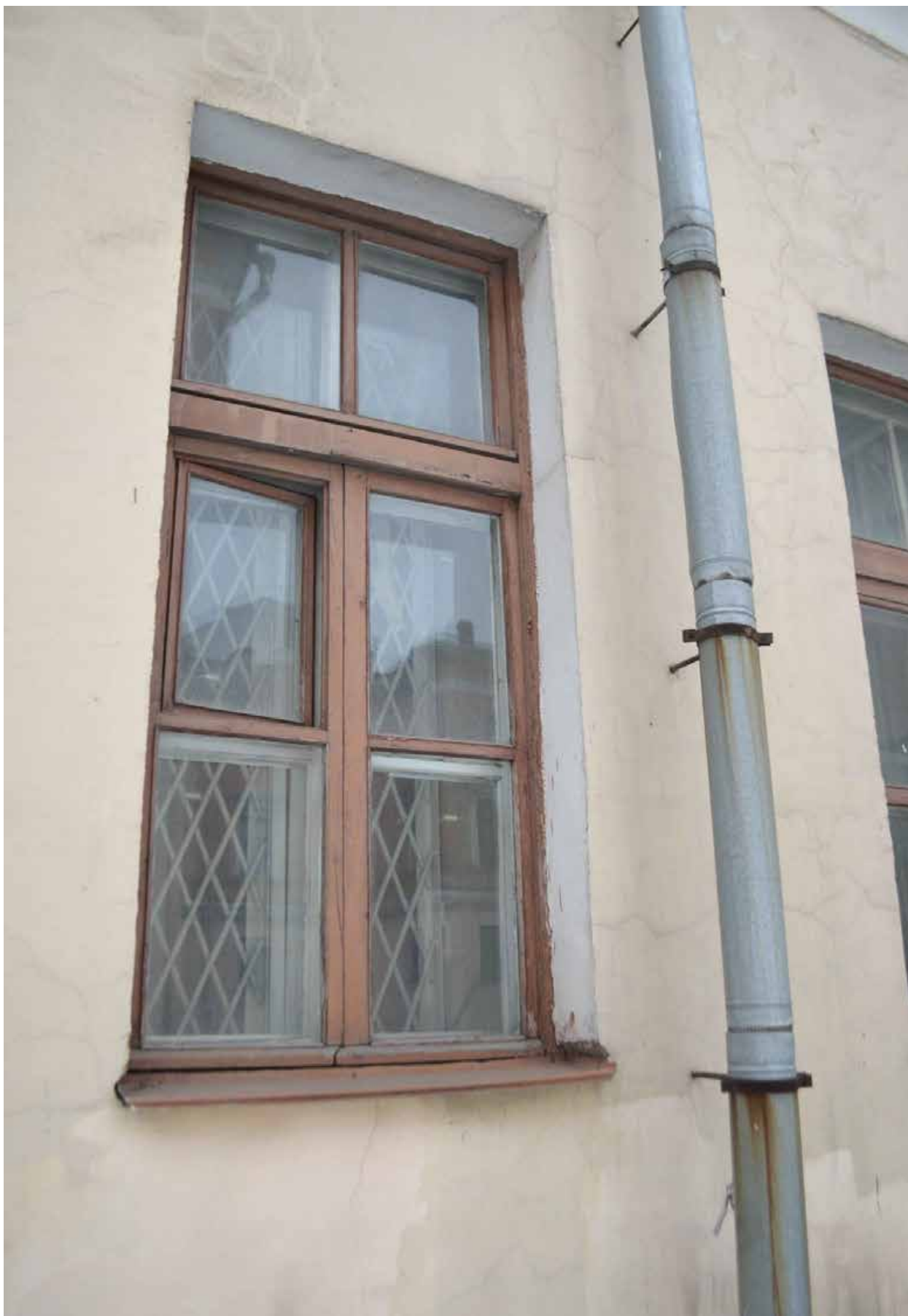
Фото 2.10. Духовная академия. Больничный флигель (наб. Обводного канала, 7, литер А). Восточный фасад. Оконный проём. Фрагмент. Съёмка 01.12.2021 г.
