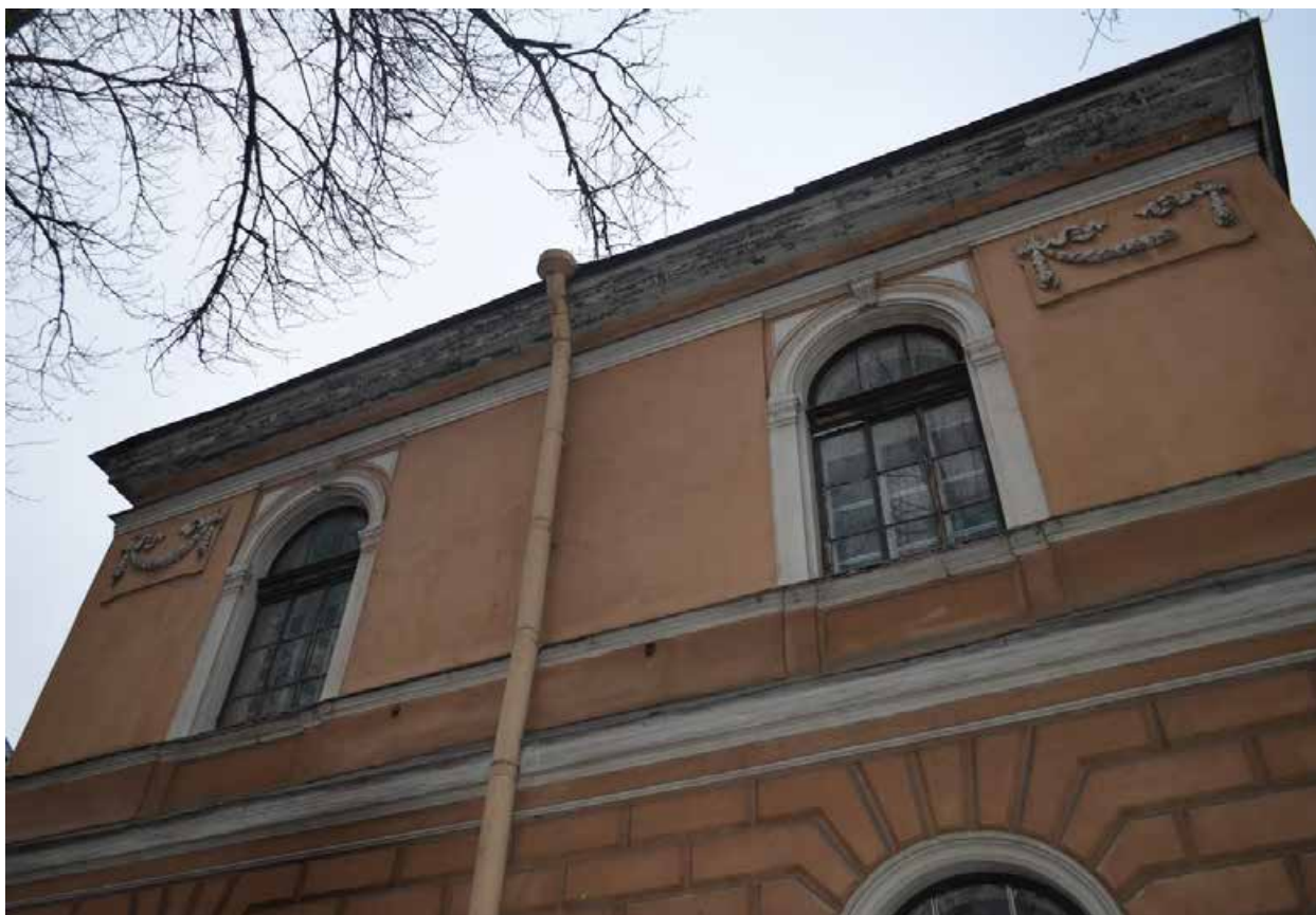
Фото 3.14. Духовная академия. Библиотека (наб. Обводного канала, 11, литер А). Восточный фасад. Фрагмент. Съёмка 01.12.2021 г.
