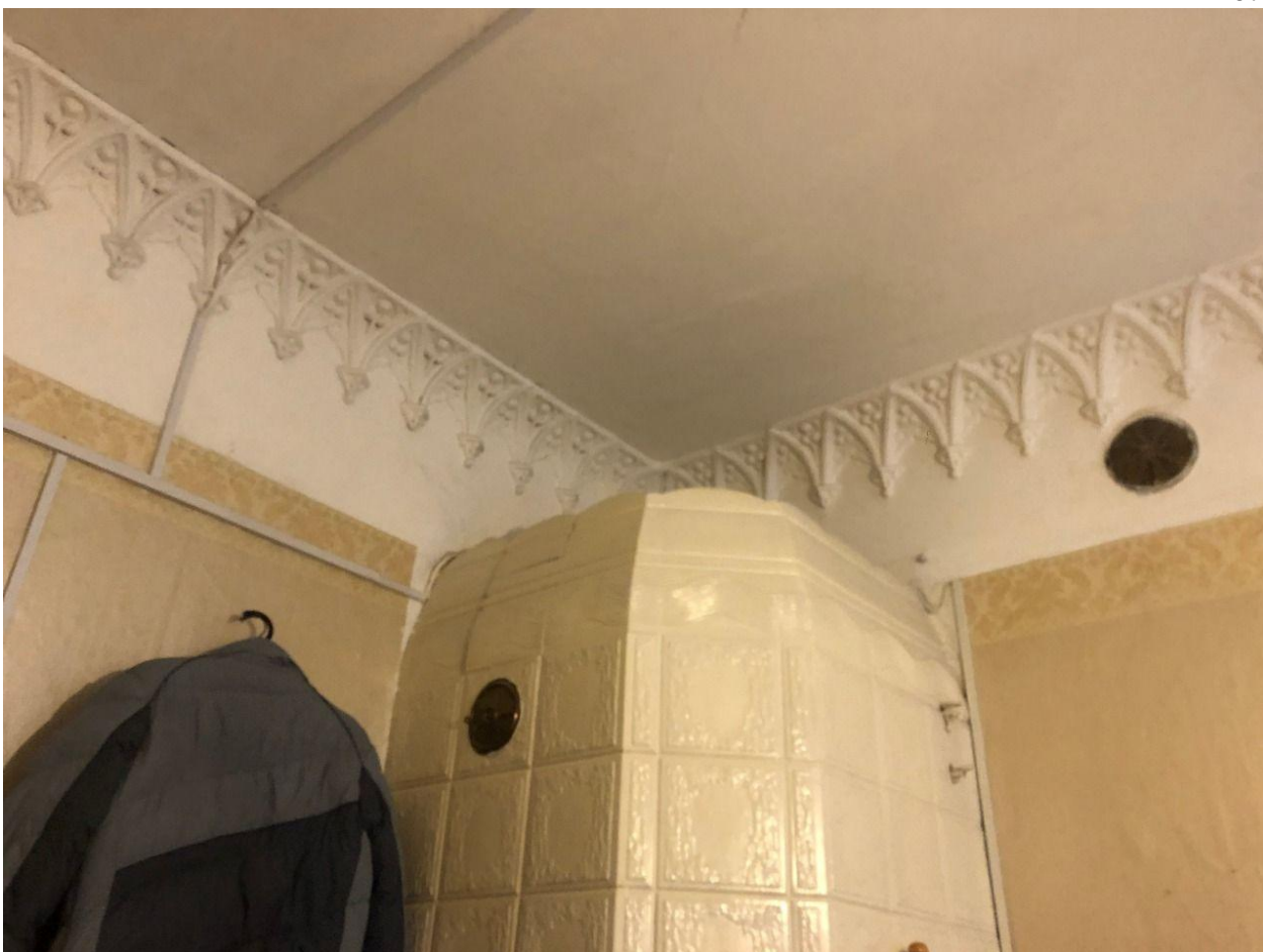
Фото 59.Интерьер квартиры №2, расположенной в выявленном объекте культурного наследия «Дом Т.М. Любищевой», ч.п.12, лепной декор потолка
