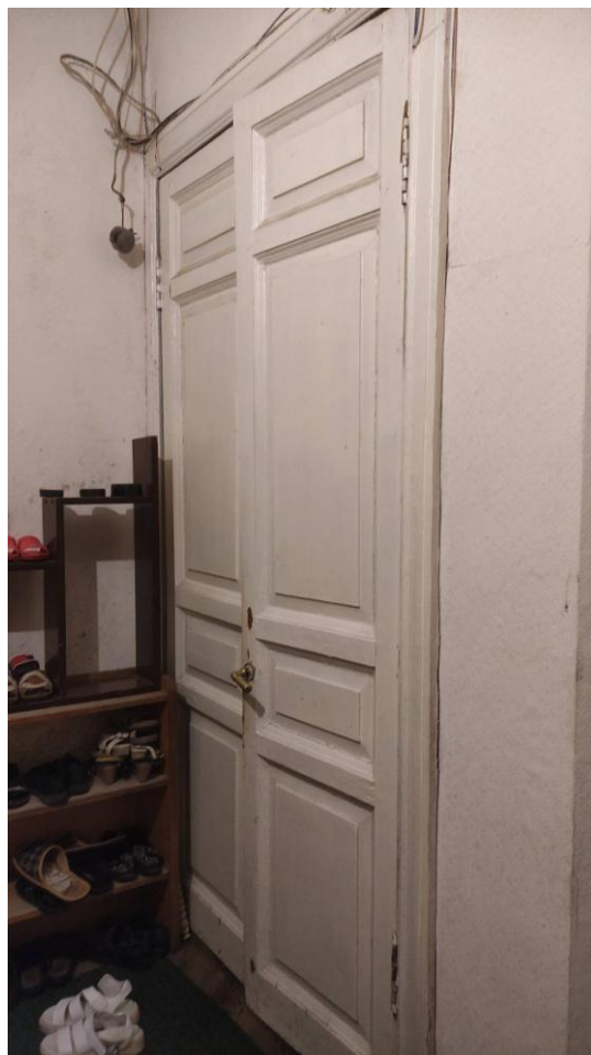
Фото 15. Входное дверное заполнение квартиры №2, расположенной в выявленном объекте культурного наследия «Дом Т.М. Любищевой», вид со стороны коридора квартиры
