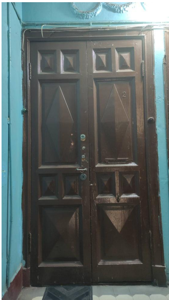
Фото 14. Входное дверное заполнение квартиры №2, расположенной в выявленном объекте культурного наследия «Дом Т.М. Любищевой», вид со стороны лестничной клетки
