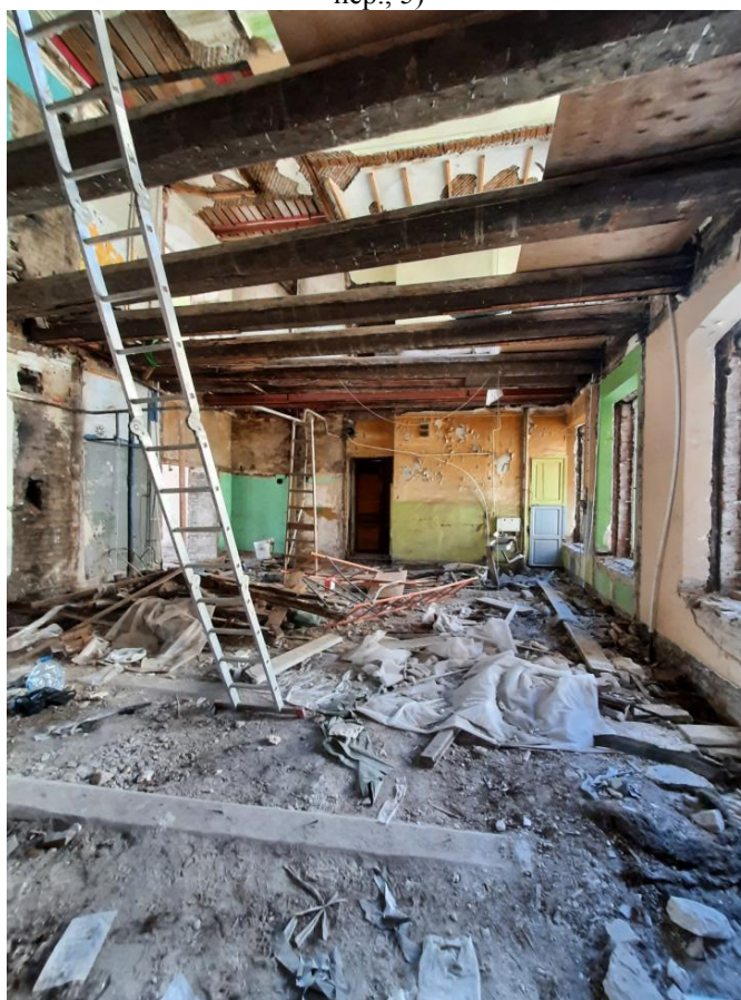
Фото 20 Интерьер квартиры №31 выявленного объекта культурного наследия «Дом Ф.Ф. Шпринга» расположенного по адресу: Санкт-Петербург, пер. Тучков, дом 11/5, литера А (Тучков пер., 11; Волховский пер., 5)
