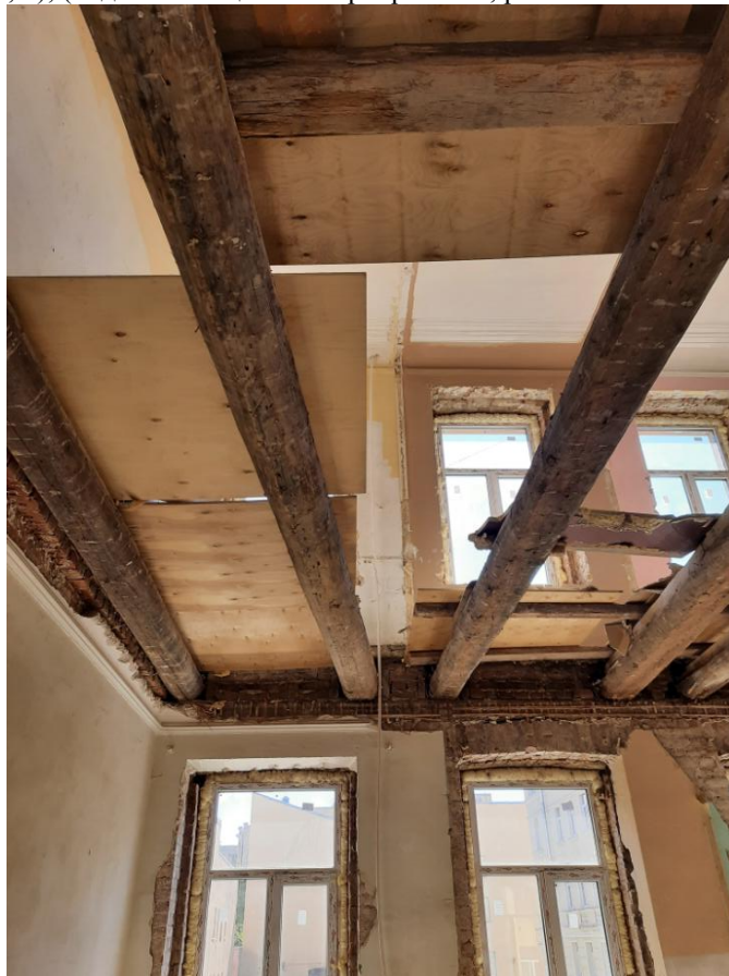
Фото 18 Интерьер квартиры №35 выявленного объекта культурного наследия «Дом Ф.Ф. Шпринга» расположенного по адресу: Санкт-Петербург, пер. Тучков, дом 11/5, литера А (Тучков пер., 11; Волховский пер., 5); (вид из помещений квартиры №31, расположенной снизу)
