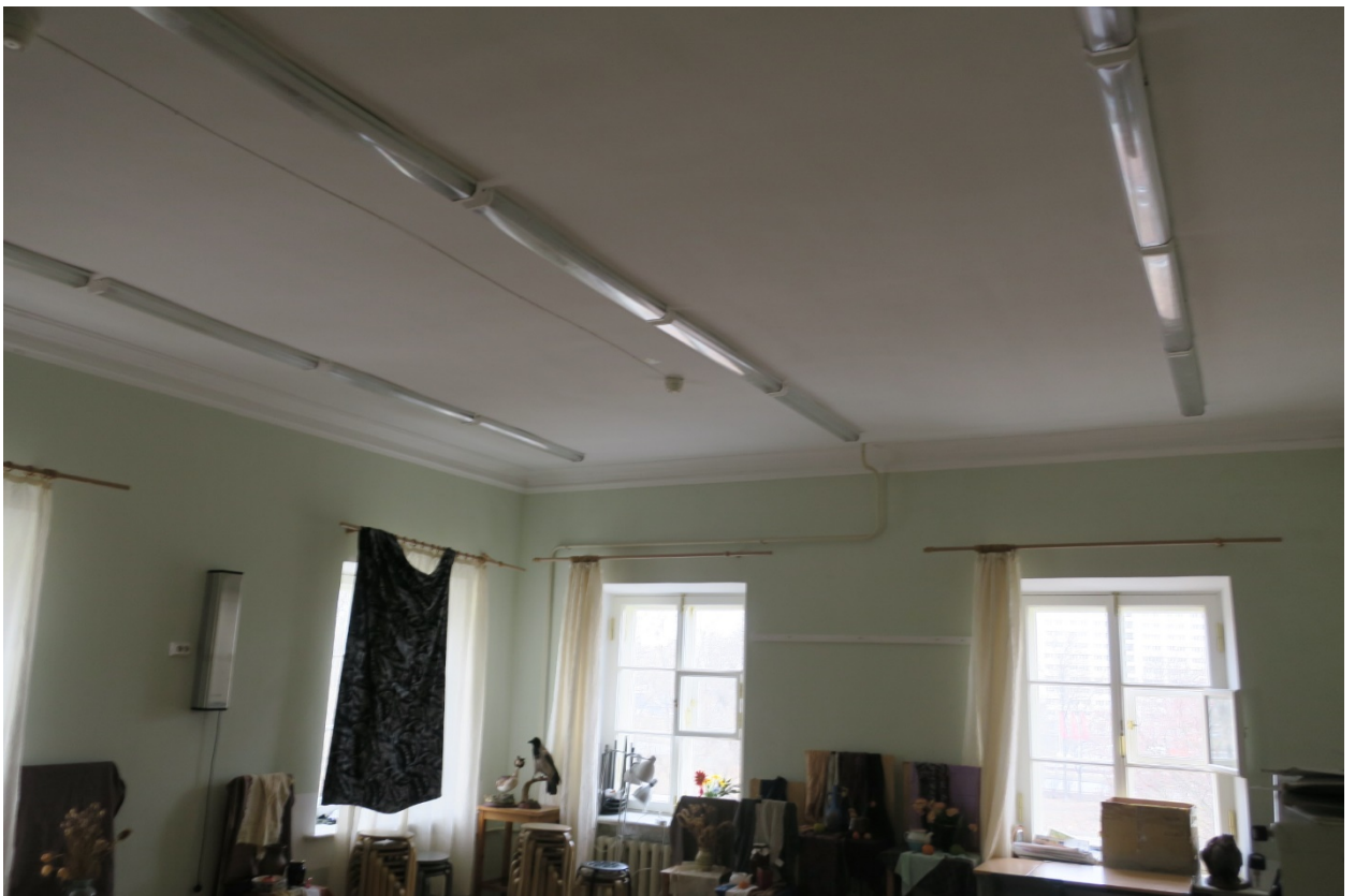
31. Помещение №6 (2-Н) в уровне 2-го этажа объекта культурного наследия федерального значения «Дача Чернышева И.Г. «Александрино», расположенного по адресу: г. Санкт-Петербург, пр. Стачек, д. 226, литера А. 11.03.2022
