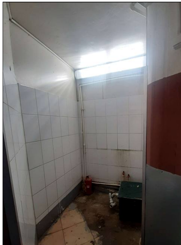
24. Объект культурного наследия «Дом, где в 1912-1913 гг. проходили заседания объединенной социал-демократической фракции IV Государственной думы». Помещения 15-Н. Помещение № 5 25.01.2020 г.
