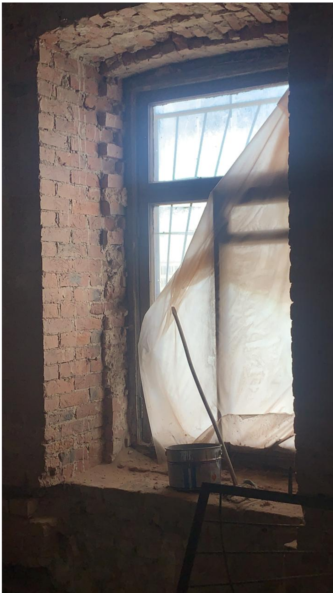
Фото 11. Оконный проем комнаты 24 в помещении 2-Н.
