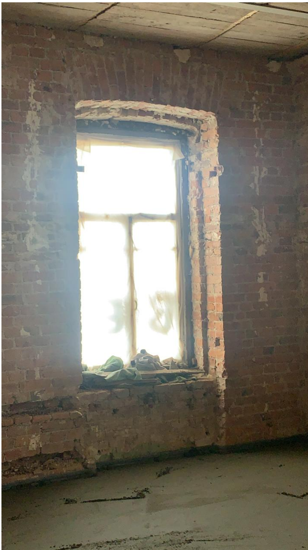
Фото 9. Оконный проем комнаты 28 в помещении 2-Н.
