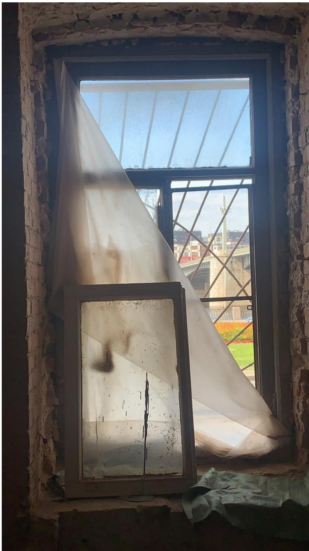
Фото 10. Оконный проем комнаты 24 в помещении 2-Н.
