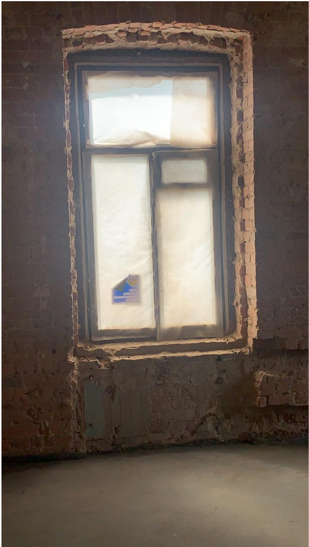
Фото 12. Оконный проем комнаты 23 в помещении 2-Н.
