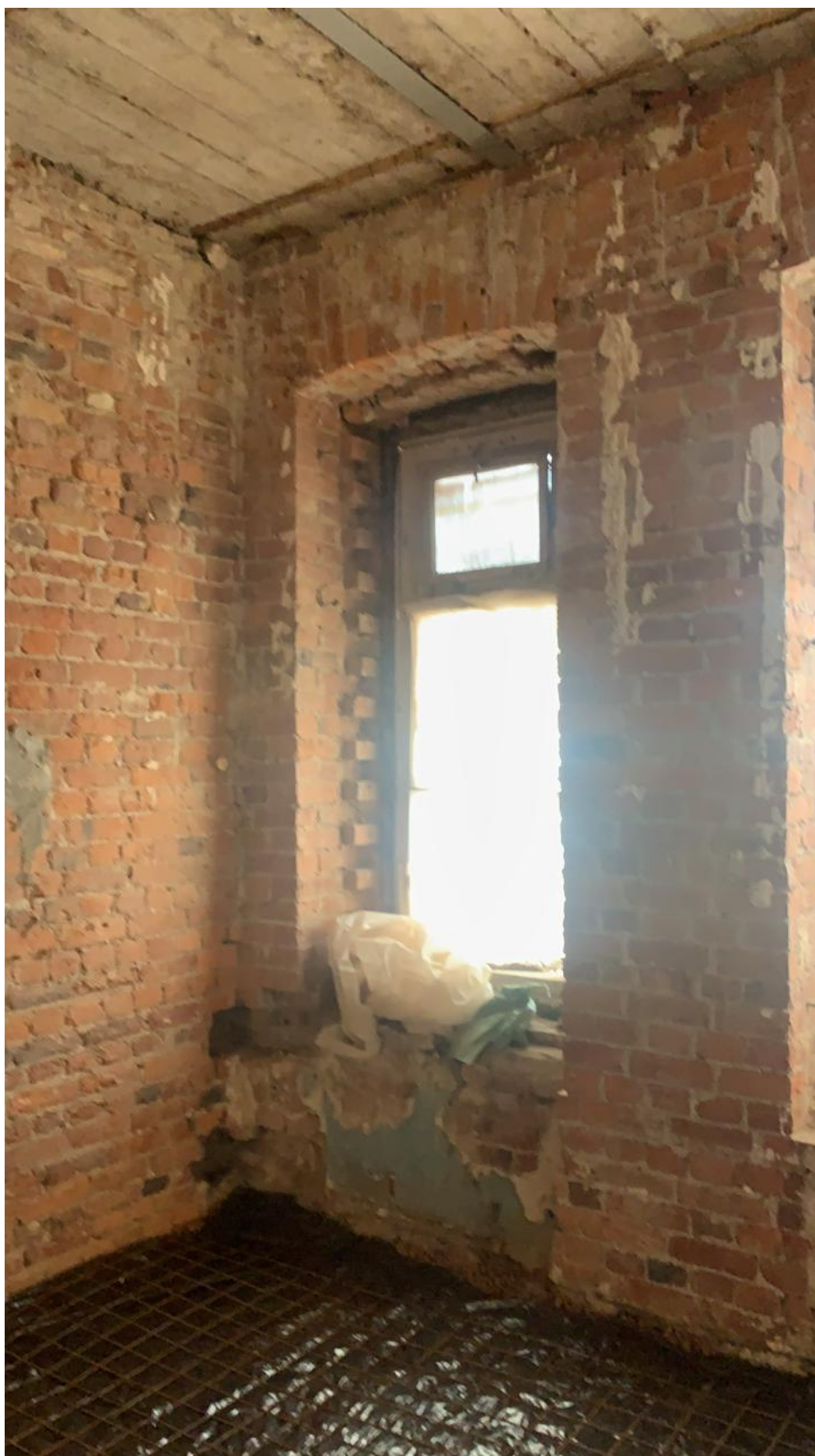
Фото 8. Оконный проем комнаты 11 в помещении 2-Н.
