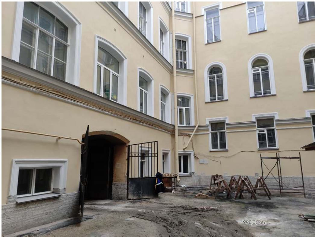
Фото 8. Фрагмент дворового фасада объекта культурного наследия федерального значения «Корпус для прислуги», входящего в состав объекта культурного наследия федерального значения «Дворец Великого князя Николая Николаевича (Ксенинский институт)» (дата фотофиксации: 08.10.2021)
