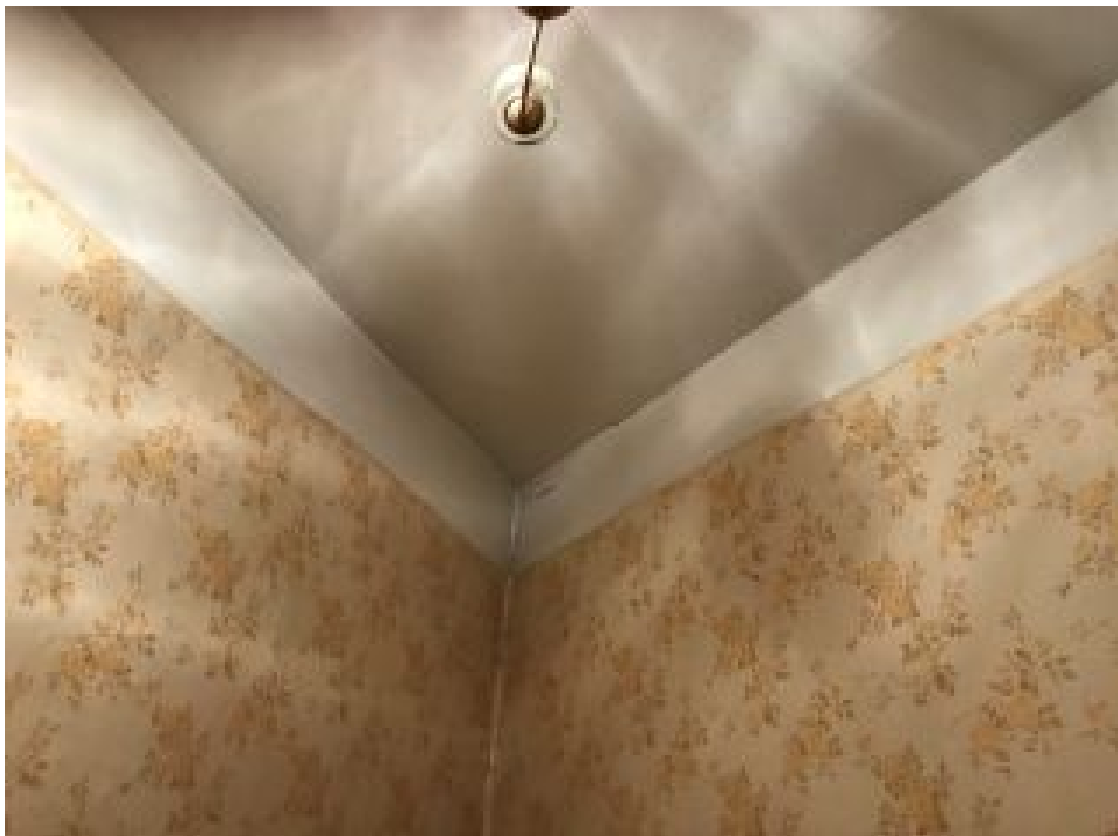
Фотография 44. Фрагмент комнаты (помещение №2). Трещина на потолке. Дефекты окрасочного слоя.
