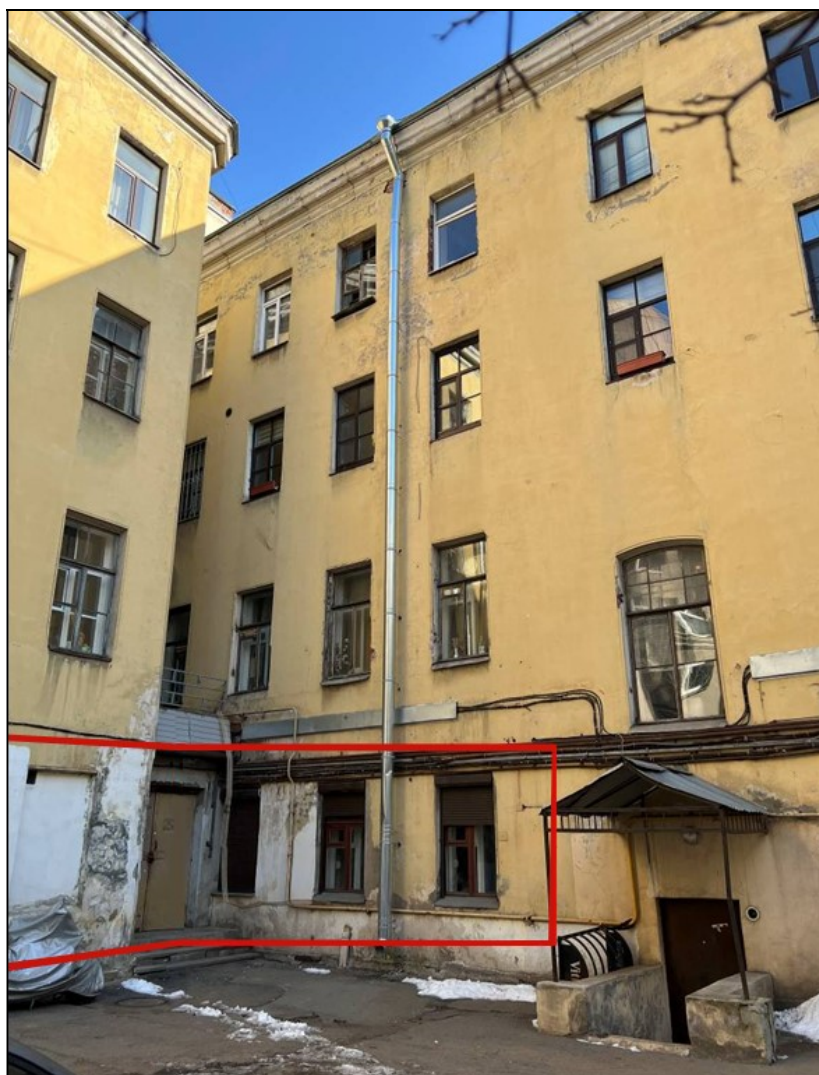
3. Выявленный объект культурного наследия «Особняк Г.П. Петрова». Фрагмент дворовых фасадов. Часть окон помещения 1-Н, ниша от заложенного оконного проёма (предусмотрено раскрытие проёма путём демонтажа кирпичной кладки) и вход в обособленное помещение 1-Н со стороны двора.
