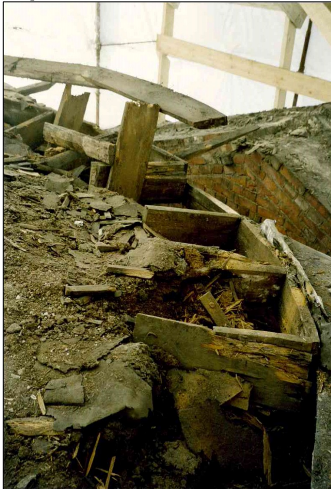
43. Часовня в ходе восстановления. Конструкции барабана купола. / Заключение о техническом состоянии часовни собора Святой Животворящей Троицы Лейб-Гвардии Измайловского полка. ПК «СТРОЙДИАГНОЗ». - СПб, 1998.
