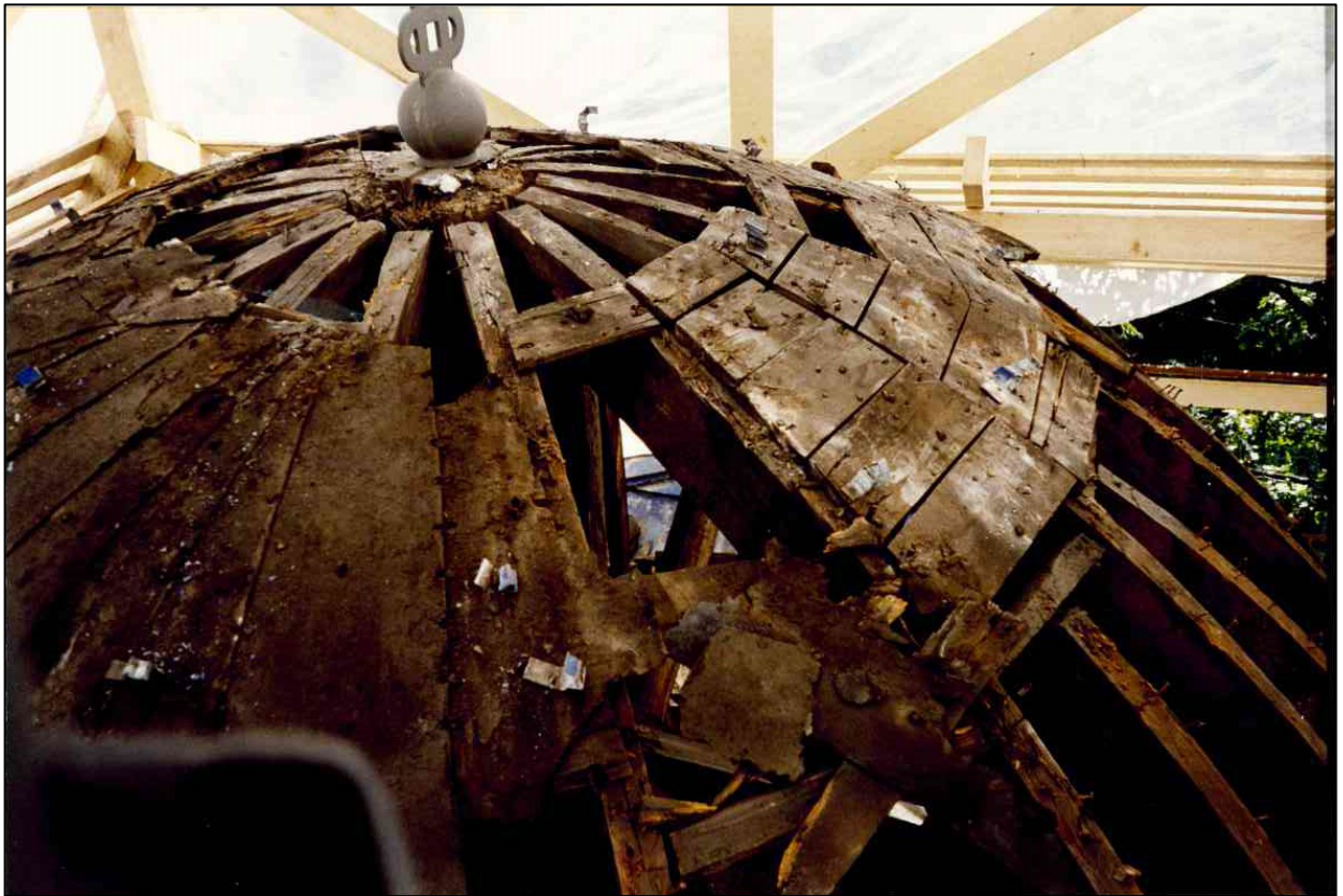
40. Часовня в ходе восстановления. Верхняя часть купола. / Заключение о техническом состоянии часовни собора Святой Животворящей Троицы Лейб-Гвардии Измайловского полка. ПК «СТРОЙДИАГНОЗ». - СПб, 1998.
