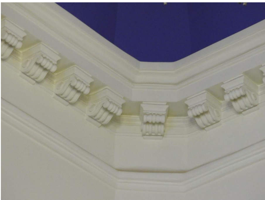
18. «Часовня, 1894 г., гражд. инж. Кондратьев С.П.», входящая в состав объекта культурного наследия федерального значения «Собор Троицкий (Измайловский)», Измайловский пр., д.4-а, лит. А, д.7-а, лит. А. Интерьер. Фрагмент. Фото 26.04.2022г.
