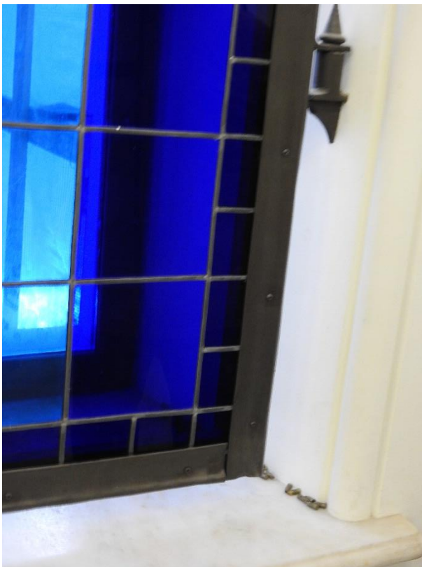
20. «Часовня, 1894 г., гражд. инж. Кондратьев С.П.», входящая в состав объекта культурного наследия федерального значения «Собор Троицкий (Измайловский)», Измайловский пр., д.4-а, лит. А, д.7-а, лит. А. Интерьер. Фрагмент. Фото 26.04.2022г.
