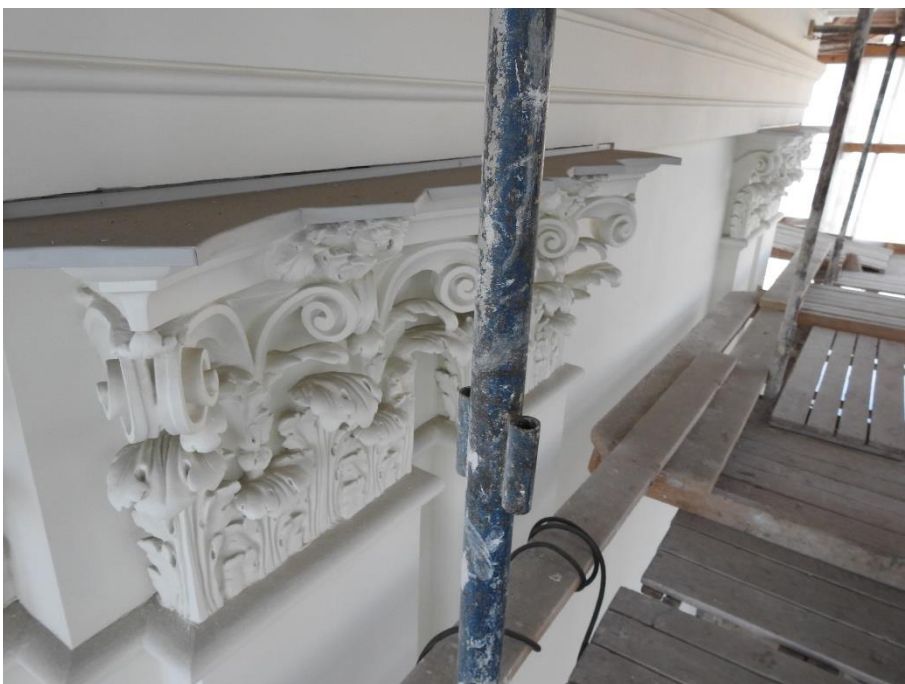
9. «Часовня, 1894 г., гражд. инж. Кондратьев С.П.», входящая в состав объекта культурного наследия федерального значения «Собор Троицкий (Измайловский)», Измайловский пр., д.4-а, лит. А, д.7-а, лит. А. Южный фасад. Фрагмент. Фото 26.04.2022г.
