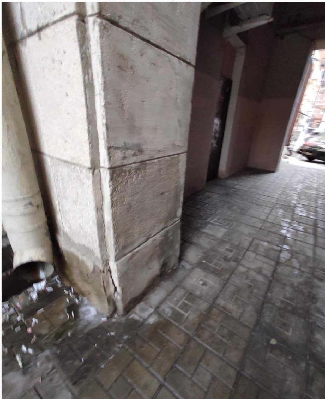
Фото 21. Проходная арка вид с Московского проспекта. Трещины, утрата штукатурного слоя, деструкция штукатурного слоя, поздние цементные вставки, докомпоновки
