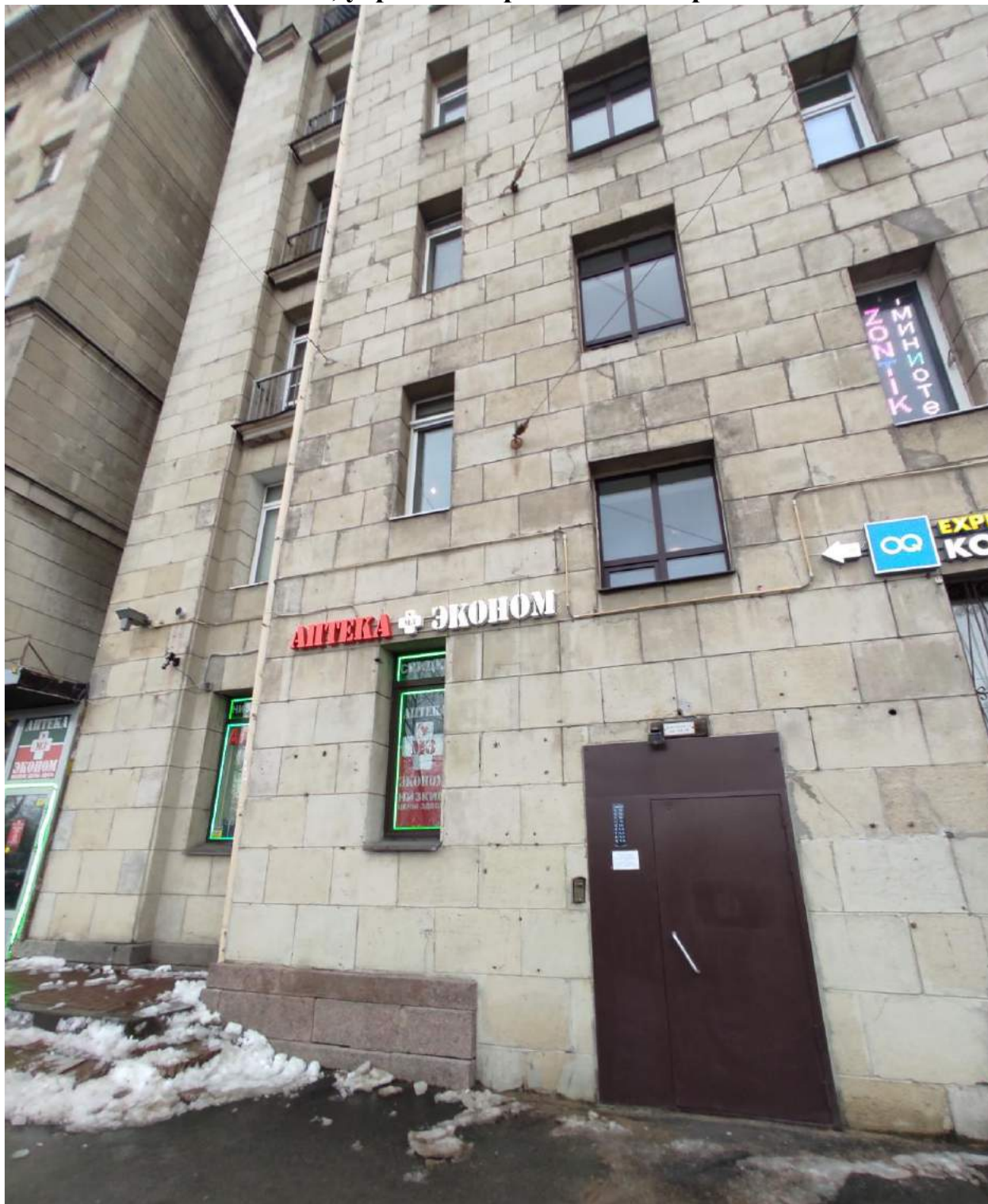
Фото 7. Фасад Г-А. Выветривания раствора цоколя, биопоражения, деструкция терразитовой штукатурки, выветривание раствора между швами, трещины, замокания, загрязнения, следы многочисленных цементных вставок, утрата исторического дверного заполнения
