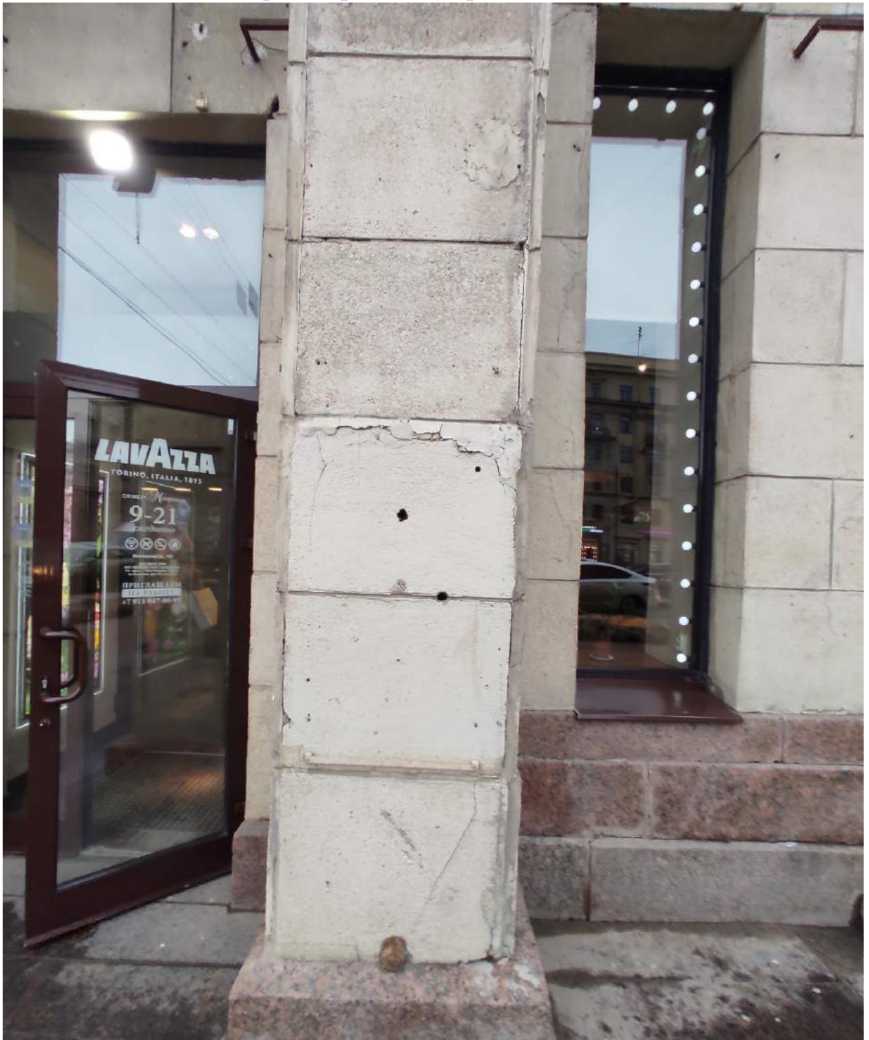
Фото № 16. Фасад 1-4. Колонна. Поздние цементные вставки, утрата шовного раствора между терразитовыми плитами, трещины в слое терразитовой штукатурки. Биопоражения цоколя, выветривание шовного раствора между гранитными плитами
