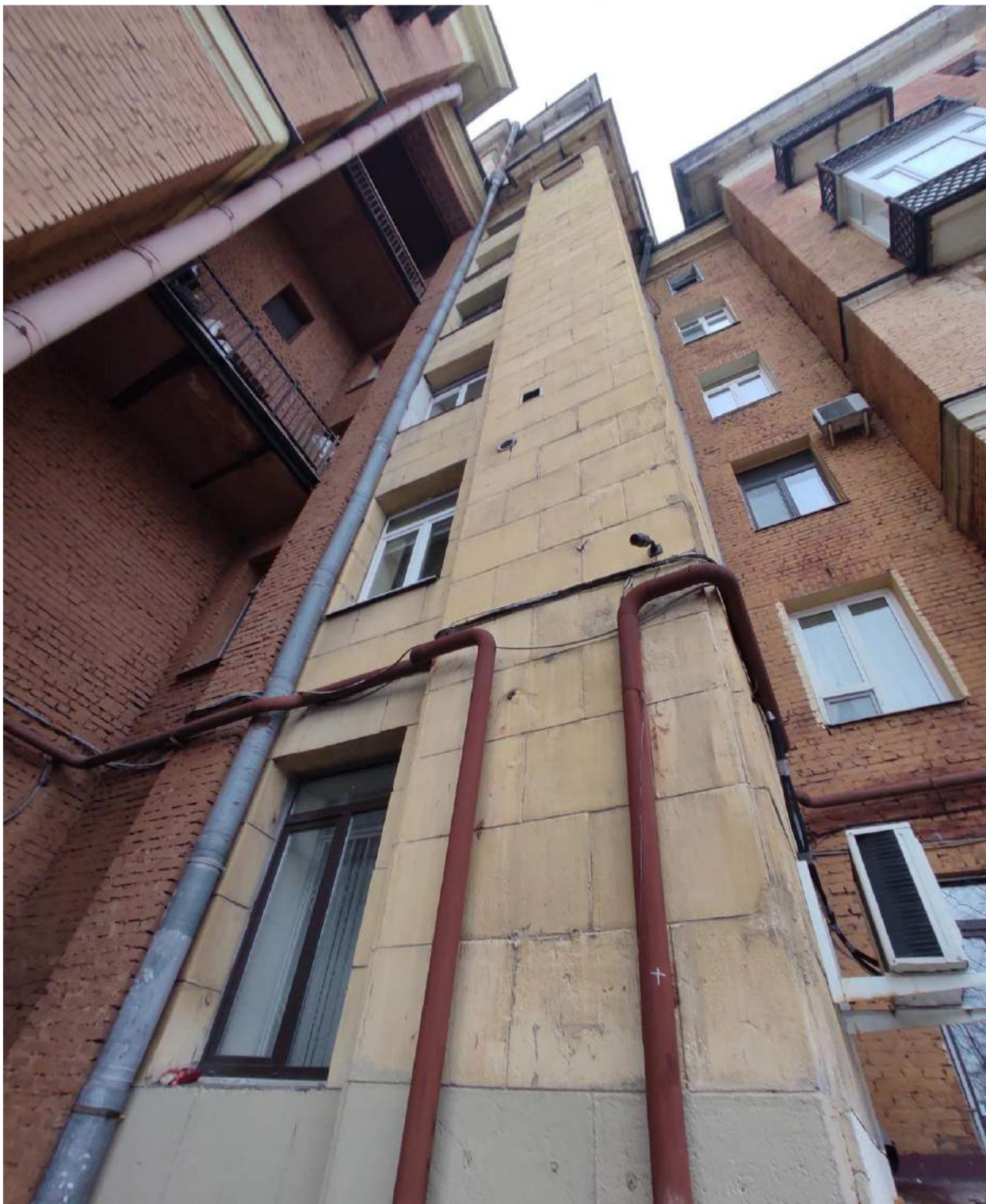
Фото 24. Фасад 4-1. Следы многочисленных покрасок терразитовой штукатурки, трещины, поздние цементные вставки, деструкция штукатурного слоя
