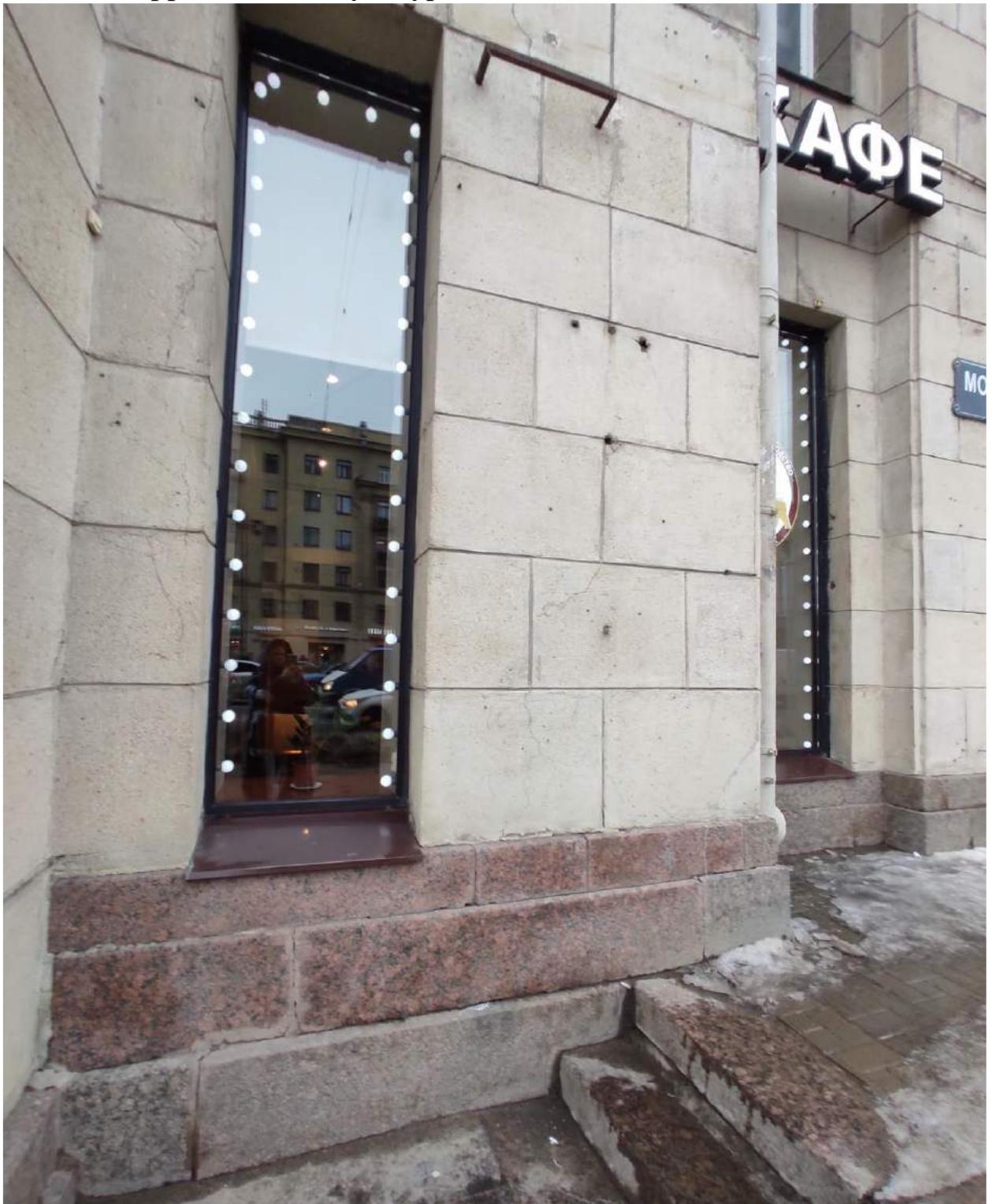
Фото 17. Фасад 1-4. Загрязнения, биопоражения, высолы цоколя и гранитных ступеней. Утрата шовного раствора, трещины в, загрязнения терразитовой штукатурки, поздние цементные вставки
