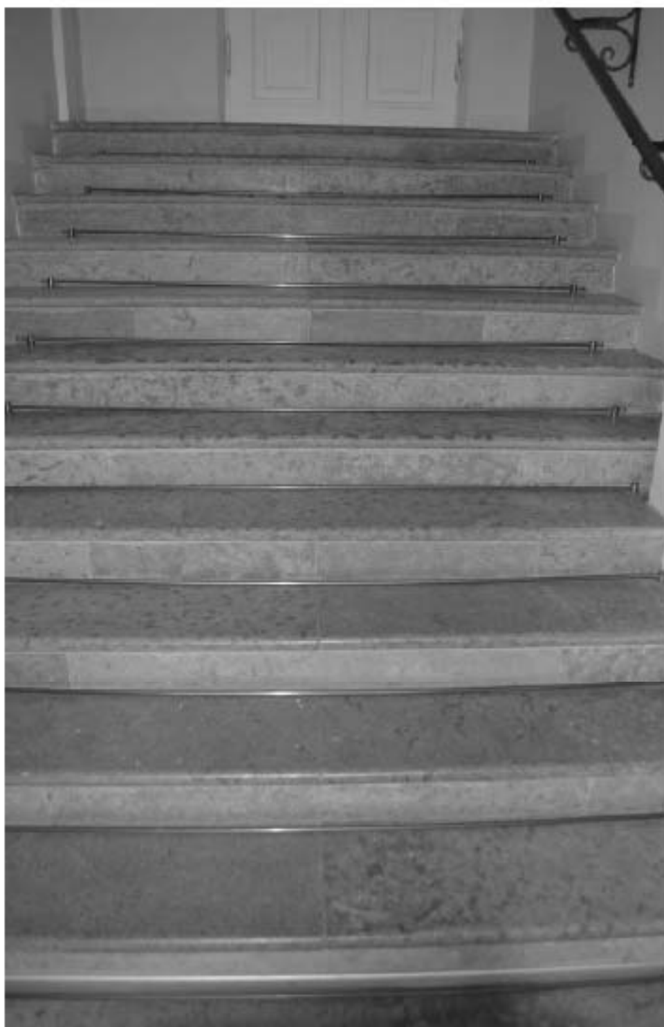
Фото 42. ОКН федерального значения «Корпус семинарский с южными воротами главного двора» (г. Санкт-Петербург, набережная реки Моnастырки, дом 1, лит. Г). Галерея первого этажа. Лестница. Съёмка 08.11.2021 г.
