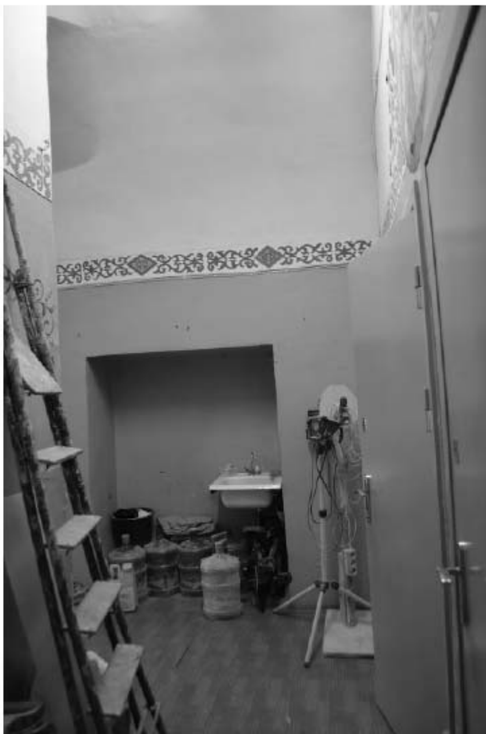
Фото 21. ОКН федерального значения «Корпус семинарский с южными воротами главного двора» (г. Санкт-Петербург, набережная реки Монастырки, дом 1, лит. Г). Первый этаж. Помещение 3-Н (44). Съёмка 08.11.2021 г.
