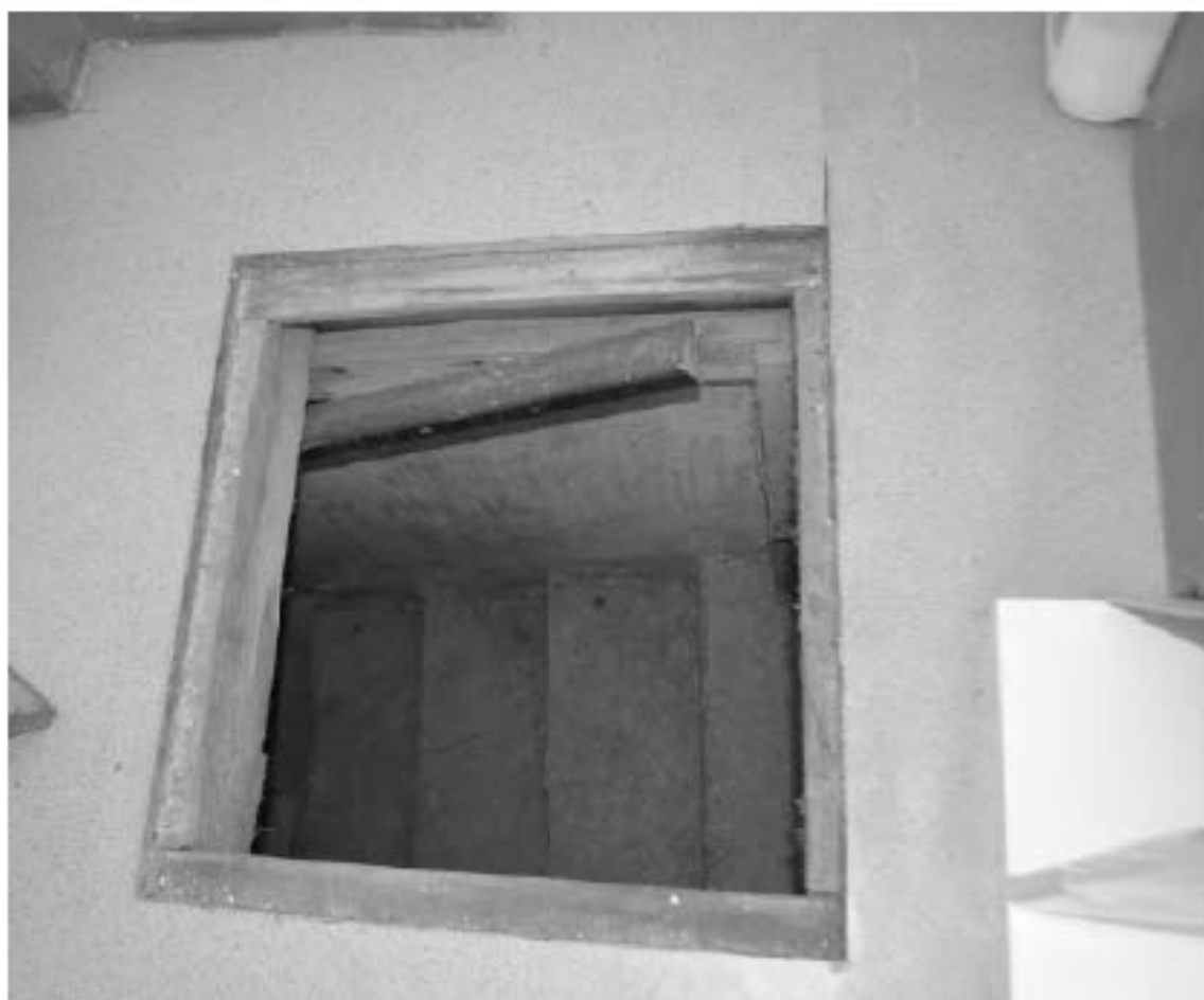
Фото 15. ОКН федерального значения «Корпус семинарский с южными воротами главного двора» (г. Санкт-Петербург, набережная реки Монастырки, дом 1, лит. Г). Первый этаж. Галерея первого этажа. Фрагмент. Съёмка 08.11.2021 г.
