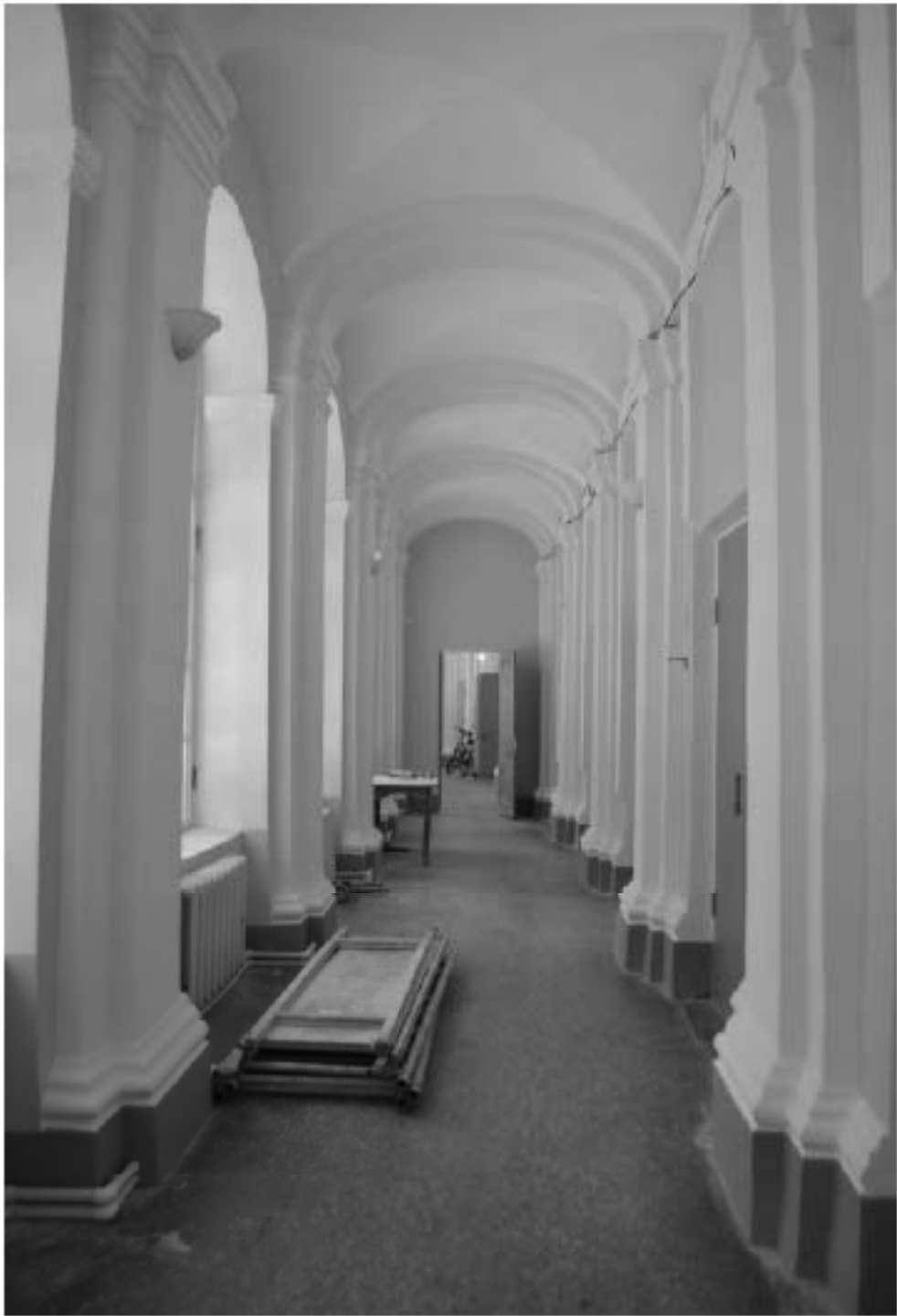
Фото 11. ОКН федерального значения «Корпус семинарский с южными воротами главного двора» (г. Санкт-Петербург, набережная реки Монастырки, дом 1, лит. Г). Первый этаж. Галерея первого этажа. Съёмка 08.11.2021 г.
