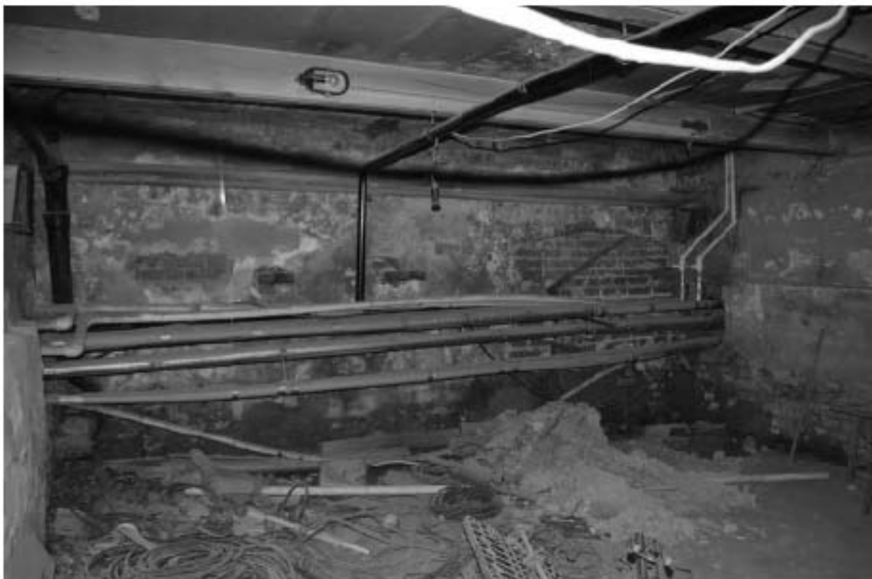
Фото 60. ОКН федерального значения «Корпус семинарский с южными воротами главного двора» (г. Санкт-Петербург, набережная реки Моастырки, дом 1, лит. Г). Подвал. Помещение в осях В-Г/10-11. Съёмка 08.11.2021 г.
