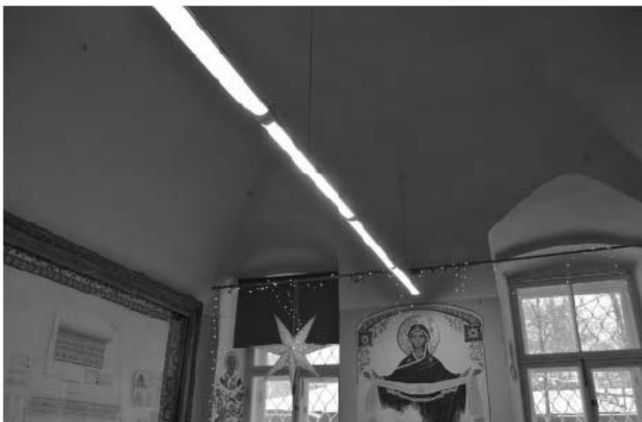
Фото 19. ОКН федерального значения «Корпус семинарский с южными воротами главного двора» (г. Санкт-Петербург, набережная реки Монаяырки, дом 1, лит. Г). Первый этаж. Помещение 3-Н (45). Съёмка 08.11.2021 г.
