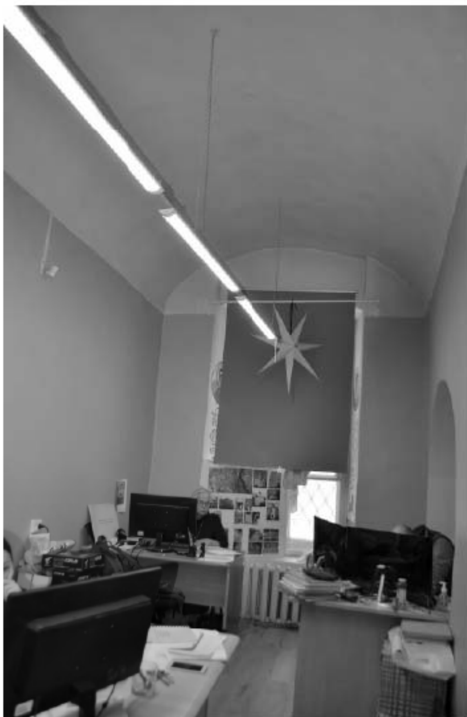
Фото 17. ОКН федерального значения «Корпус семинарский с южными воротами главного двора» (г. Санкт-Петербург, набережная реки Монастырки, дом 1, лит. Г). Первый этаж. Помещение 3-Н (46). Съёмка 08.11.2021 г.
