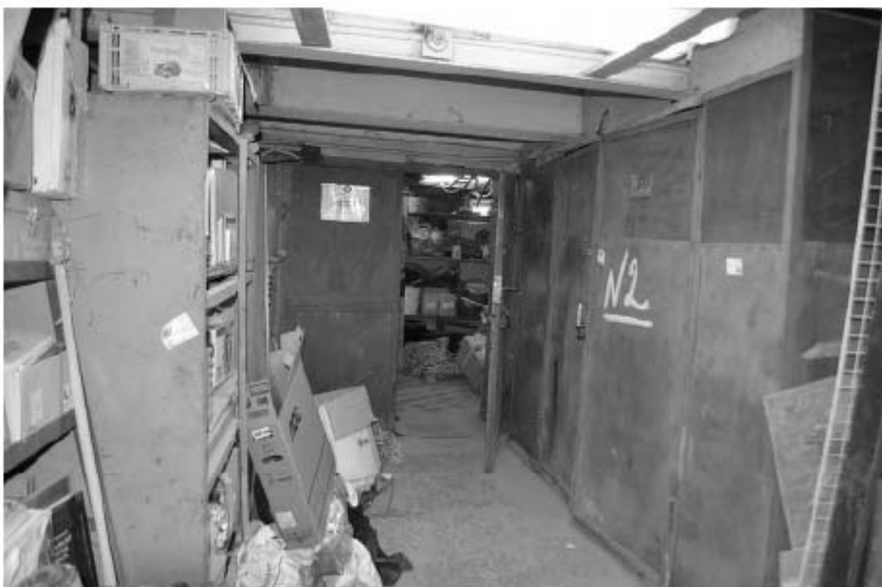
Фото 56. ОКН федерального значения «Корпус семинарский с южными воротами главного двора» (г. Санкт-Петербург, набережная реки Молятырки, дом 1, лит. Г). Подвал. Помещение в осях В-Г/4-6. Съёмка 08.11.2021 г.
