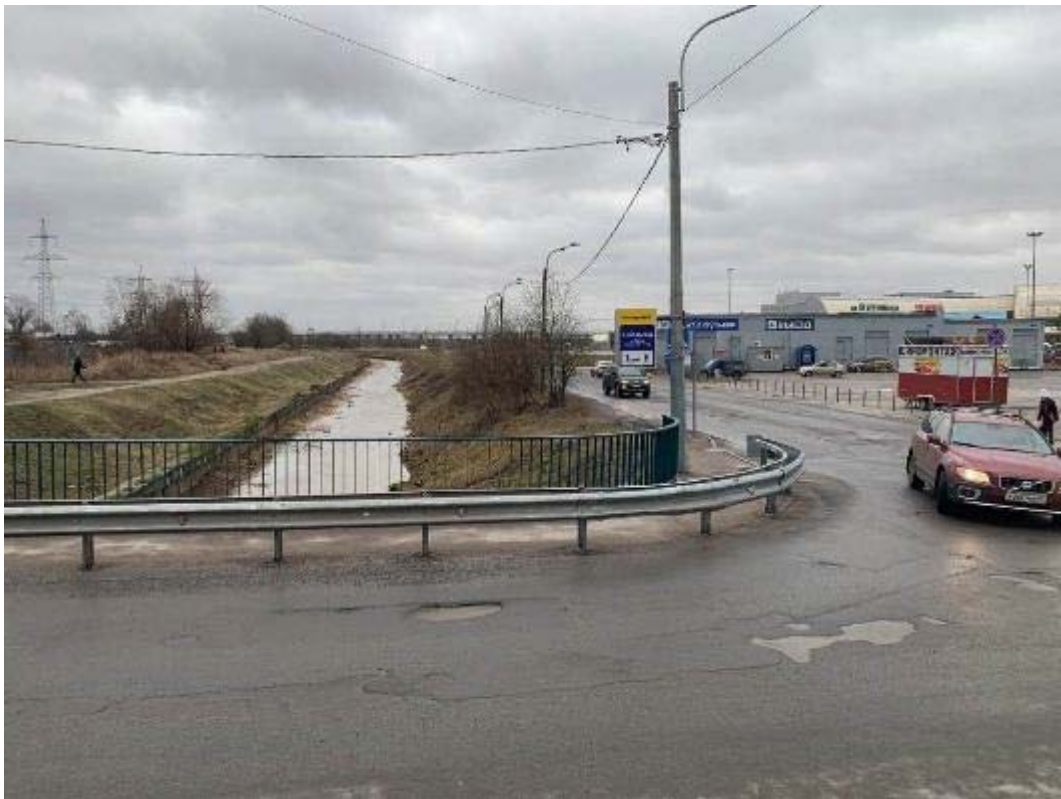
Рис. 125. Санкт-Петербург, Фрунзенский, Московский и Пушкинский р-ны. Точка съёмки 34. Общий вид участка обследования. Вид на ЮЮВ.
