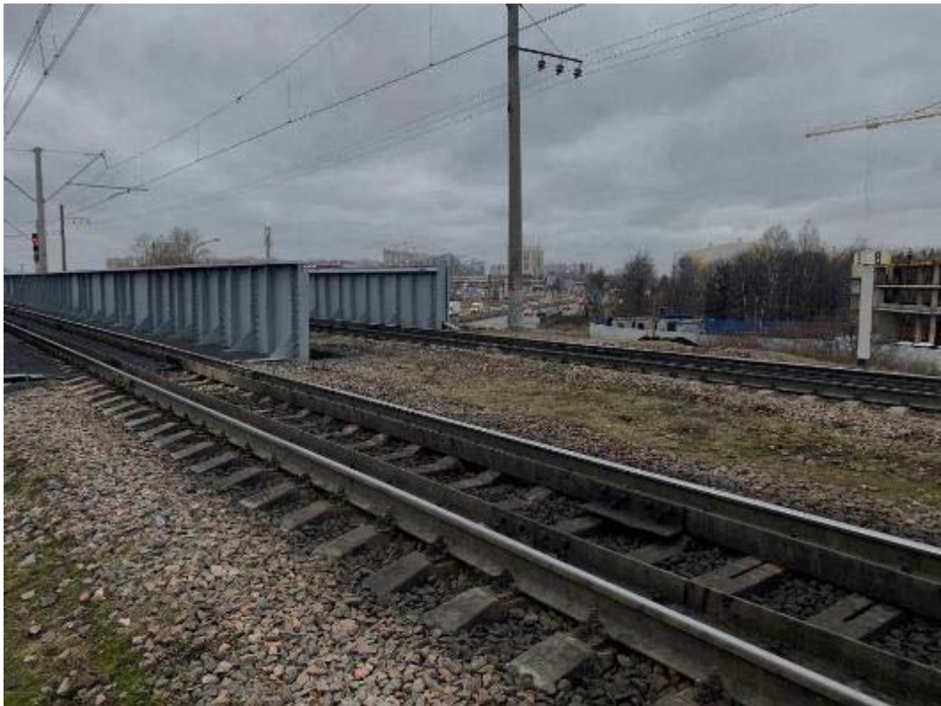
Рис. 103. Санкт-Петербург, Фрунзенский, Московский и Пушкинский р-ны. Точка съёмки 27. Общий вид участка обследования. Вид на ЗСЗ.
