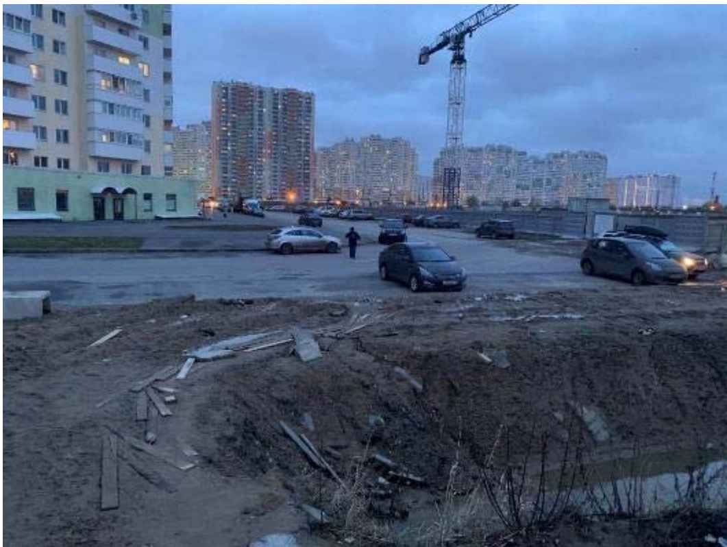
Рис. 87. Санкт-Петербург, Фрунзенский, Московский и Пушкинский р-ны. Точка съёмки 23. Общий вид участка обследования. Вид на ВЮВ.
