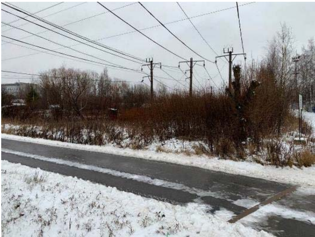
Рис. 59. Санкт-Петербург, Фрунзенский, Московский и Пушкинский р-ны. Точка съёмки 13. Общий вид участка обследования. Вид на ВСВ.
