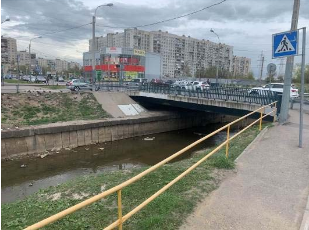
Рис. 391. Санкт-Петербург, Фрунзенский, Московский и Пушкинский р-ны. Точка съёмки 103. Общий вид участка обследования. Вид на ЮВ.
