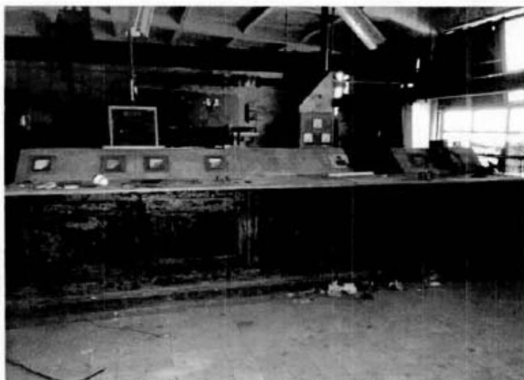
Фото 12. Пульт управления в бывш. турбинном зале.
