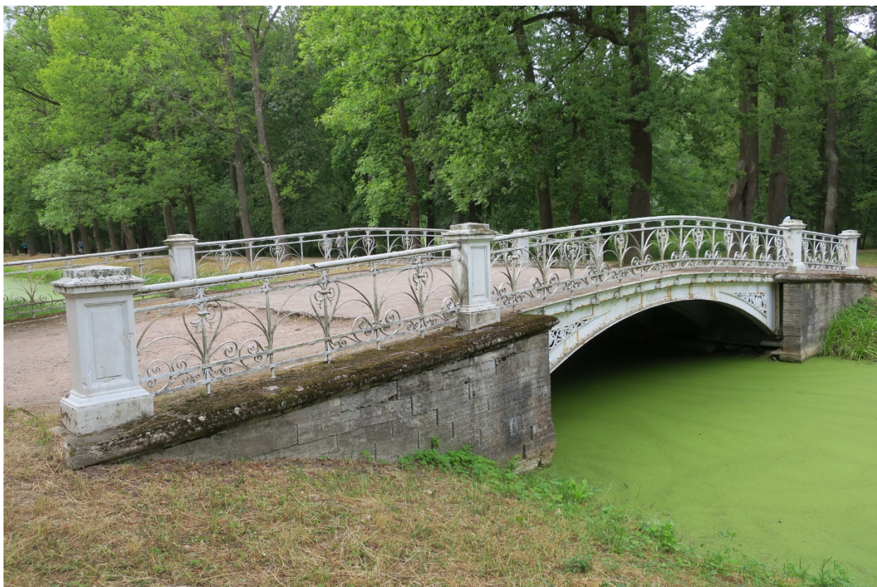
4. Низовой фасад объекта культурного наследия федерального значения «Мост Металлический», расположенного по адресу: Санкт-Петербург, г. Пушкин, Александровский парк, литера ББ. Вид с северо-запада. 01.08.2021
