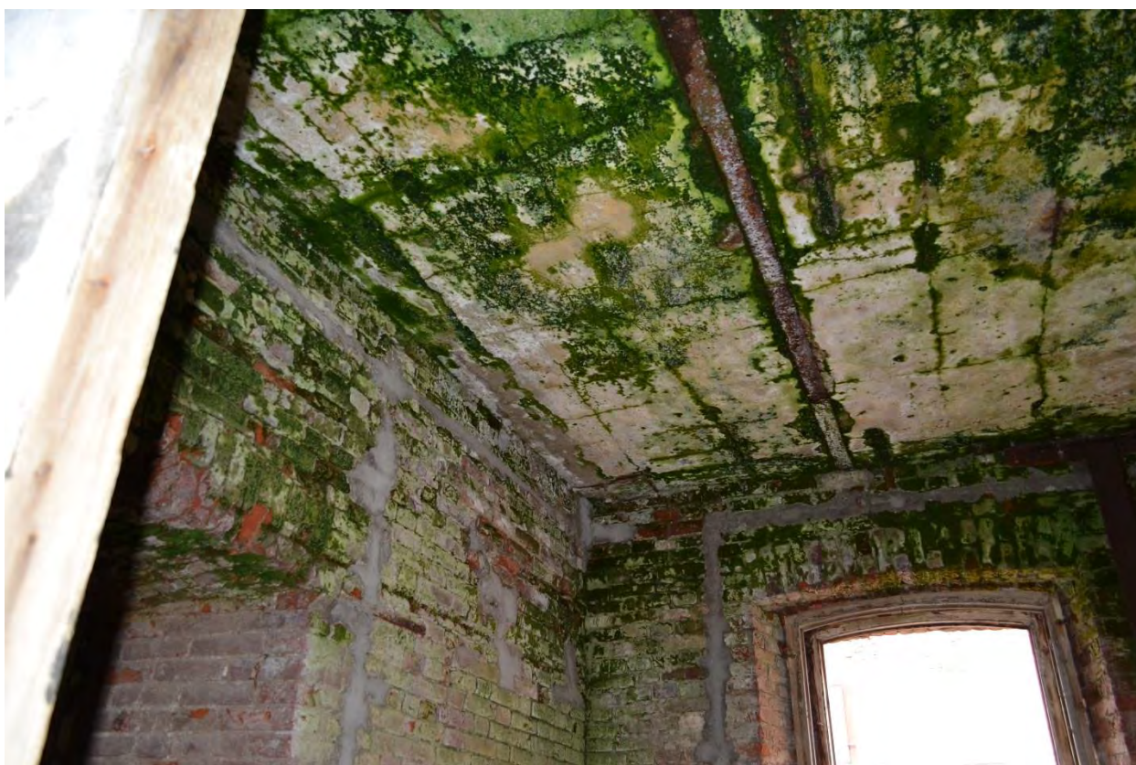
Фото 15. Третий этаж. Помещения горжевой части. Вид на повреждение биопоражениями перекрытий.
