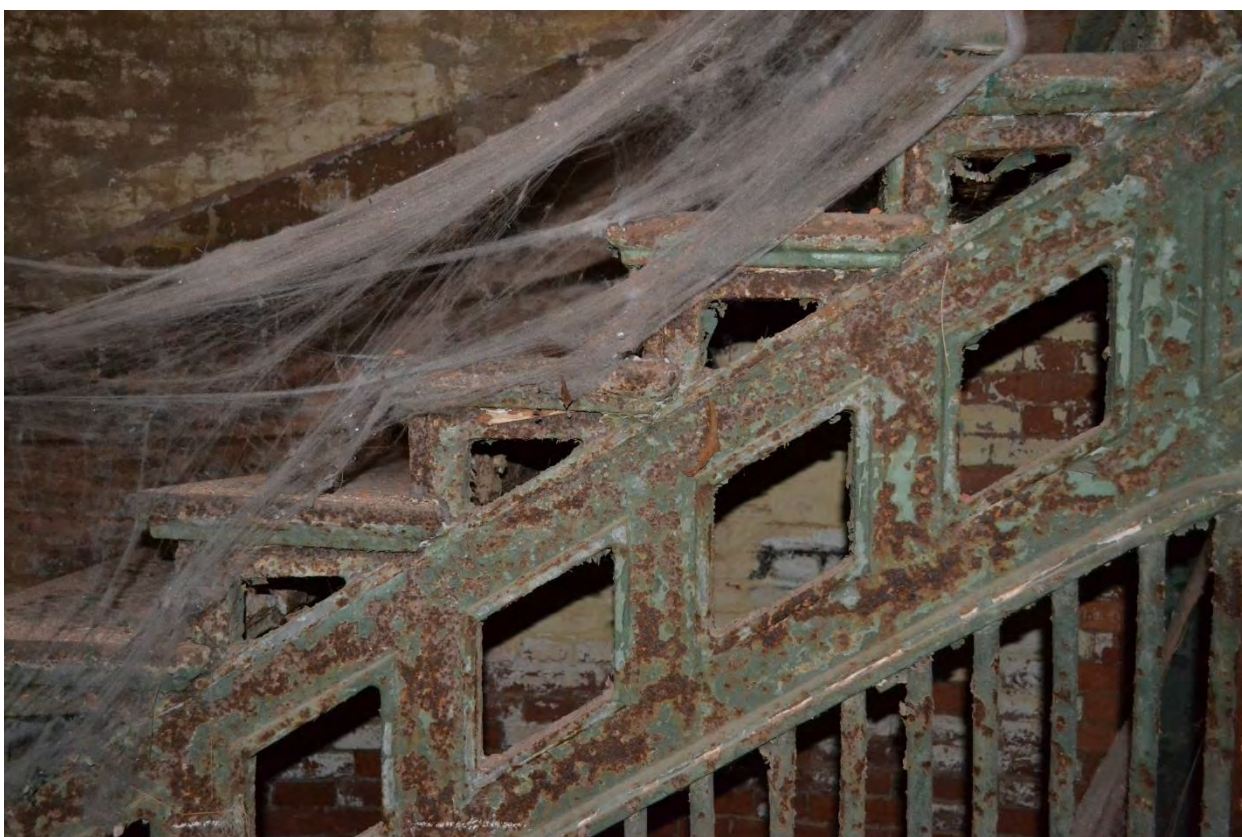
Фото 2. Фрагмент конструкции чугунной лестницы - косоур и профиль ступеней.
