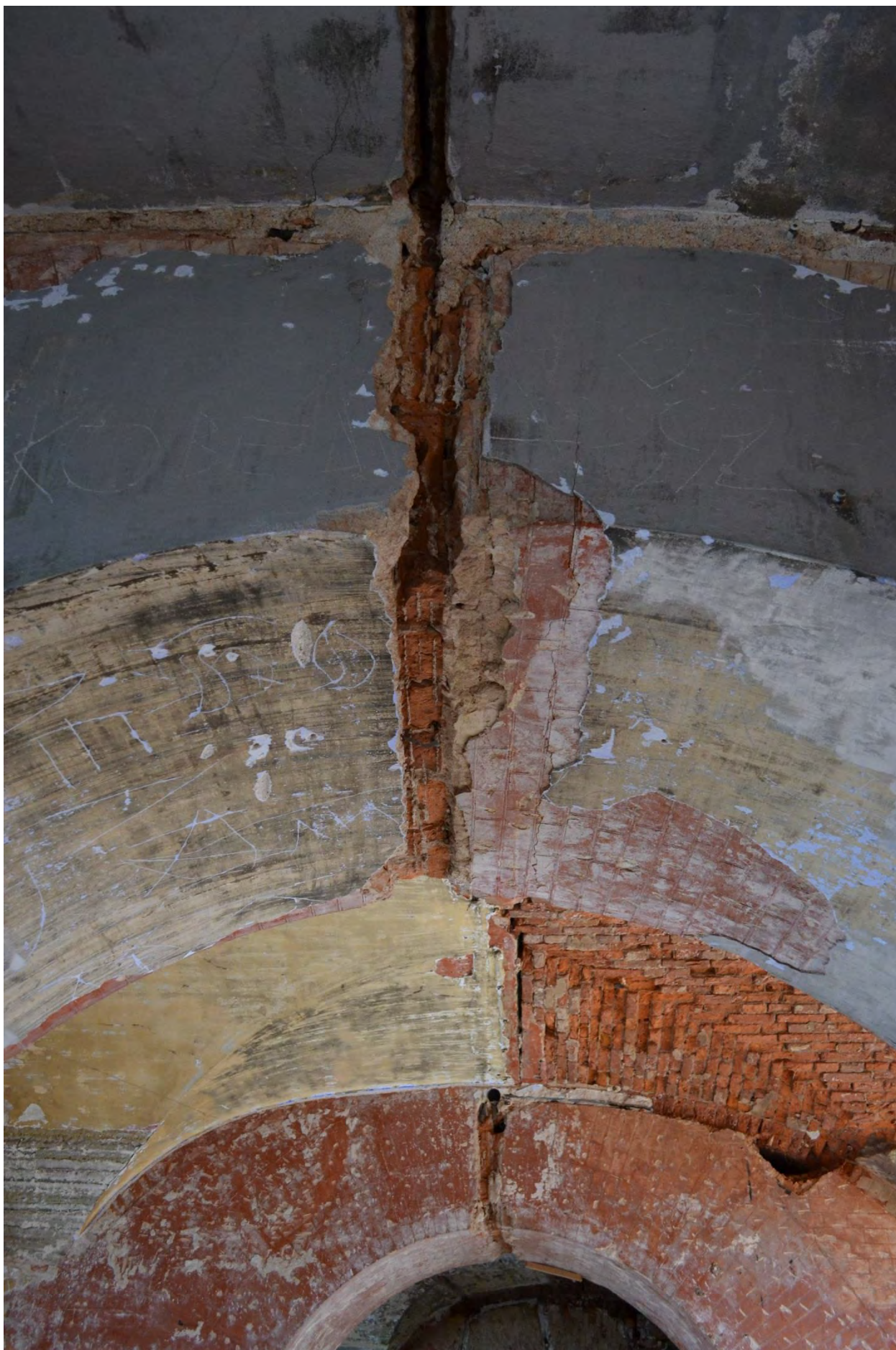
Фото 11. Второй этаж. Казематы. Вид на повреждение сводов.
