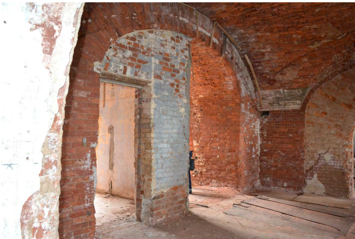
Фото 15. Второй этаж. Вид на частично заложенный проем на дворовом фасаде.
