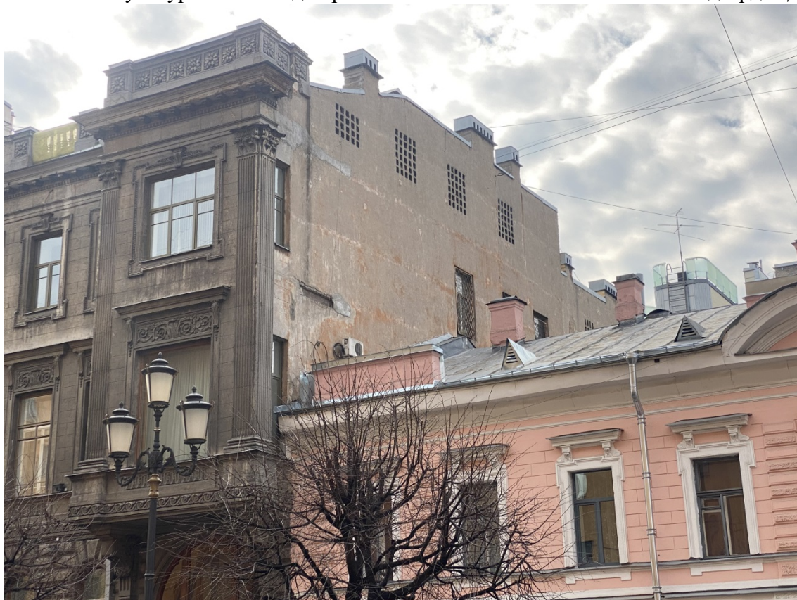
6. Вид на западный фасад (брандмауэрную стену) объекта культурного наследия регионального значения «Особняк Нейдгардта Д.В.»
