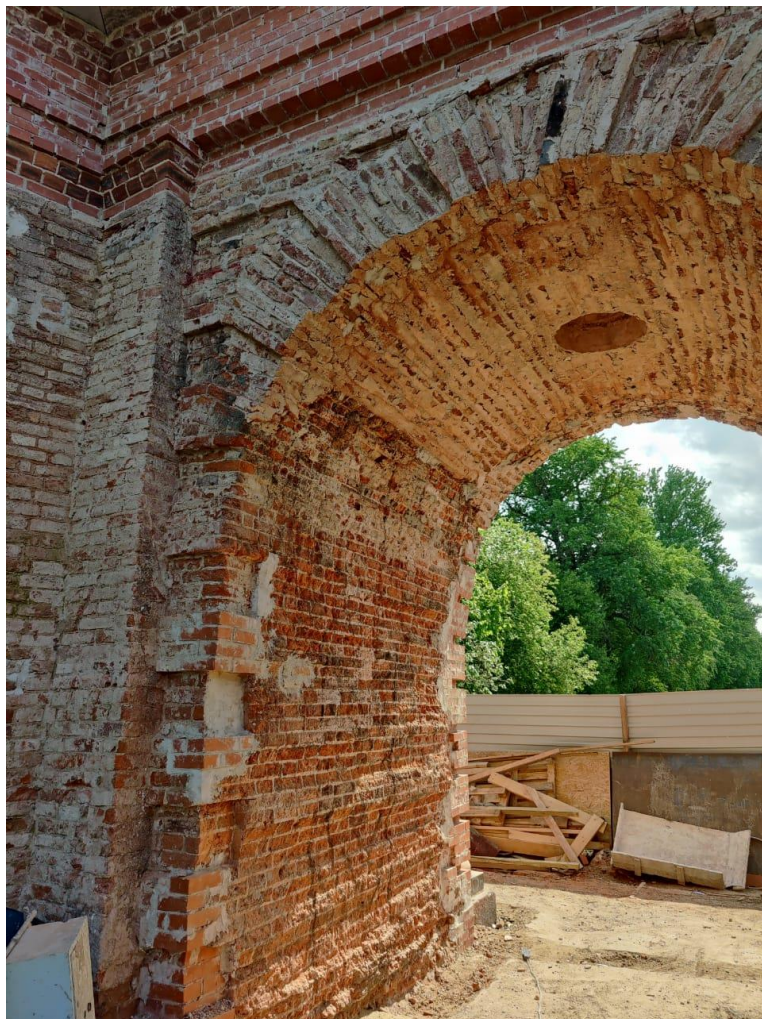
15. Объект культурного наследия регионального значения «Александровские ворота Охтинских пороховых заводов» по адресу: г. Санкт-Петербург, Химиков ул., д. 20 сооружение 1, Литера А Вид с северо-востока Дата съемки: 28 мая 2021 г.
