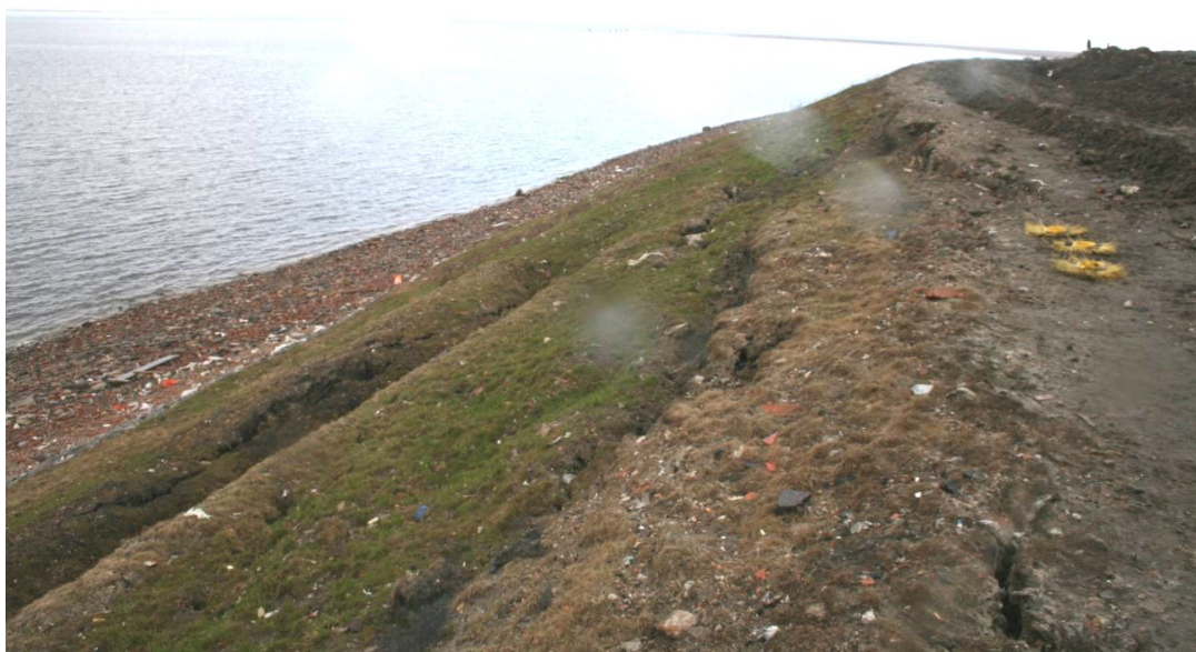
Рис. 4.1.56. Трещины в грунте насыпной дамбы. Весна 2010 г.
