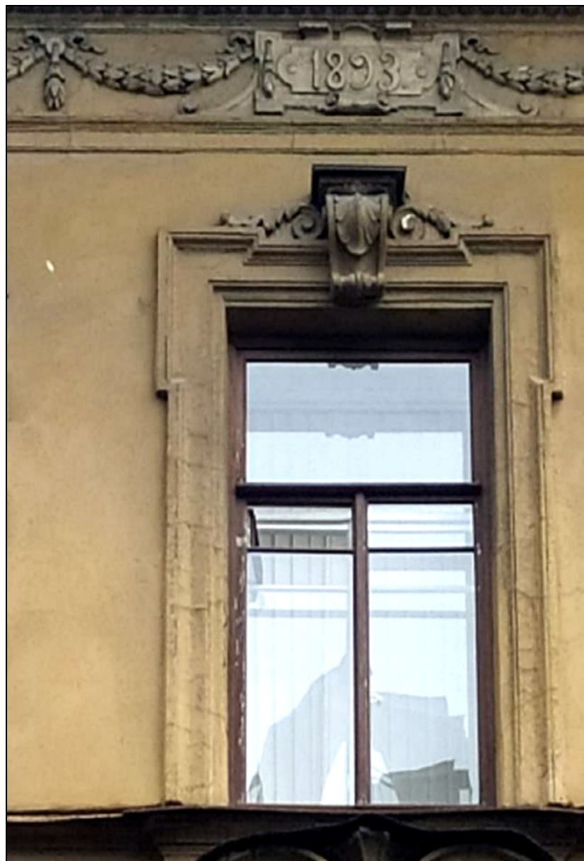
11. Оформление оконного проема третьего этажа в левом ризалите лицевого фасада по Виленскому переулку. Дата съемки: 19 октября 2020 г. Фотограф: В. П. Орлов.
