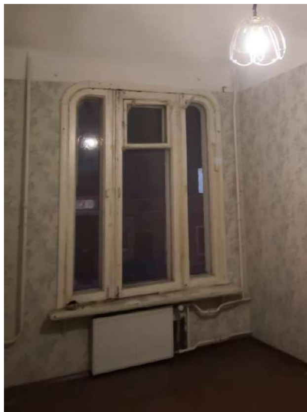
4. Выявленный объект культурного наследия «Дом Э.Э. Аригольда» (Санкт-Петербург, ул. Рылеева, д. 23, лит. А). Квартира 1 (помещение 8/15,0)
