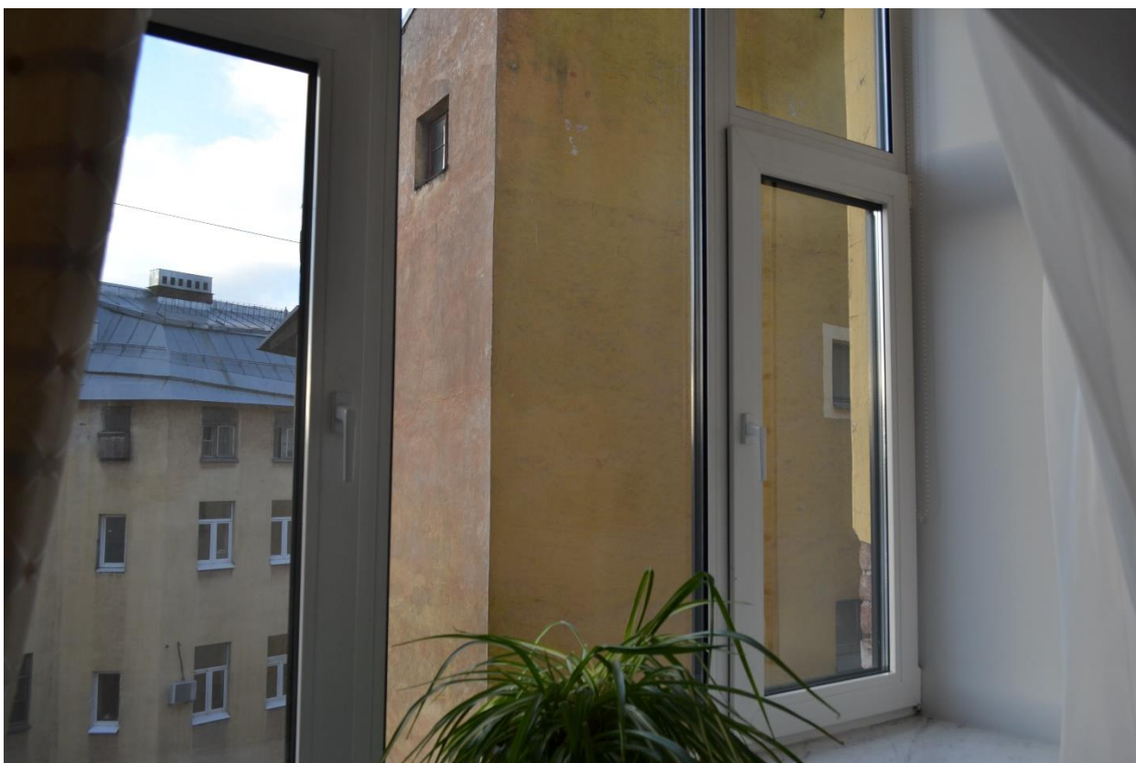
Фото 22. Помещения №3. Холл. (бывшее помещение №11, согласно техническому паспорту №3664/19 от 03.09.2019 г.) Вид на оконное заполнение.
