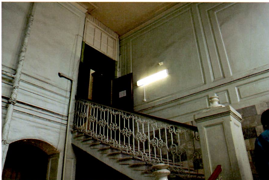
Фото №26. Литера А1. Пом. 35Н(V), Л-5.
