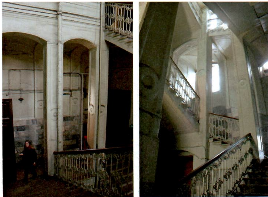
Фото №27, 28. Литера А1. Пом. 35Н(V), Л-5.
