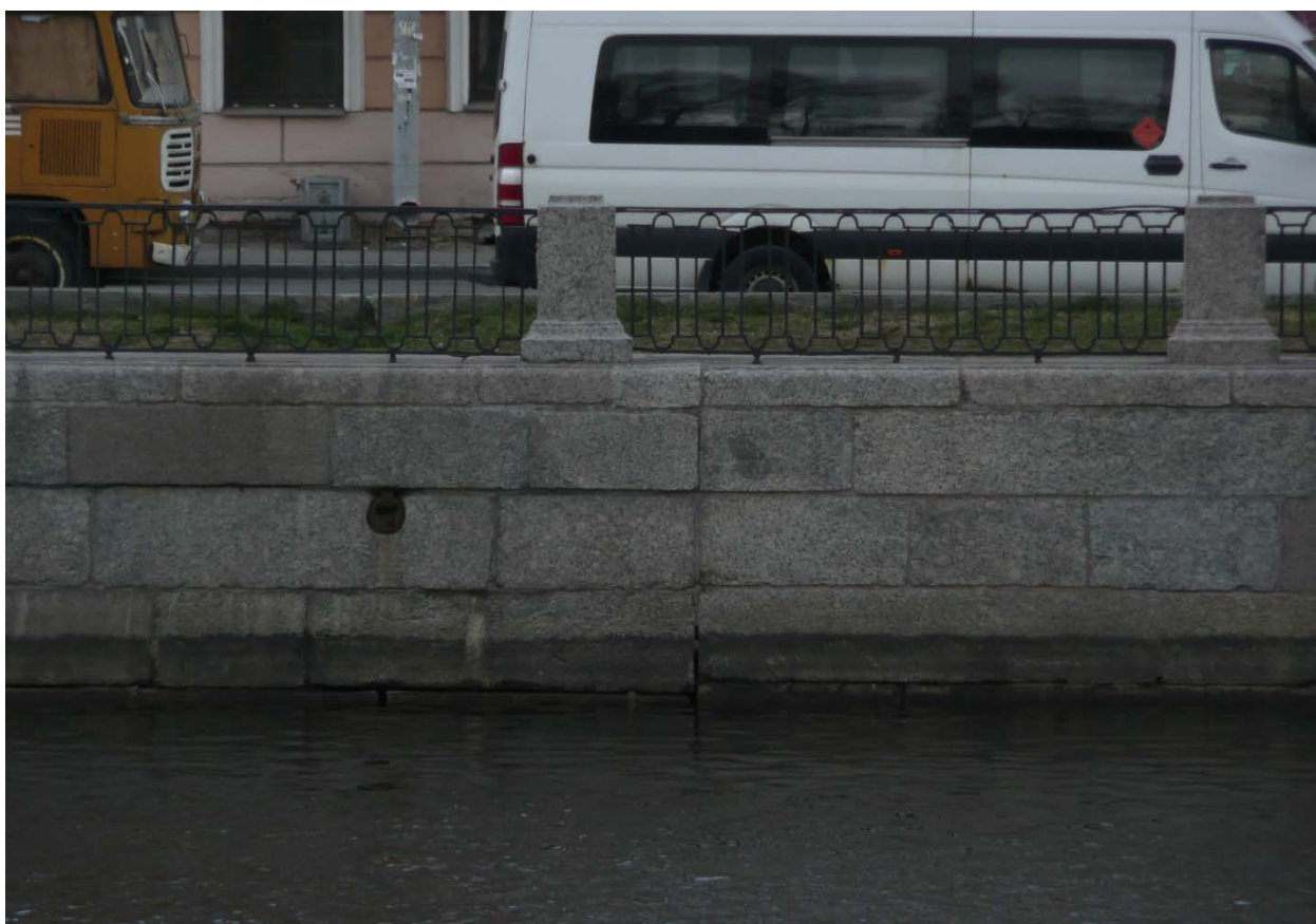
Фото 6. Деформационный шов стенки набережной.
