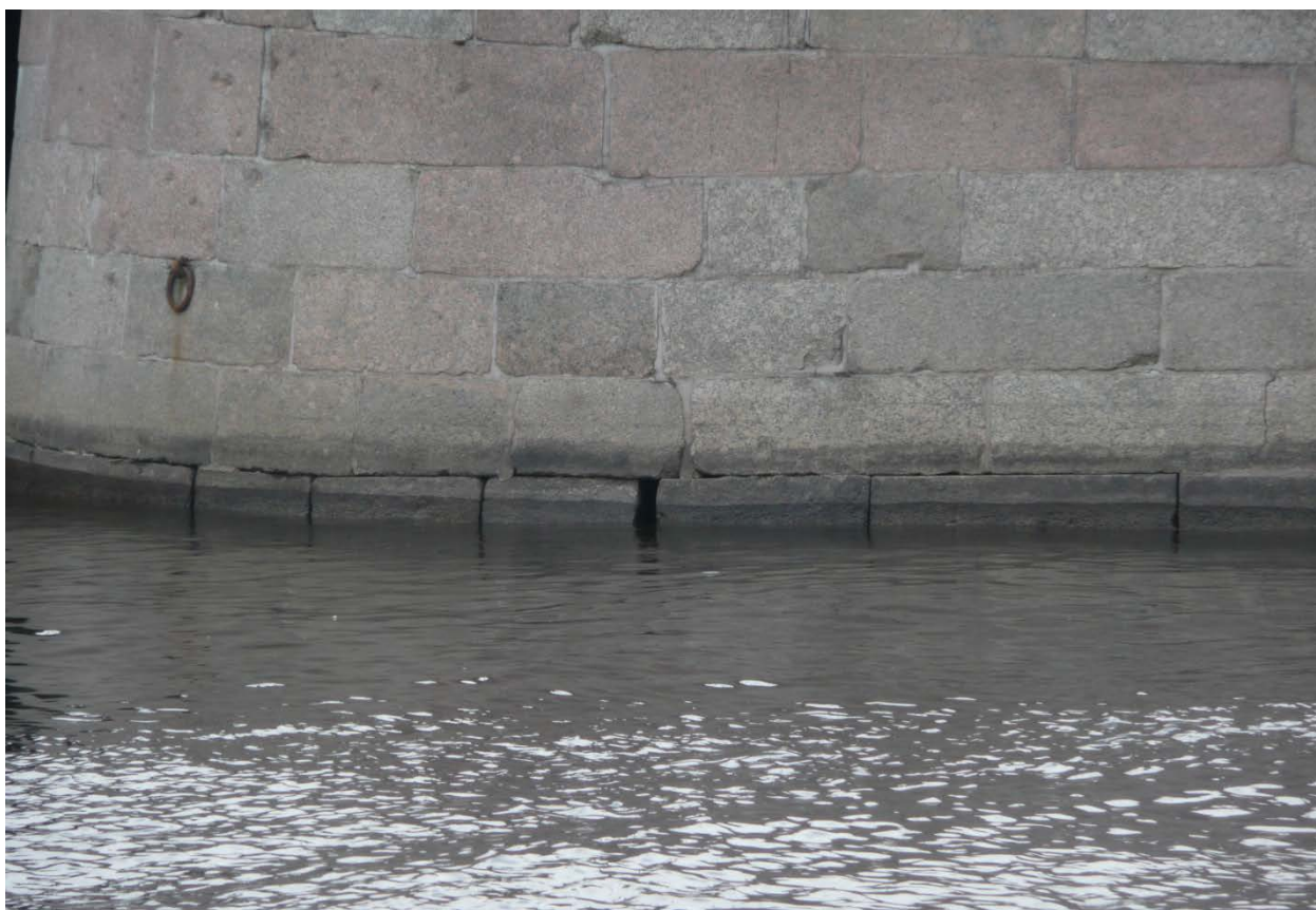
Фото 17-18. Участок набережной, примыкающий к Мало-Калинкину мосту. Фрагмент стенки в уровне поверхности воды.
