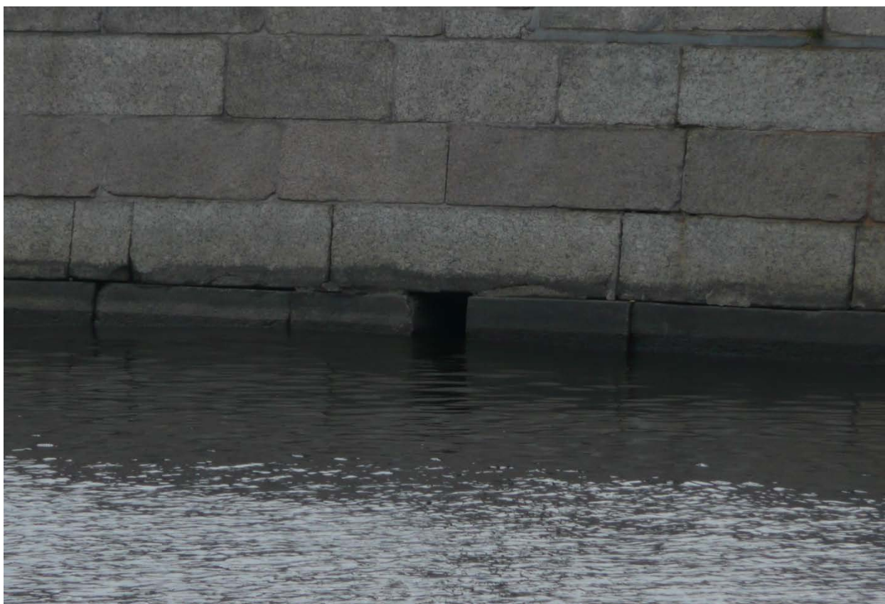
Фото 15-16. Участок набережной в створе Садовой улицы. Фрагмент стенки в уровне поверхности воды.
