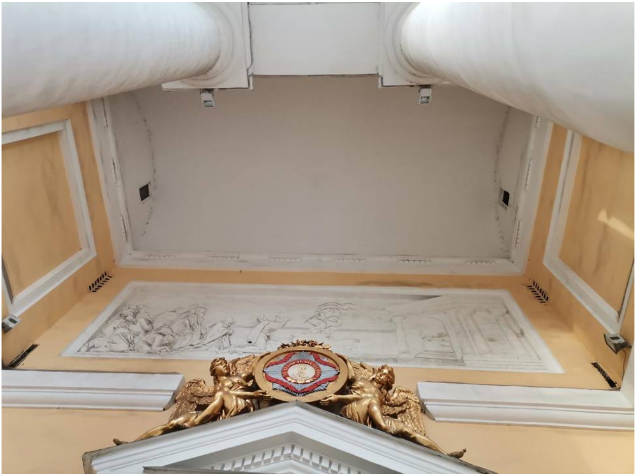
Фото 43. ОКН федерального значения «Собор Троицкий с двумя соединительными корпусами». Западный фасад. Фрагмент. Съёмка 28.04.2021 г.
