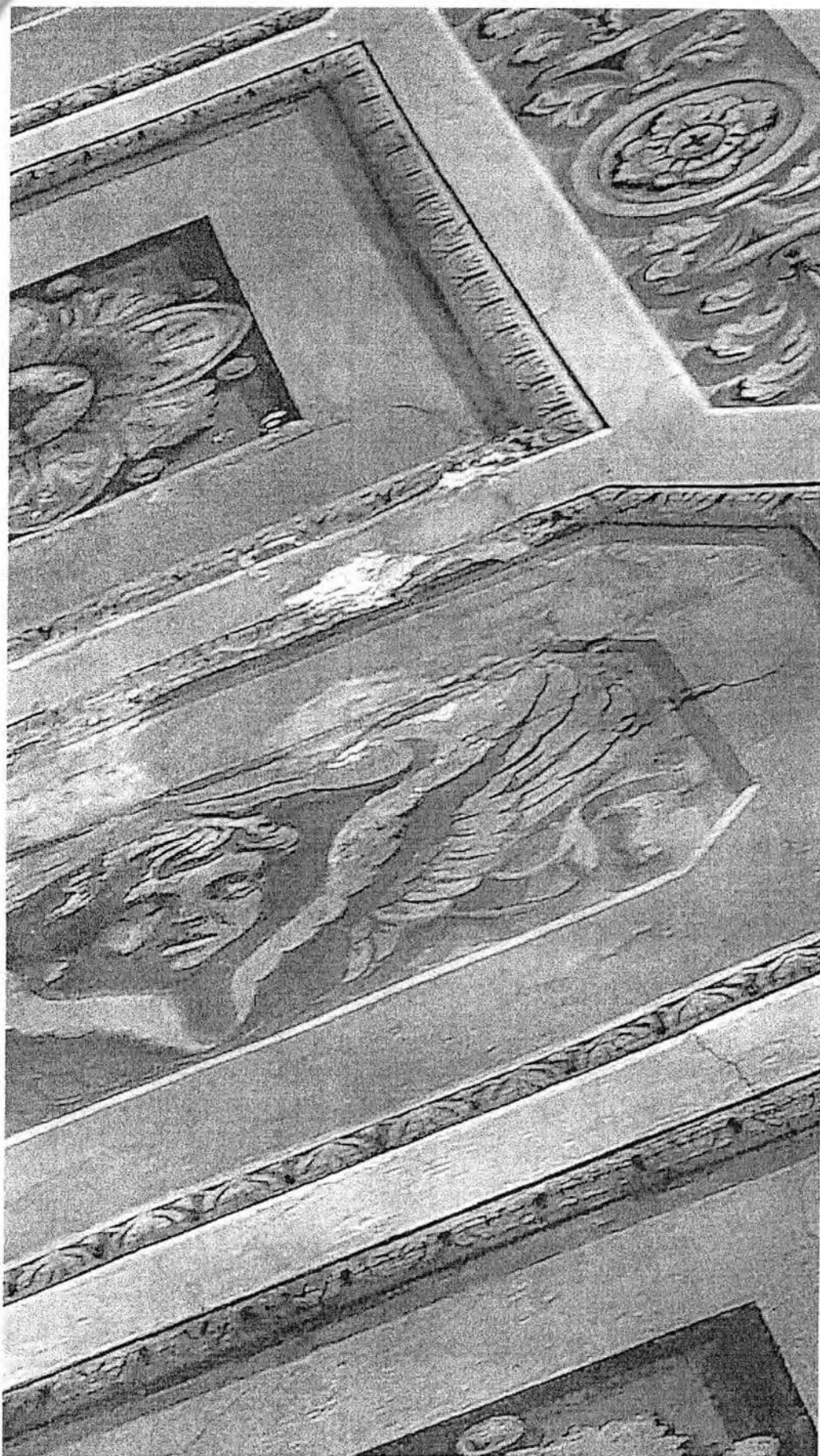
Фото 5. Емчуга, следы протечек
