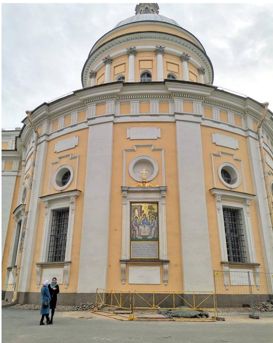
Фото 20. ОКН федерального значения «Собор Троицкий с двумя соединительными корпусами». Восточный фасад. Фрагмент. Съёмка 28.04.2021 г.
