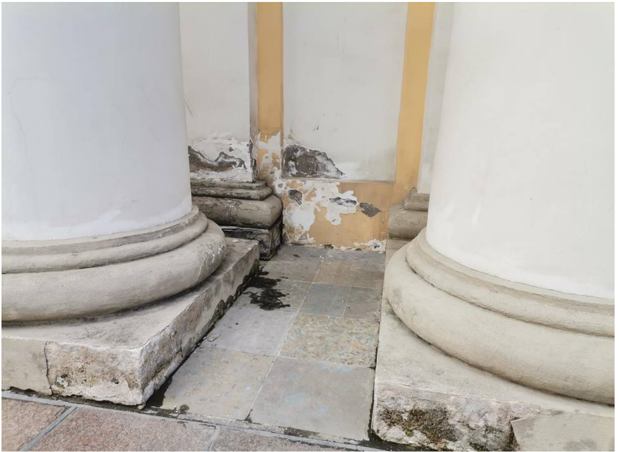
Фото 41. ОКН федерального значения «Собор Троицкий с двумя соединительными корпусами». Западный фасад. Фрагмент. Съёмка 28.04.2021 г.
