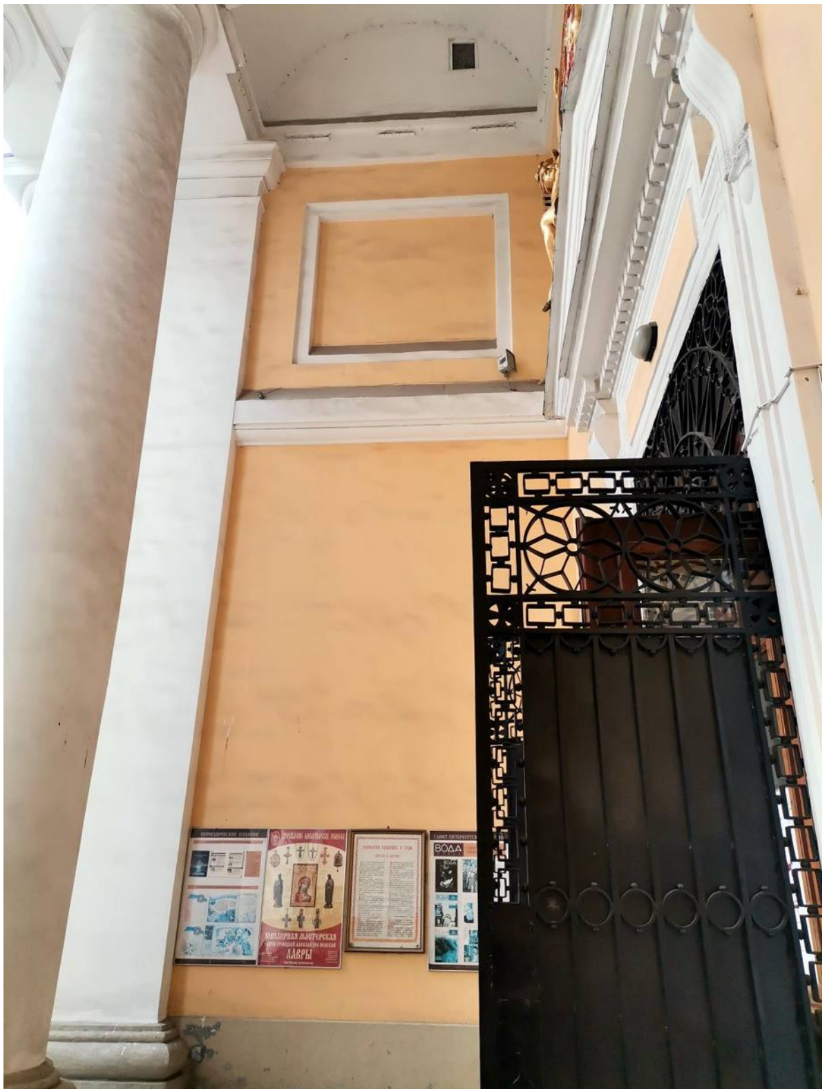
Фото 47. ОКН федерального значения «Собор Троицкий с двумя соединительными корпусами». Западный фасад. Фрагмент. Съёмка 28.04.2021 г.
