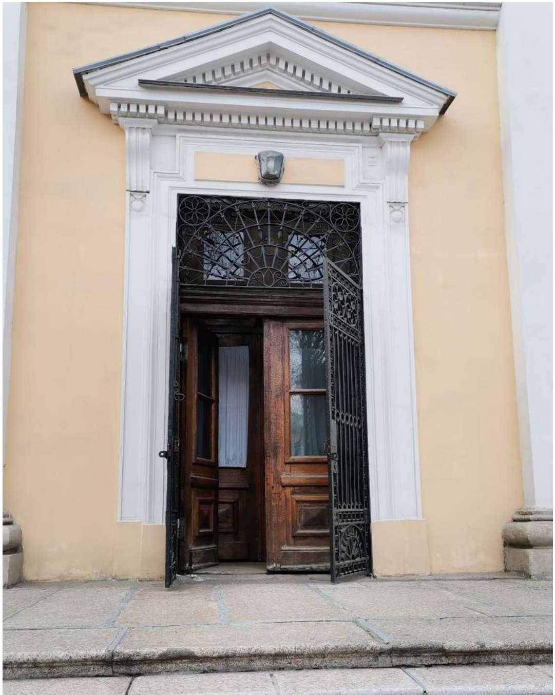
Фото 16. ОКН федерального значения «Собор Троицкий с двумя соединительными корпусами». Южный фасад. Фрагмент. Оформление дверного проёма. Съёмка 28.04.2021 г.
