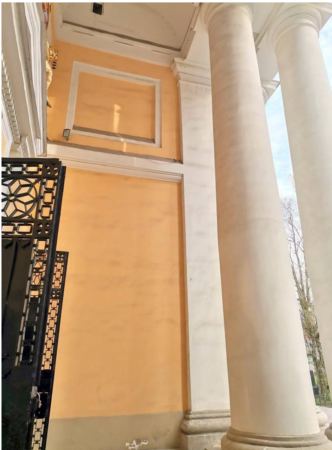
Фото 46. ОКН федерального значения «Собор Троицкий с двумя соединительными корпусами». Западный фасад. Фрагмент. Съёмка 28.04.2021 г.
