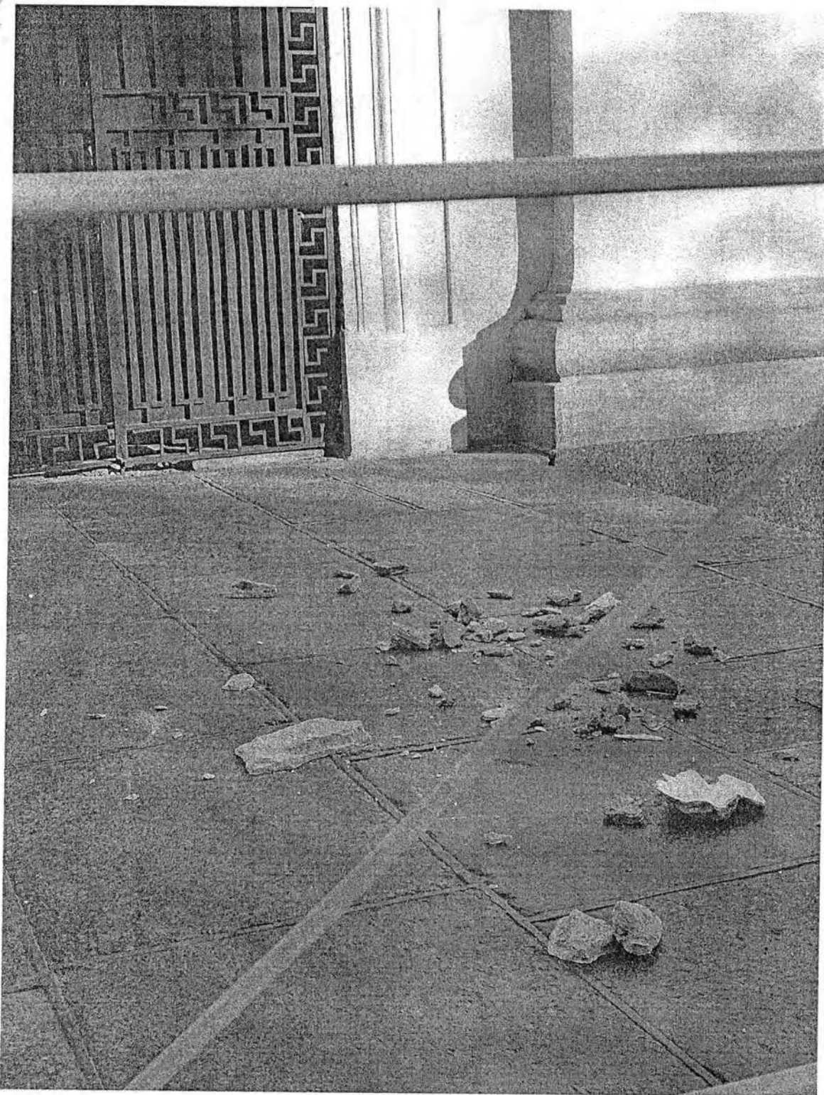
Фото 9. Фрагменты обрушения на площадке
