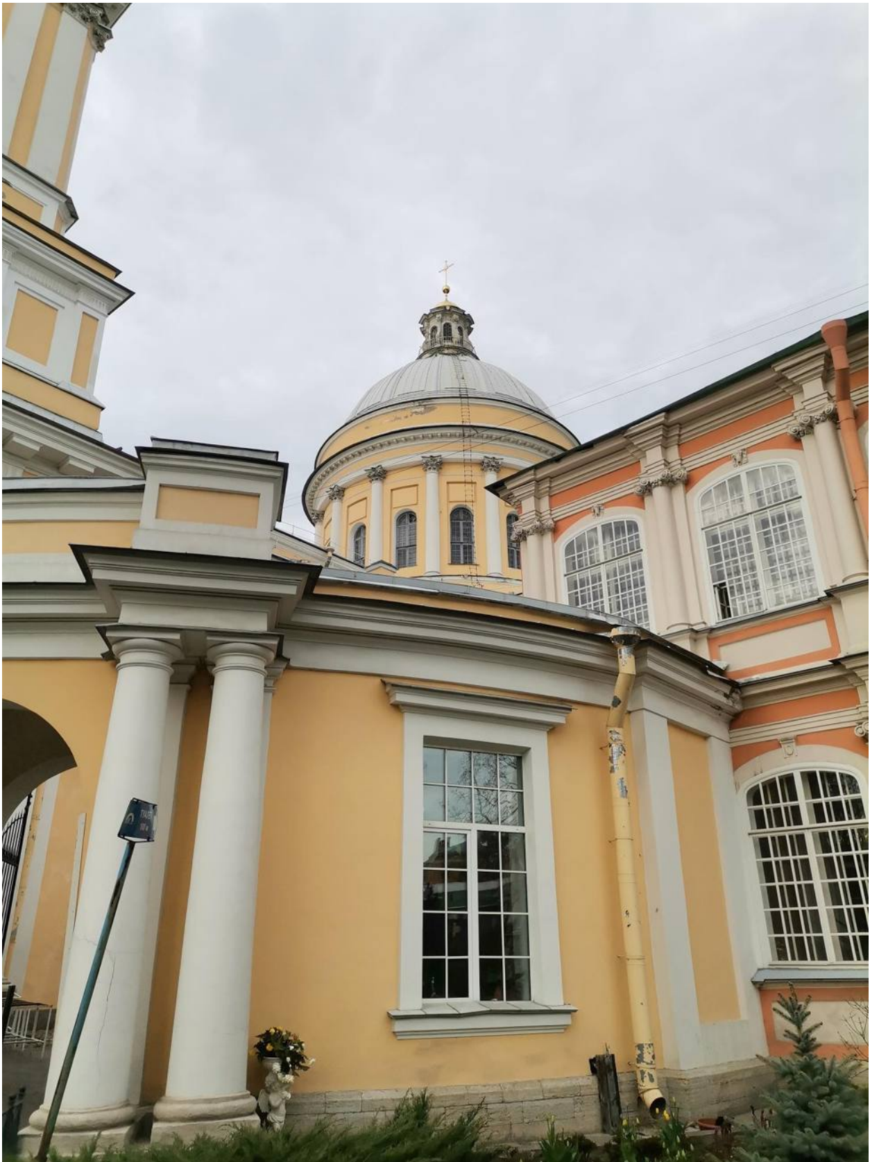
Фото 03. ОКН федерального значения «Собор Троицкий с двумя соединительными корпусами». Южный соединительный корпус. Фрагмент. Съёмка 28.04.2021 г.
