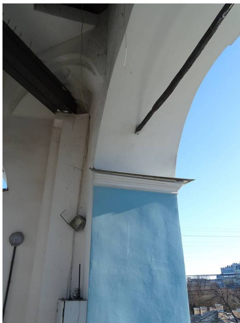
Илл. 25. Затяжки в арочных сводах Колокольни. Съемка 05.02.21 г. Трушковский В.Э.
