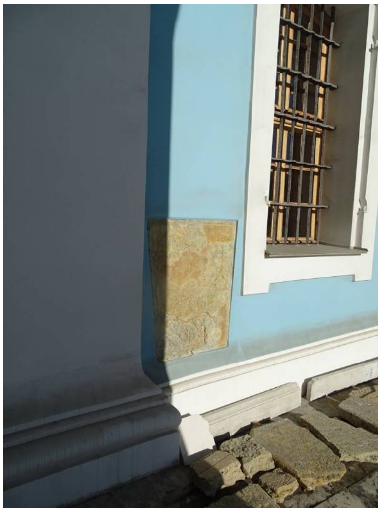
Илл. 18. Фрагмент южного фасада Собора. Надгробная плита Съемка 05.02.21 г. Трушковский В.Э.
