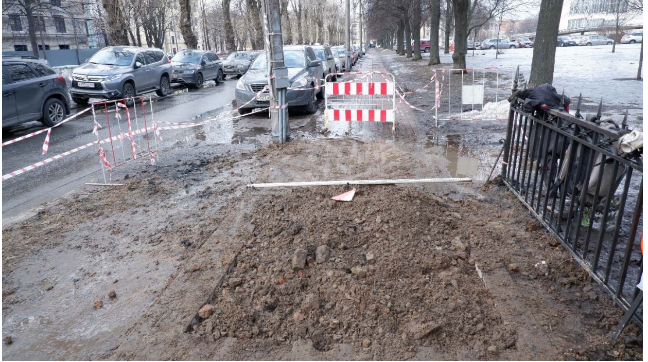
Рис.110. Санкт-Петербург, Адмиралтейский район, Сквер у Театра юных зрителей. Шурф 4. Рекультивация
