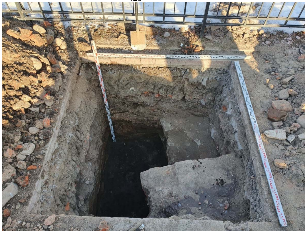
Рис.72. Санкт-Петербург, Адмиралтейский район, Сквер у Театра юных зрителей. Шурф 2. Промежуточная фиксация 1. Вид на север.
