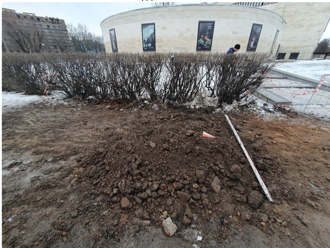
Рис.65. Санкт-Петербург, Адмиралтейский район, Сквер у Театра юных зрителей. Шурф 1. Рекультивация
