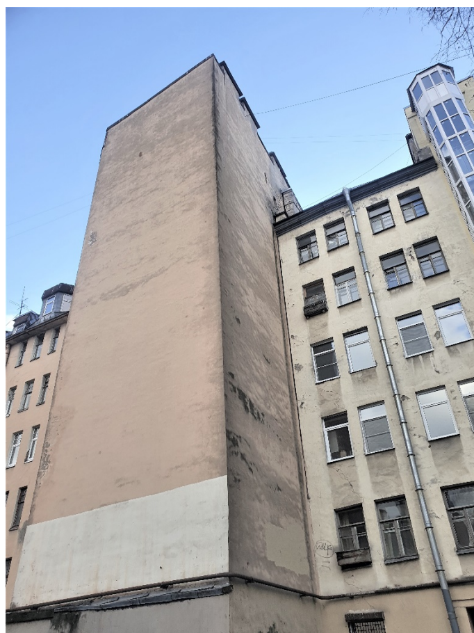
7. Выявленный объект культурного наследия «Дом А.В. Барсовой», по адресу: г. Санкт-Петербург, Заячий пер., д. 6/18, лит. А (Дегтярный пер., 18; Заячий пер., 6). Фрагмент дворового фасада. Дата съемки: 01.03.2022г.
