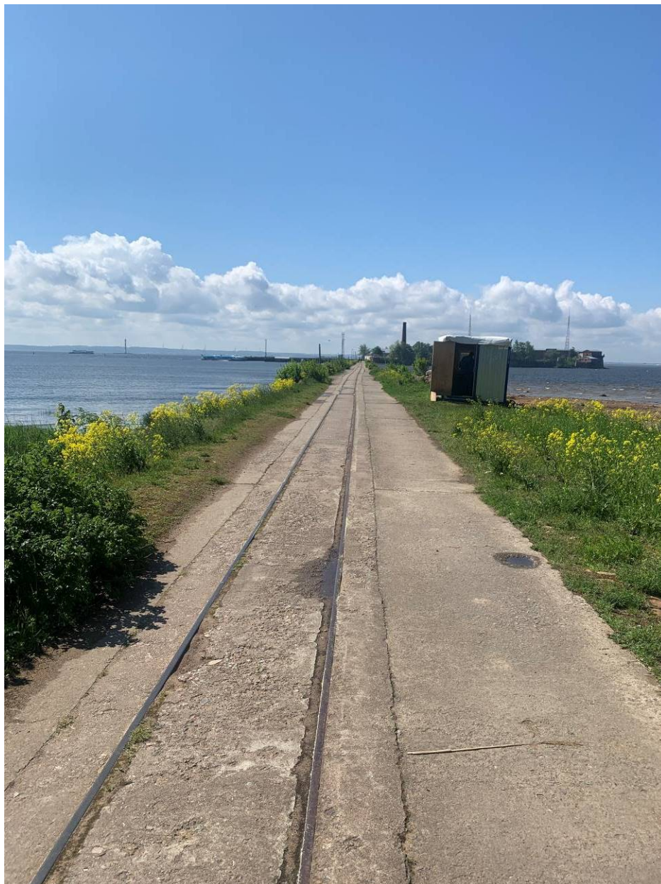
Илл. 04. Объект культурного наследия федерального значения «Форт «Петр I». Северная часть. Дамба. Съемка 09.06.2022 г. Трушковский В.Э.
