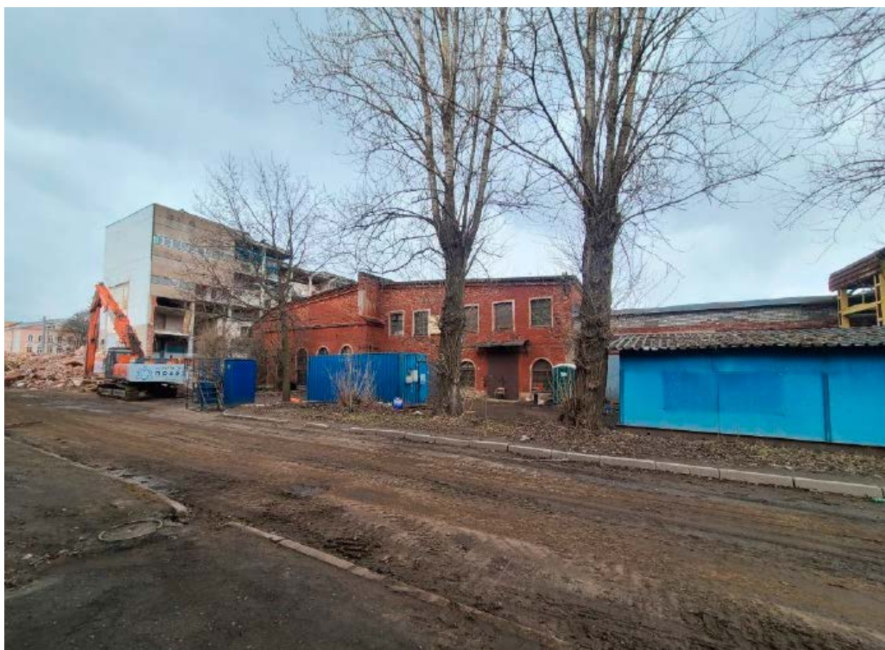
6. Вид от объекта культурного наследия регионального значения «Прокатная и сталелитейная мастерская «Невского железоделательного, механического и корабельного завода» («Невского железопрокатного завода» П.Ф. Семянникова и В.А. Полетики)», расположенного по адресу: г. Санкт-Петербург, проспект Обуховской Обороны, дом 38, лит. В, на зону производства работ. 10.05.2022
