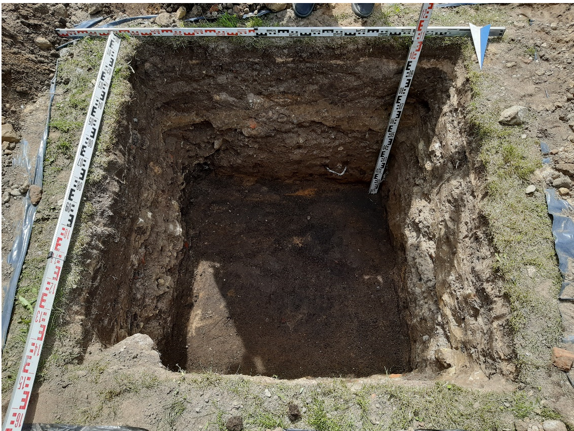
Рис. 30. Санкт-Петербург, «Выполнение проектно-изыскательских работ по реконструкции водопроводной магистрали по адресу: Санкт-Петербург, пр. Непокоренных, д. 49 (от ул. Бутлерова д.4 до Гражданского пр.)». Шурф 1. Фотофиксация по слою погребенной почвы. Вид на юг.
